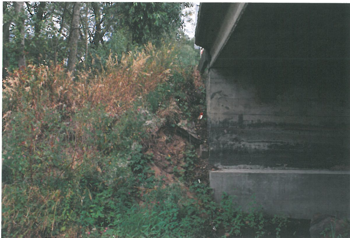
Fot. 5. Wegetacja roślin, zanieczyszczenia oraz ubytki gruntu stożka spowodowane brakiem systematycznych prac utrzymaniowych - stożek od strony północnej i dolnej wody.
