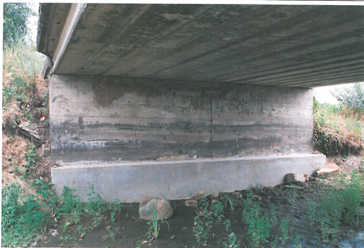
Fot. 14. Zanieczyszczenia betonu przyczółka północnego.
