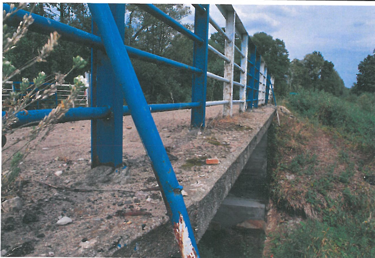
Fot. 11. Zanieczyszczenia gzymsu – widok od strony górnej wody.
