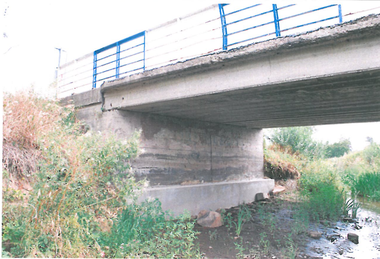
Fot. 15. Zanieczyszczenie przestrzeni podmostowej.
