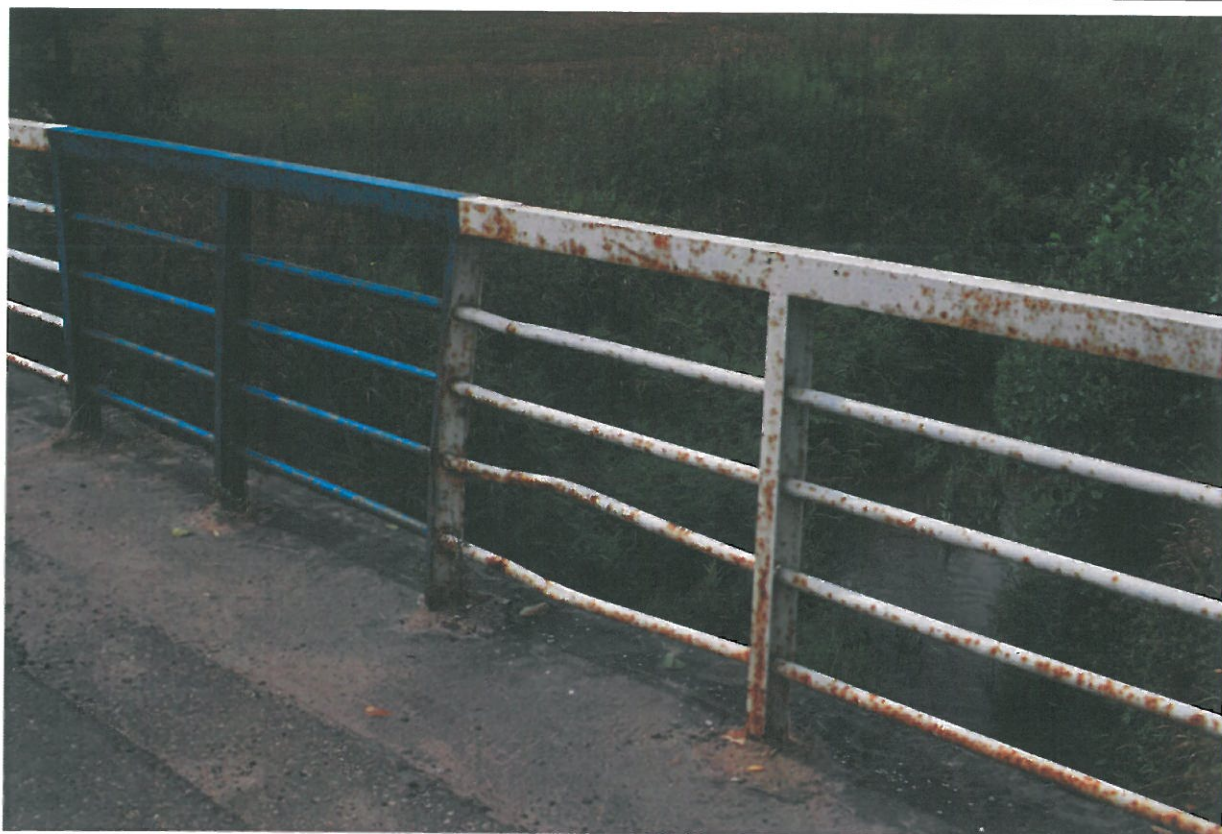
Fot. 9. Zniszczenie zabezpieczeń antykorozyjnych oraz korozja balustrady.
