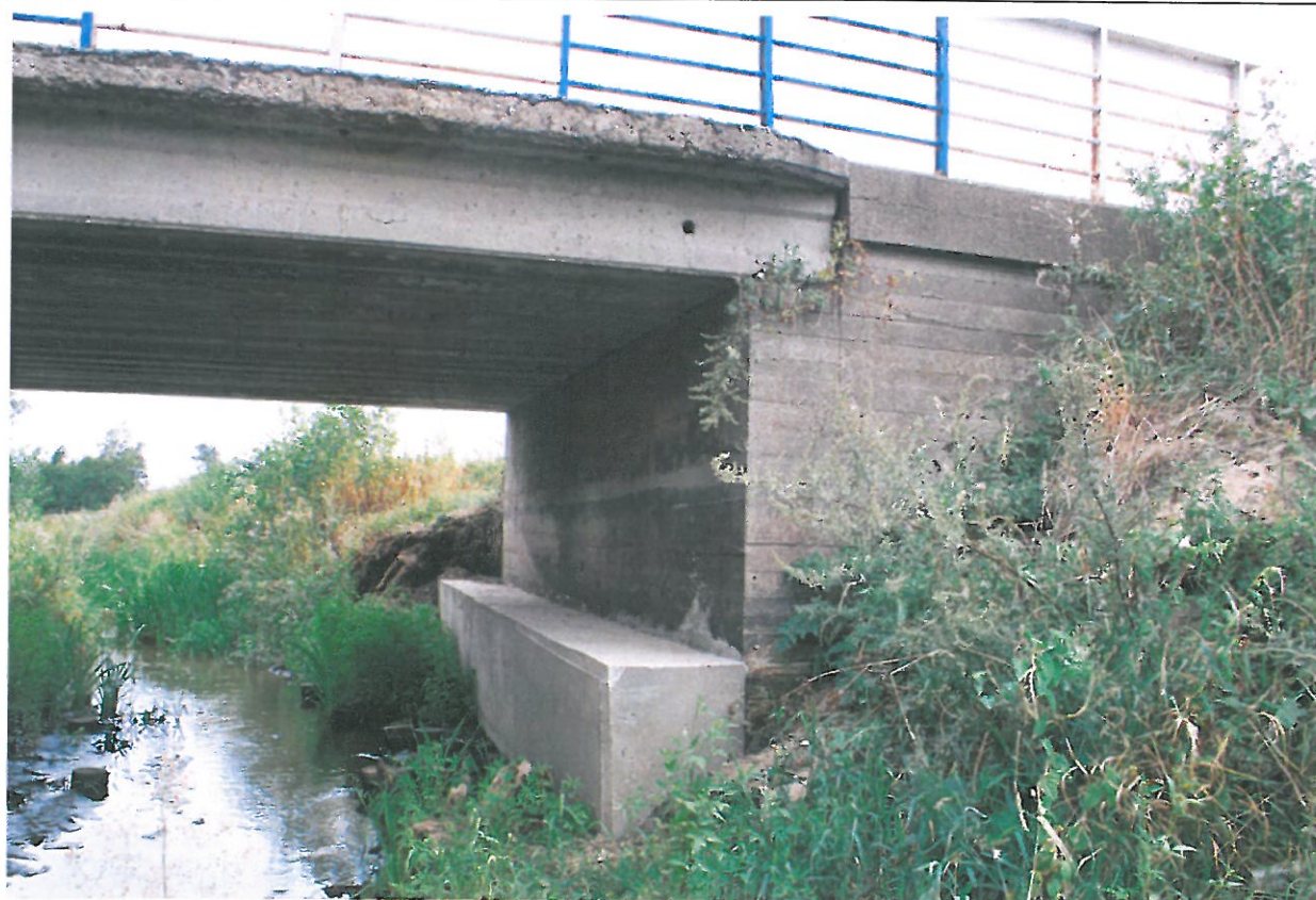
Fot. 16. Zanieczyszczenie przestrzeni podmostowej
