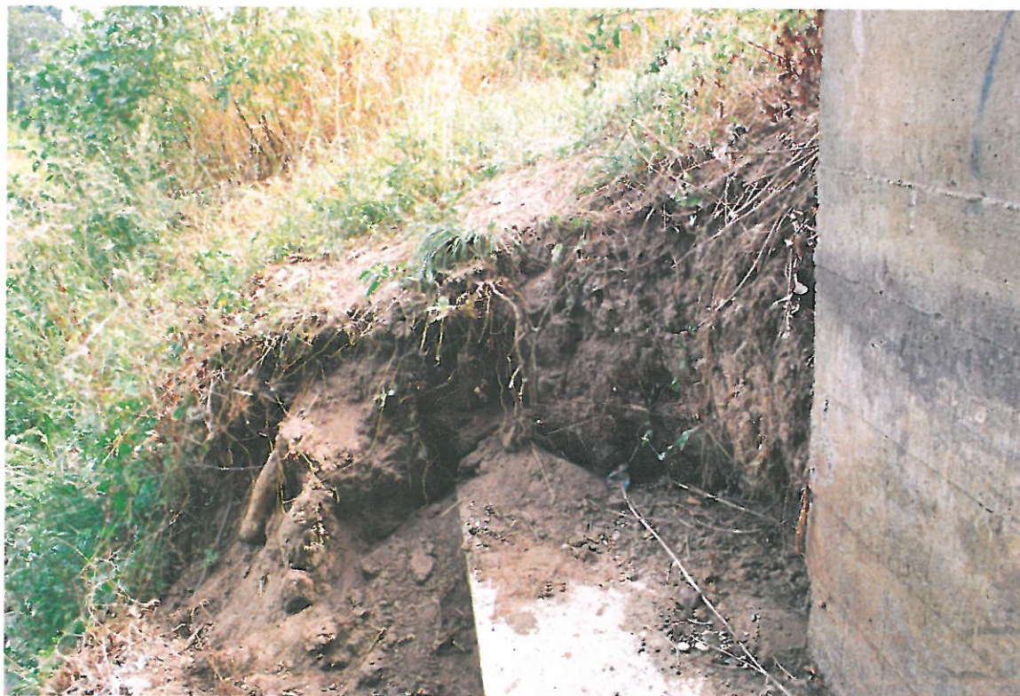
Fot. 6. Wegetacja roślin, ubytki gruntu, nieprawidłowo ukształtowany stożek - widok od strony południowej i górnej wody.
