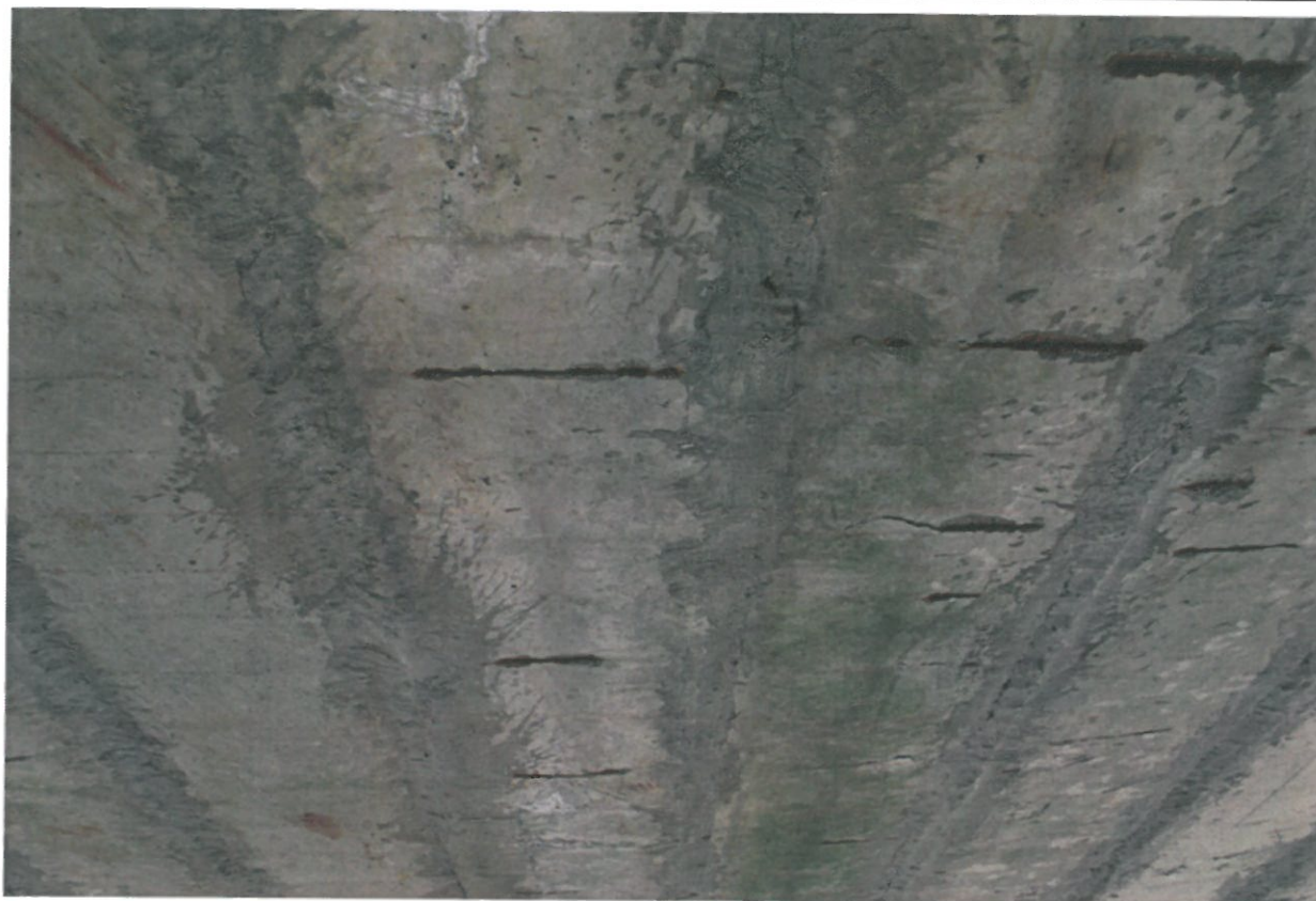
Fot. 13. Ubytki betonu oraz korozja zbrojenia belek prefabrykowanych typu GROMNIK.
