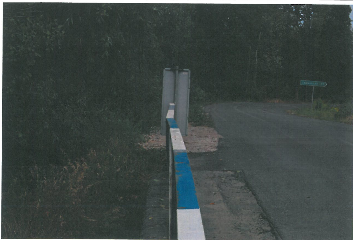
Fot. 10. Deformacja balustrady.
