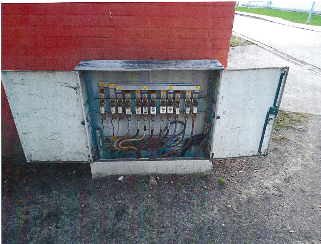
Złącze kablowe – budynek 15 ( przewidywana wymiana na nowe ZK-5A)
