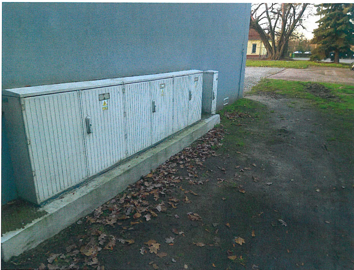
Złącze kablowe – budynek 14
