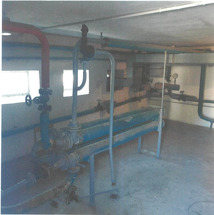
Fot. nr 5 – węzeł cieplny
