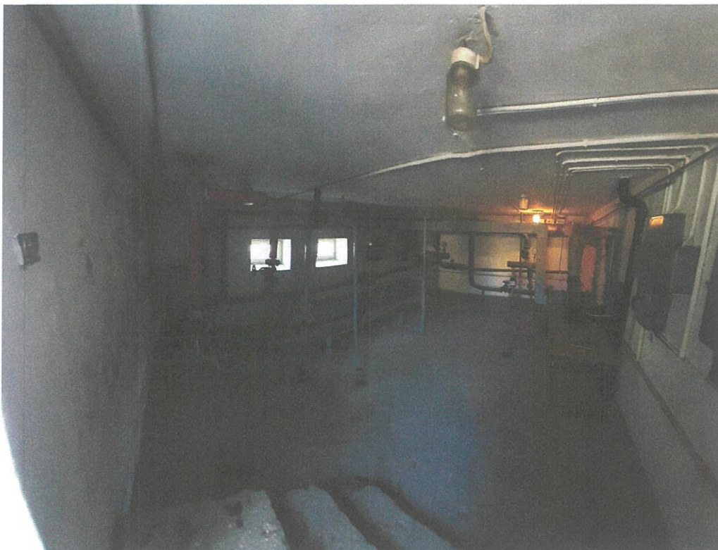
Fot. nr 3 – węzeł cieplny
