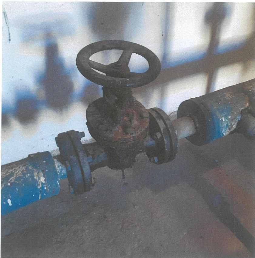
Fot. nr 6 – węzeł cieplny
