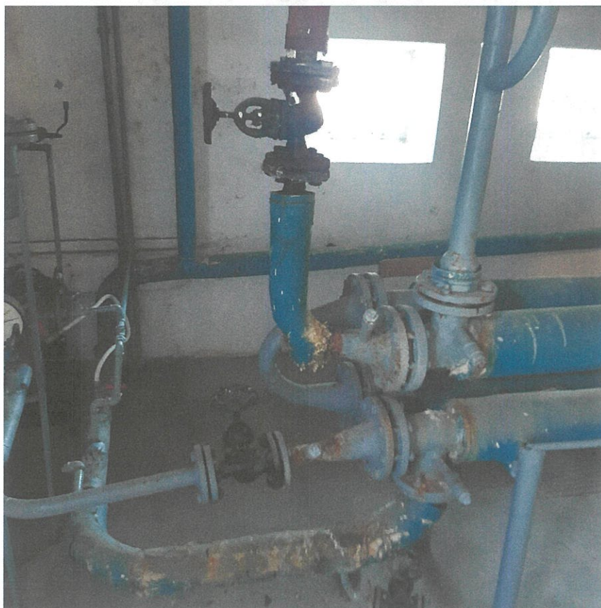
Fot. nr 4 – węzeł cieplny
