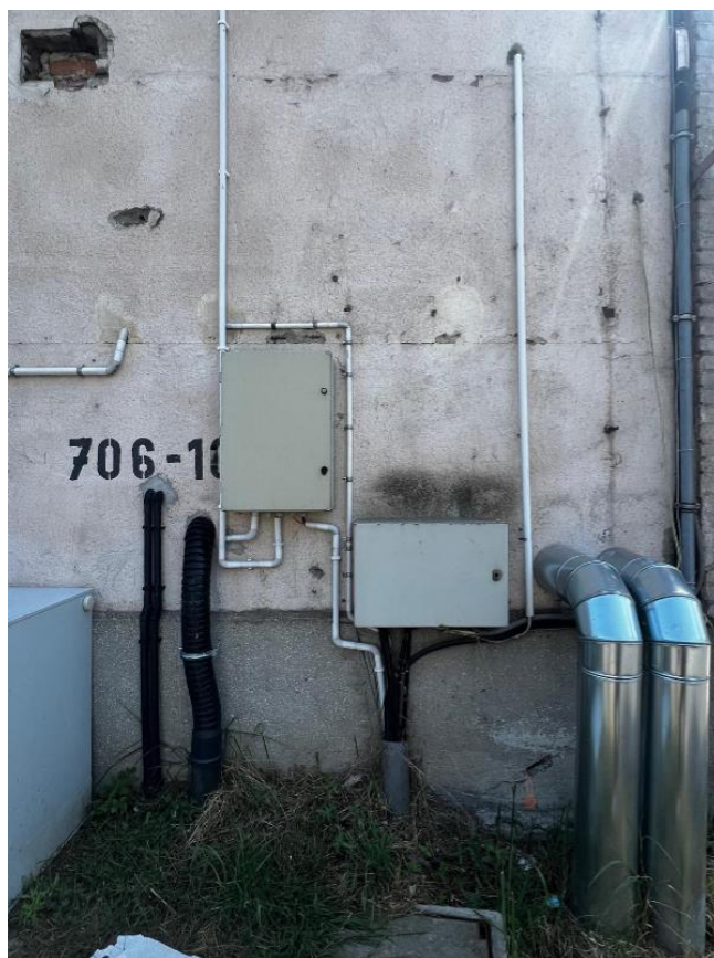
Zdj. Skrzynki elektryczne na elewacji zachodniej.
