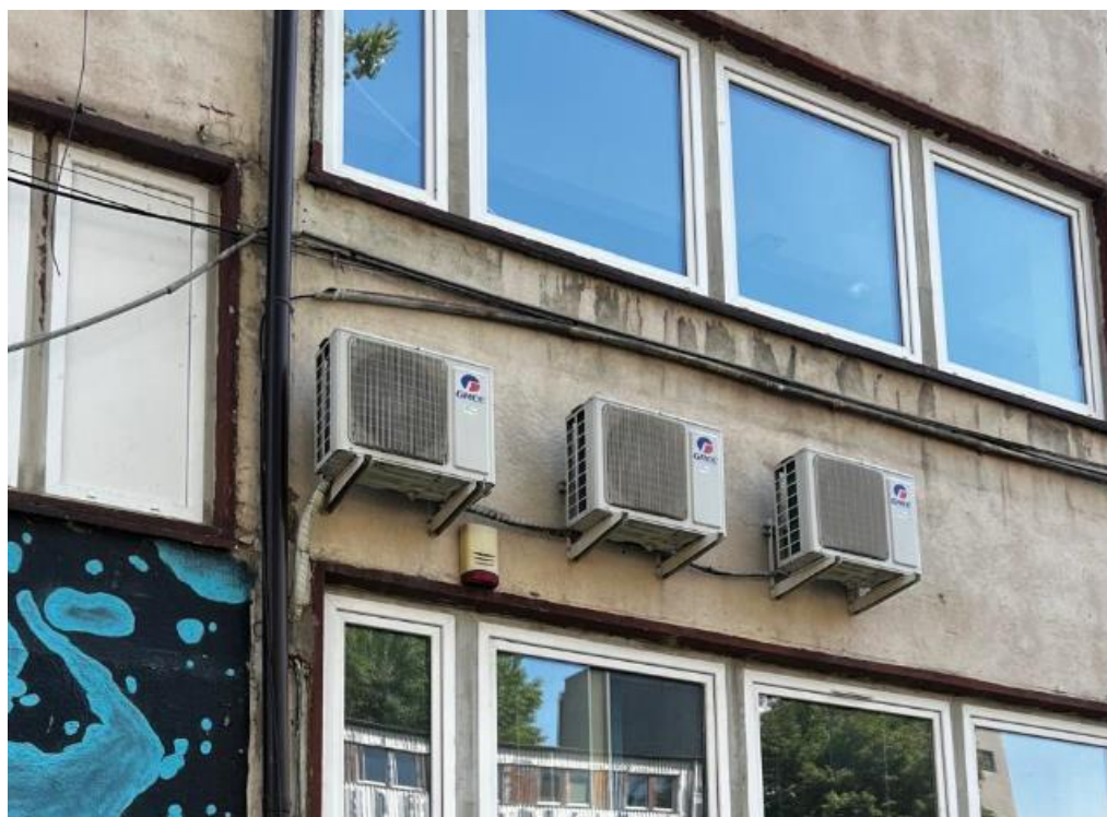
Zdj. Nr. 2 Jednostki zewnętrzne klimatyzacji należące do najemców.
