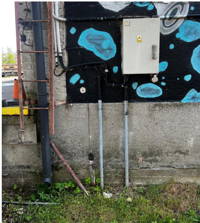
Zdj. Skrzynka elektryczna najemcy na elewacji zachodniej.
