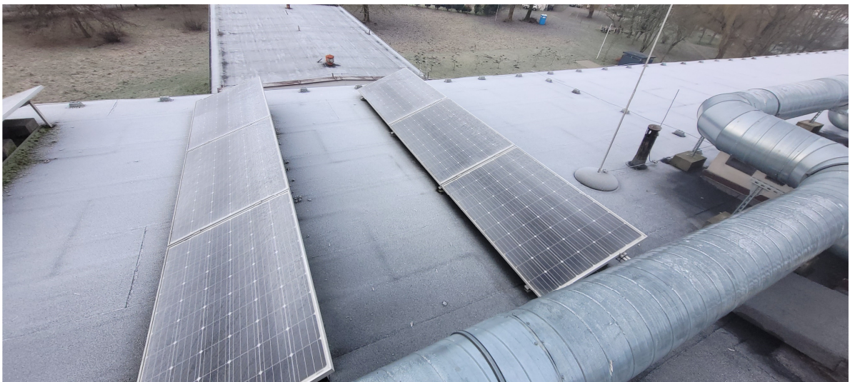
Istniejąca instalacja PV na konstrukcji balastowej.
