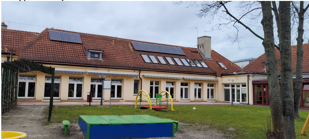
Istniejąca instalacja PV
