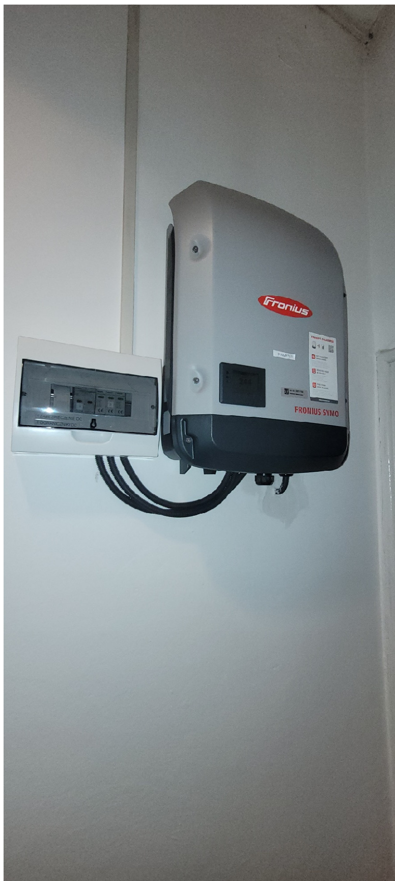
Inwertel istniejącej instalacji PV 4,05kWp
