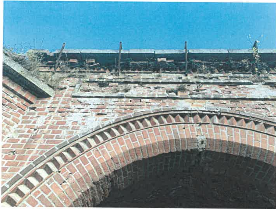
Fot 15. Uszkodzenia elementów ceramicznych
