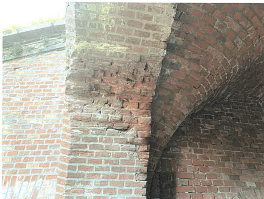
Fot 18. Uszkodzenia elementów ceramicznych
