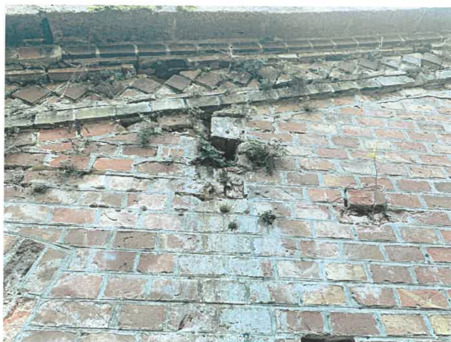
Fot 12. Uszkodzenia elementów ceramicznych
