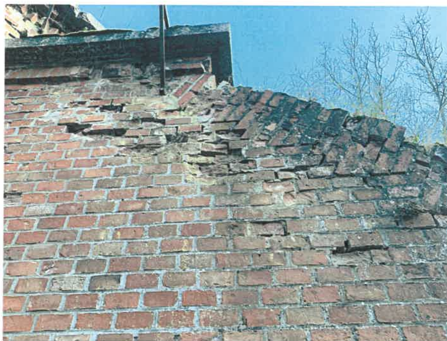
Fot 17. Uszkodzenia elementów ceramicznych
