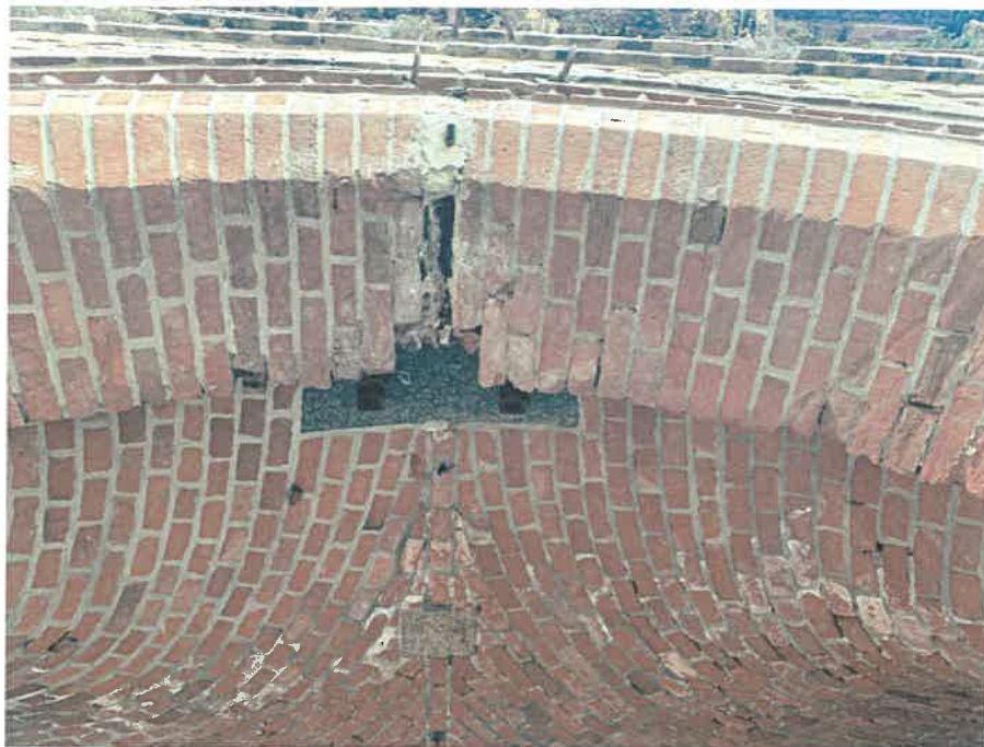
Fot 19. Uszkodzenia elementów ceramicznych
