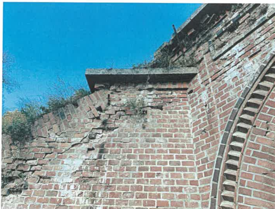
Fot 11. Uszkodzenia elementów ceramicznych
