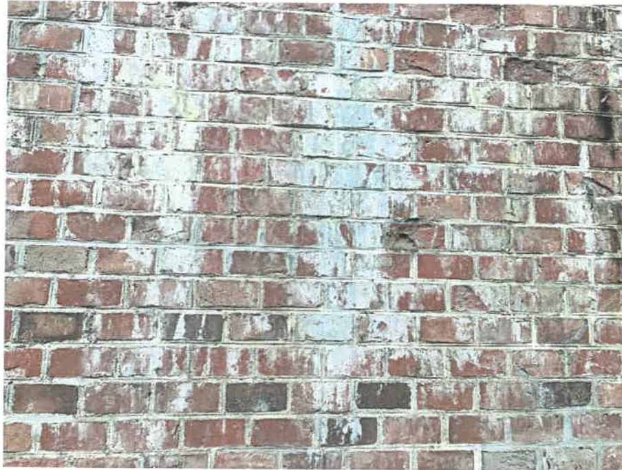
Fot 9. Wykwity szkodliwych soli budowlanych
