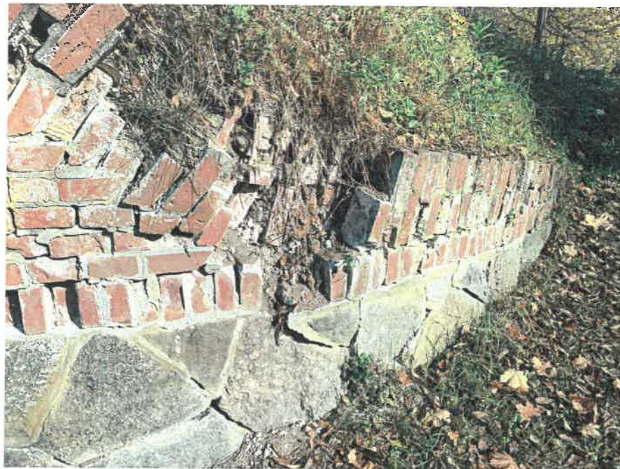
Fot 13. Uszkodzenia elementów ceramicznych
