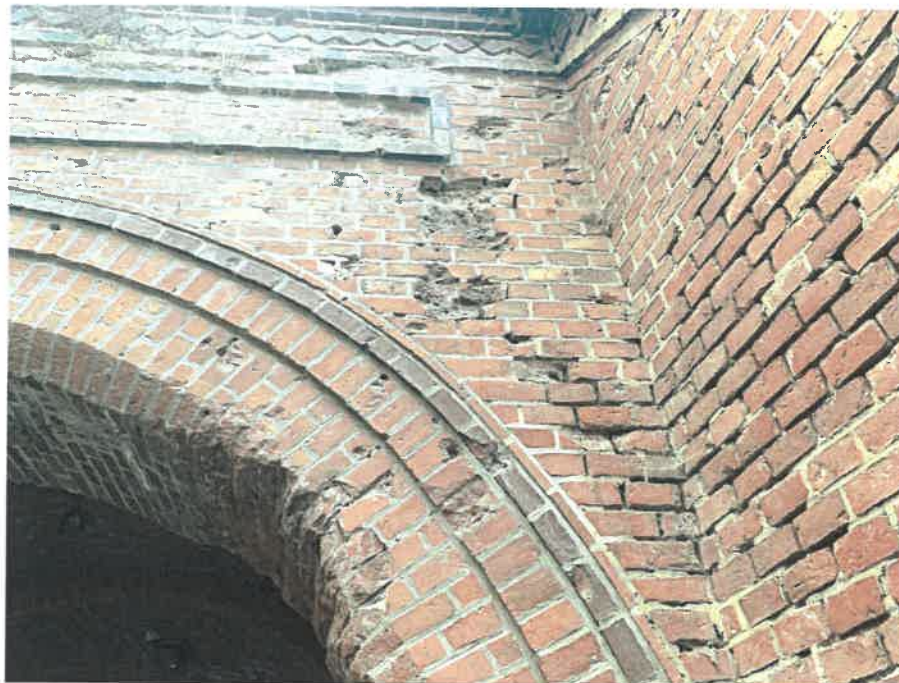
Fot 21. Degradacja elementów ceramicznych i spoinowania
