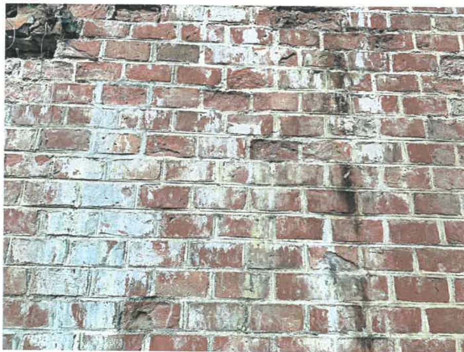
Fot 8. Wykwity szkodliwych soli budowlanych
