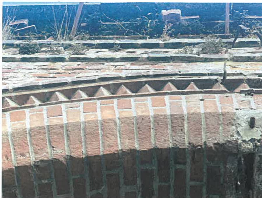
Fot 20. Luźne elementy ceramiczne stwarzające zagrożenie dla osób postronnych
