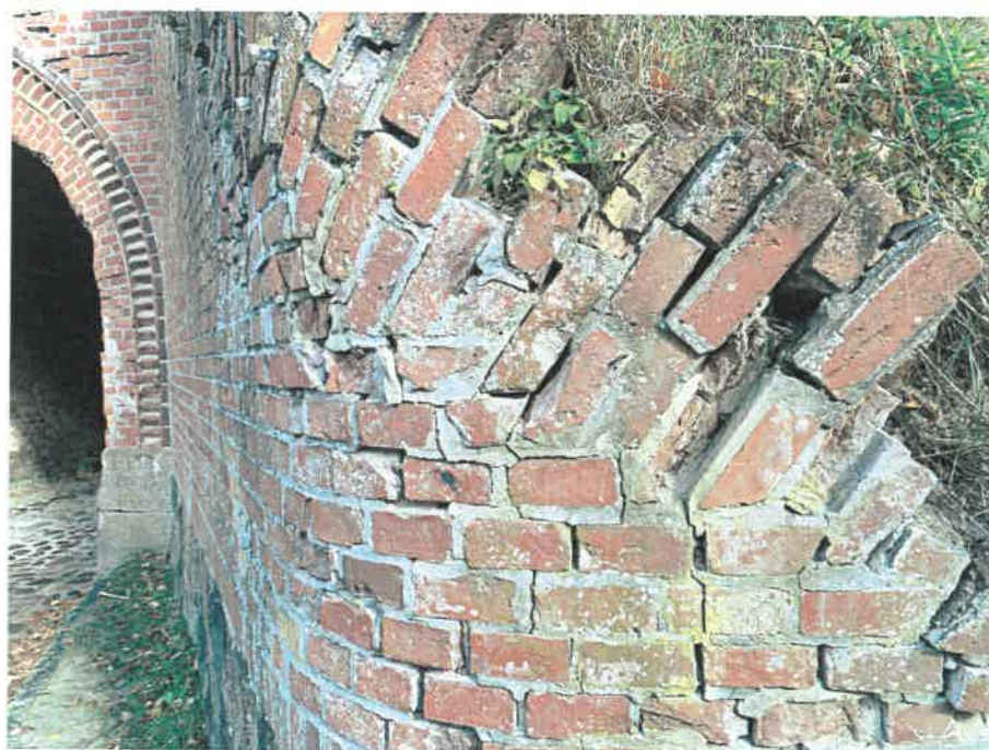
Fot 14. Uszkodzenia elementów ceramicznych
