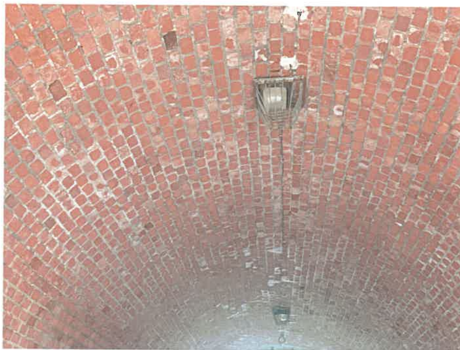
Fot 10. Wykwity szkodliwych soli budowlanych
