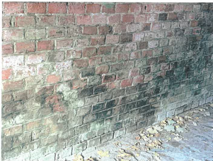
Fot 6. Korozja biologiczna
