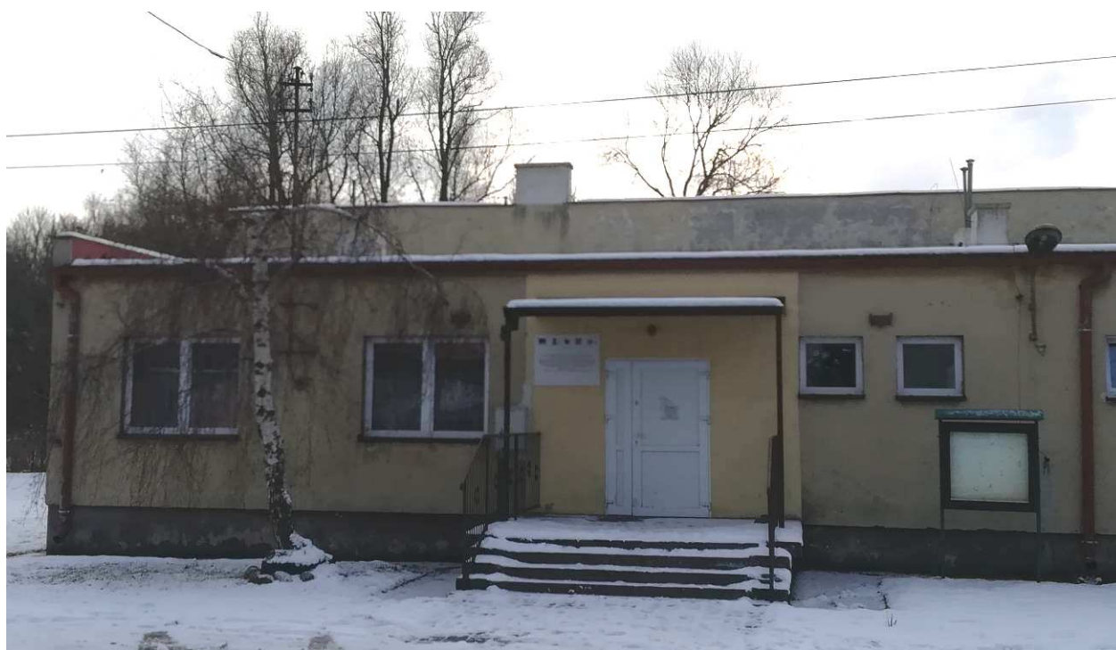
Fot.10. Zawilgocenia ponad dach ściany oddzielającej bryły budynku.
