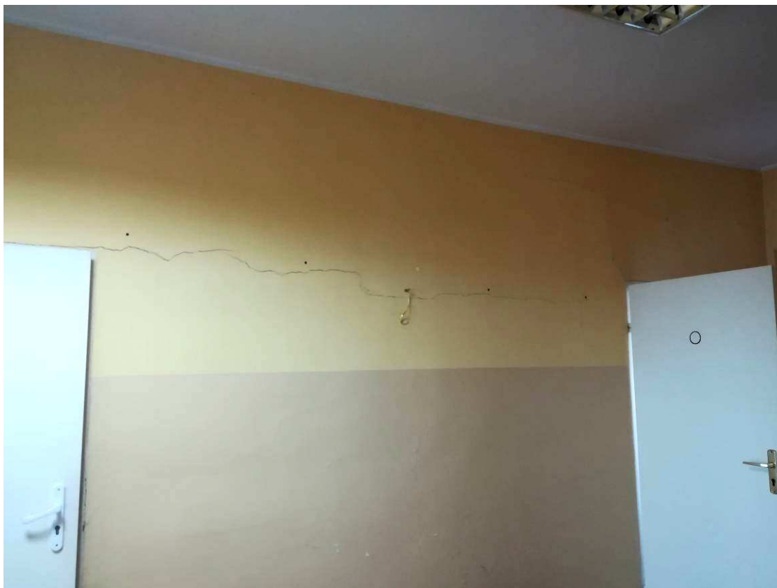
Fot.16. Rysy poziome i ukośne na ścianie działowej przy pomieszczeniach sanitariatów.
