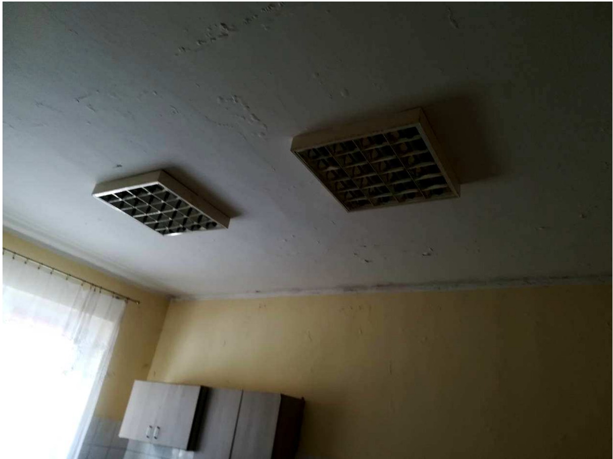
Fot.18. Widoczne zawilgocenia i klawiszowanie belek stropowych w kuchni znajdującej się w kotlinie osiadań.
