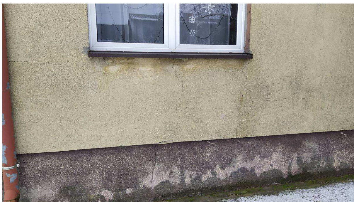
Fot.2. Pęknięcia pionowe i poziome murów w strefie kotliny osiadań.
