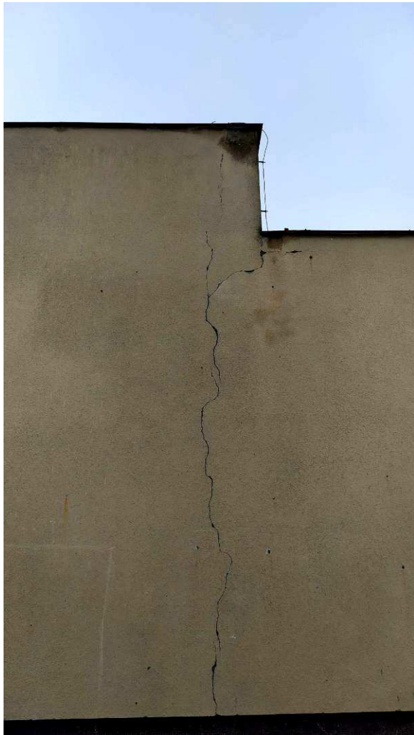
Fot.6. Pęknięcia pionowe między bryłami.
