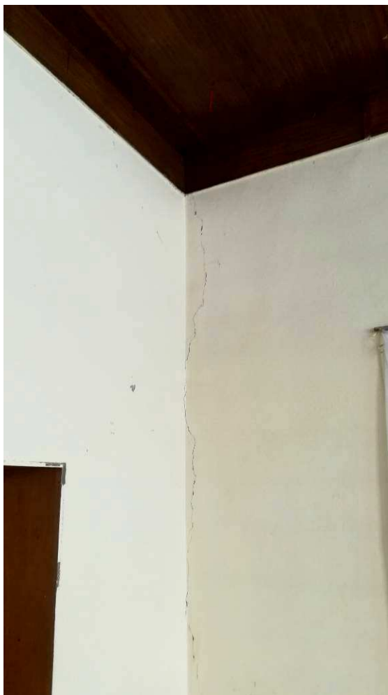
Fot.11. Rysa pionowa między bryłami, wewnątrz budynku.
