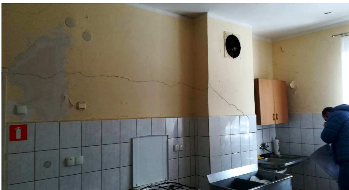
Fot.13. Rysa pionowa na ścianie działowej i pionie kominowym w kuchni.
