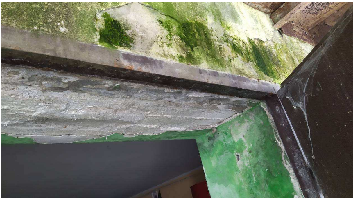
Fot.8. Zawilgocenie ścian zewnętrznych pod schodami stalowymi.
