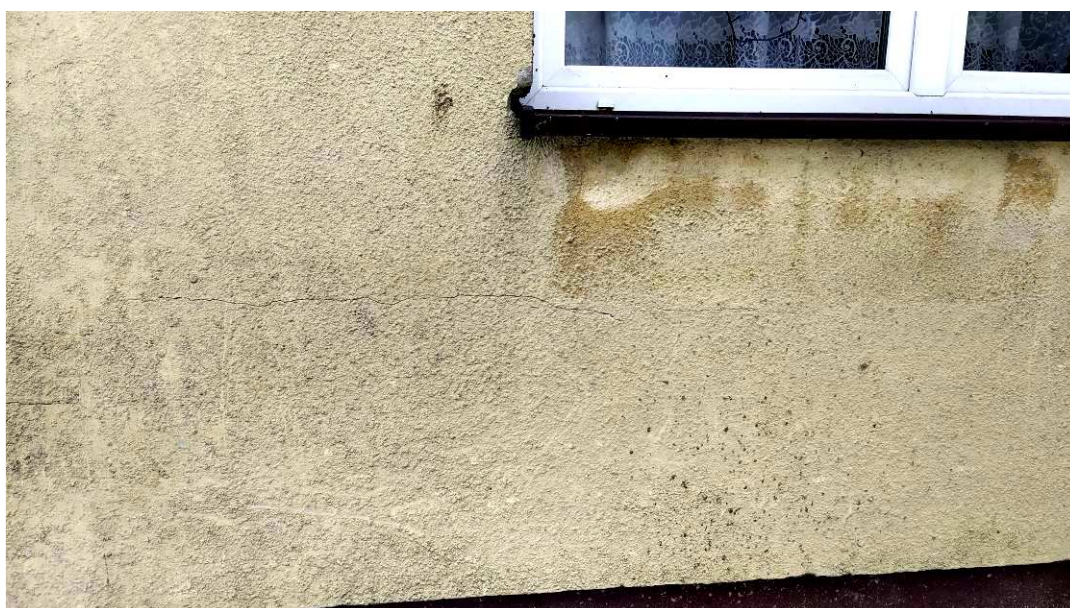
Fot.5. Pęknięcia poziome murów w strefie kotliny osiadań.
