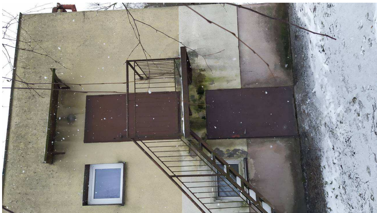
Fot.9. Zawilgocenie ścian zewnętrznych pod schodami stalowymi.
