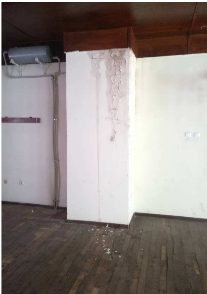
Fot.12. Nieszczelność dachu przy kominie.
