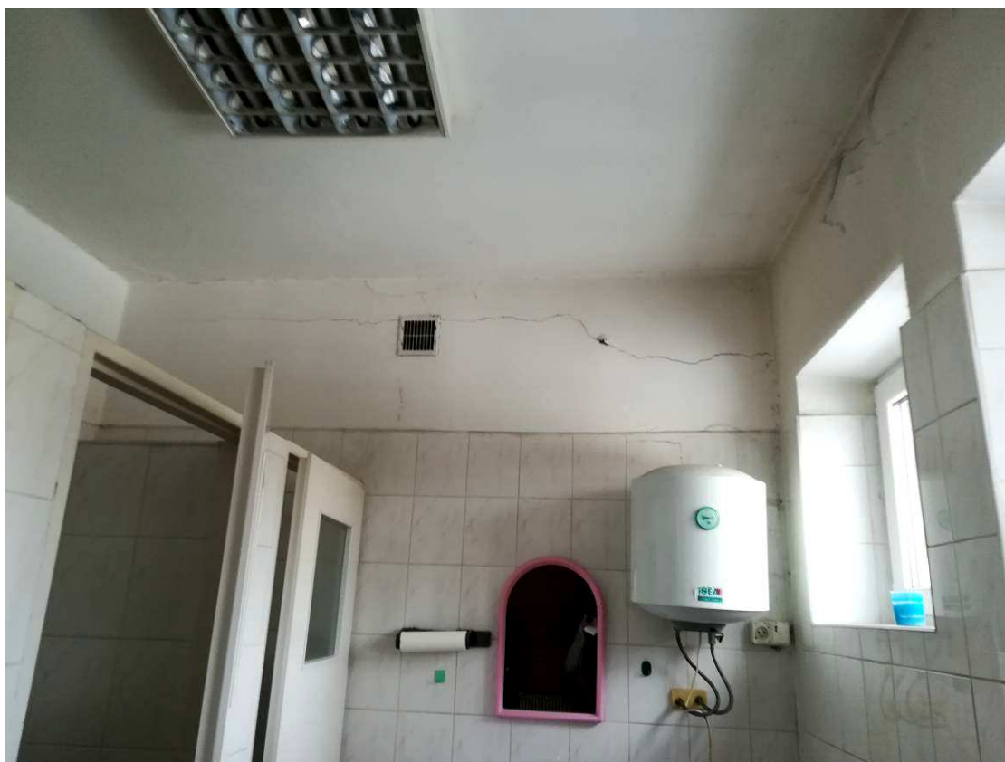
Fot.17. Odspojenie wieńca od ściany wewnętrznej stężącej.
