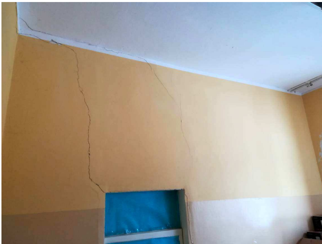
Fot.14. Rysy ukośne na ścianie działowej w pom. gospodarczym.
