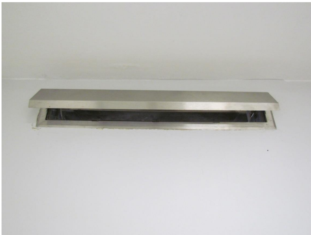
Fot.10. Nawietrzak ścienny w ścianie zewnętrznej pomieszczeniu szatni
