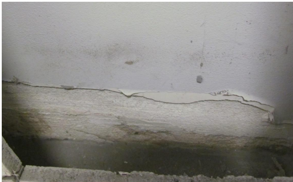
Fot.14. Zawilgocenia występujące na całej długości ściany osłonowej, która przykrywa podbicie fundamentu ściany wewnętrznej w osi 6-6
