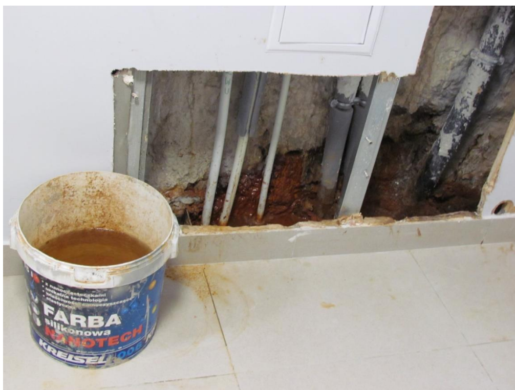
Fot.13. Zabudowa pionu wod.-kan. w narożniku ścian w osi C-6. Widoczne destrukcyjne działanie zaistniałych przecieków wodnych do wnętrza podpiwniczenia
