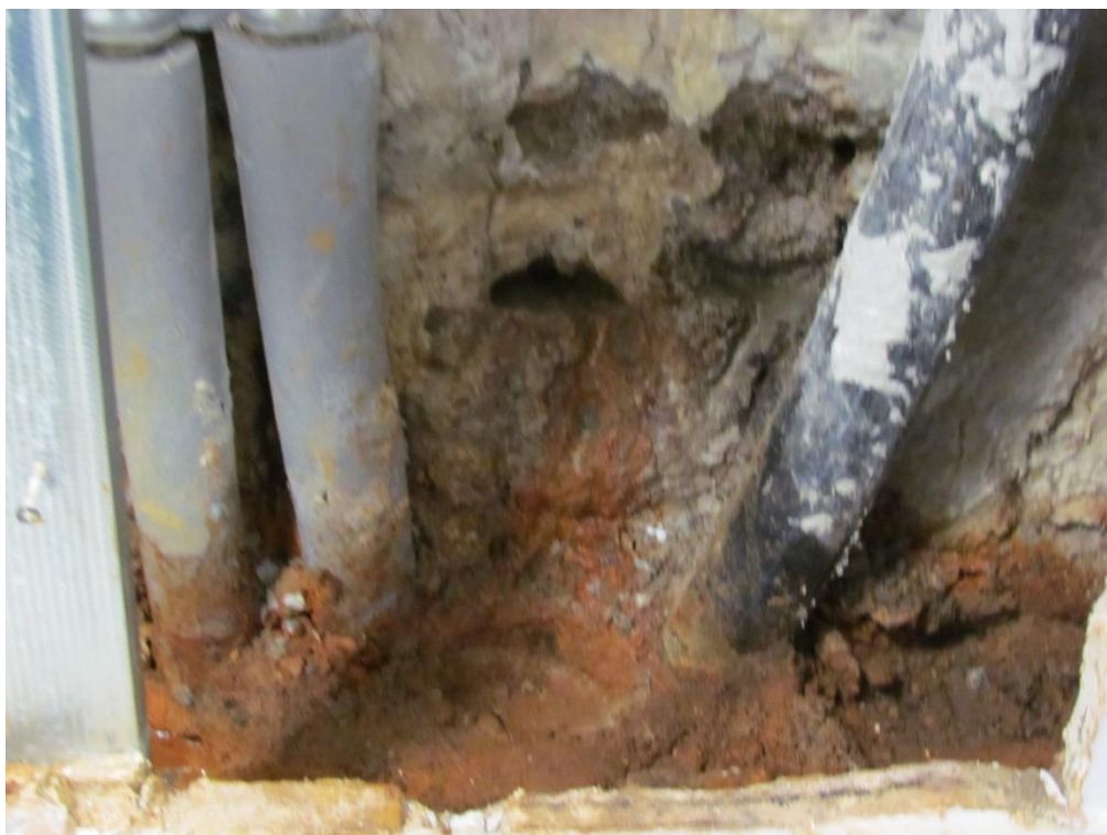
Fot.12. Zabudowa pionu wod.-kan. w narożniku ścian w osi C-6. Widoczne destrukcyjne działanie zaistniałych przecieków wodnych do wnętrza podpiwniczenia
