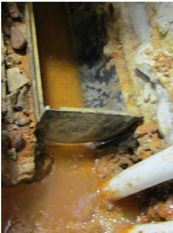
Fot.16. Korytko zbiorcze mające na celu skanalizowanie i odpływ wody gruntowej przeciekającej na całej długości ściany osłonowej, która przykrywa podbicie fundamentu ściany wewnętrznej w osi 6-6. Rozwiązanie nieskuteczne, zastosowane w trakcie eksploatacji budynku.
