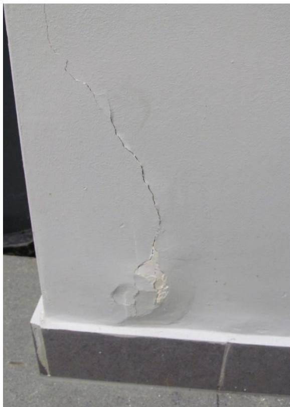
Fot.19. Narożnik ściany zewnętrznej w osi A-A, przy otworze wejściowym. Widoczne uszkodzenie tynku powstałe przez zawilgocenie budynku.
