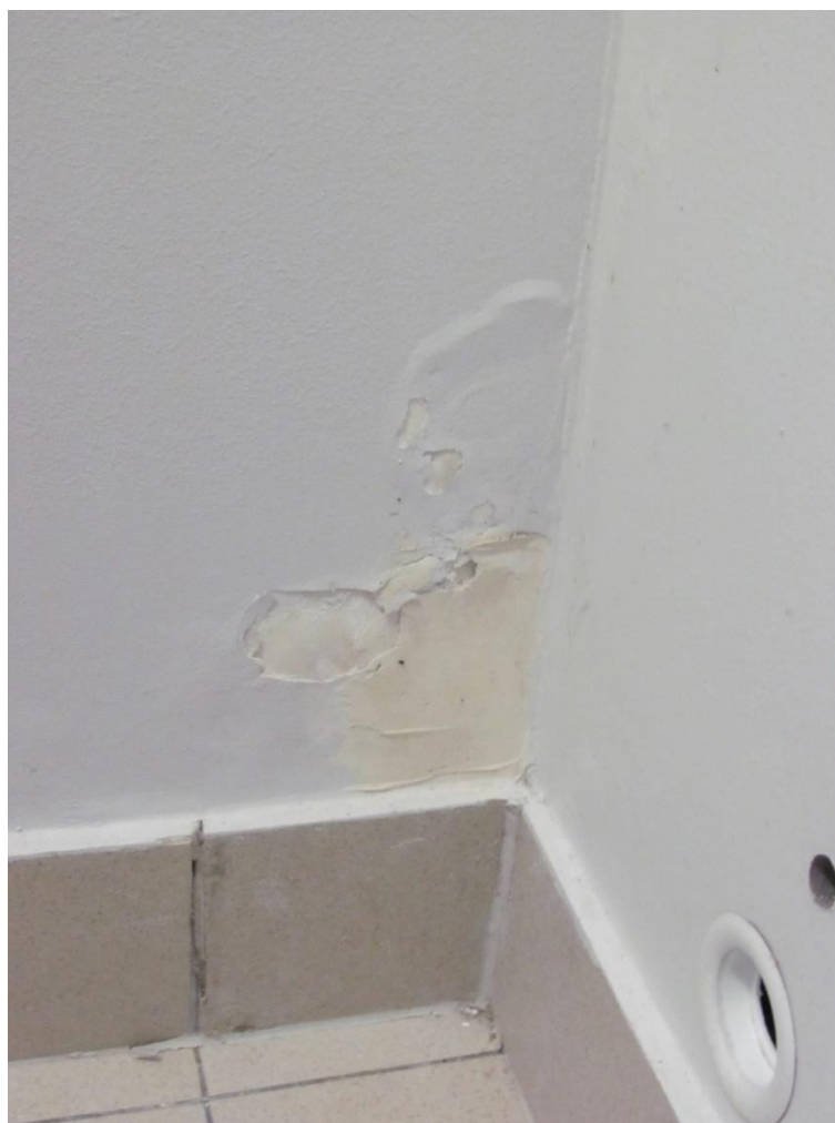
Fot.15. Zawilgocenia występujące w narożniku ścian w osi A-6
