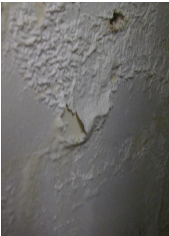
Fot.18. Ściana osłonowa z nawierconym otworem ułatwiającym odprowadzenie wody zalegającej pomiędzy ścianą osłonową, a podbiciem fundamentu ściany wewnętrznej w osi 6-6. Rozwiązanie nieskuteczne, zastosowane w trakcie eksploatacji budynku.
