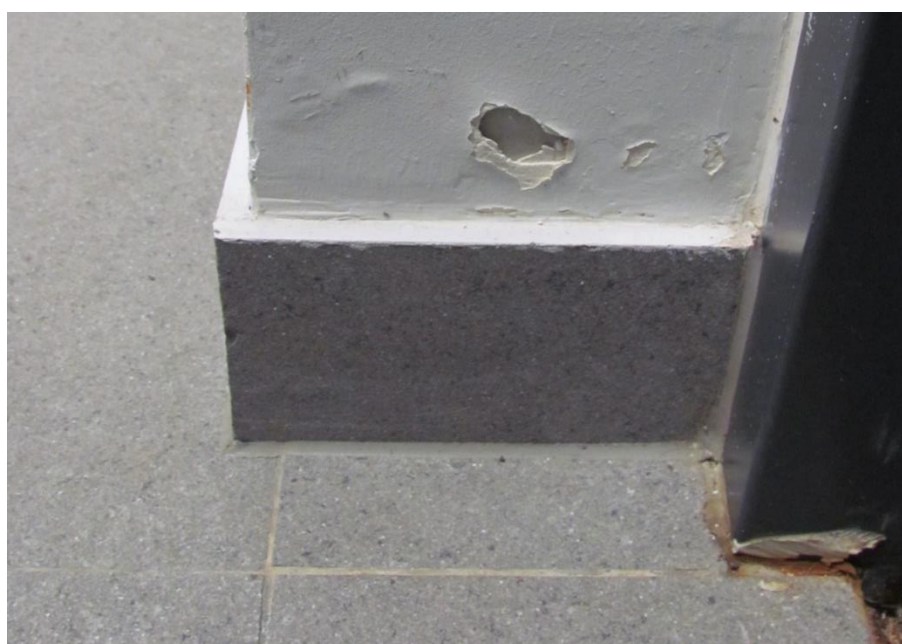
Fot.20. Narożnik ściany zewnętrznej w osi A-A, przy otworze wejściowym. Widoczne uszkodzenia tynku oraz drzwi wejściowych powstałe przez zawilgocenie budynku.
