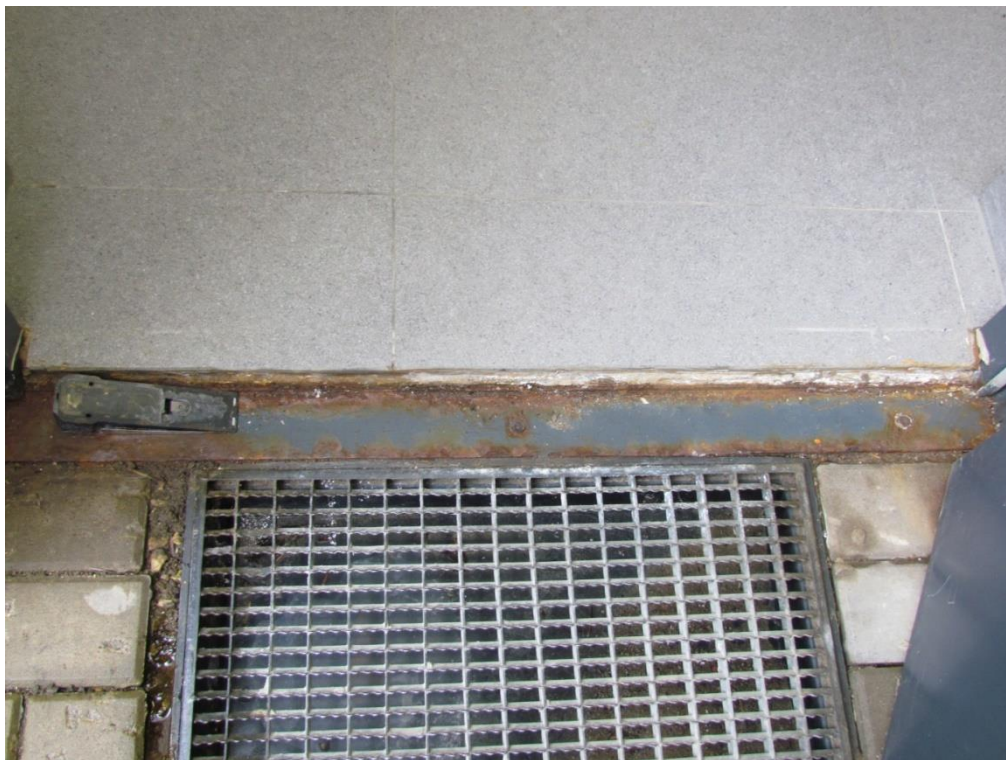
Fot.21. Wejście zewnętrzne do węzła szatniowo-sanitarnego. Widoczna korozja progu drzwi wejściowych powstała przez zawilgocenie budynku.
