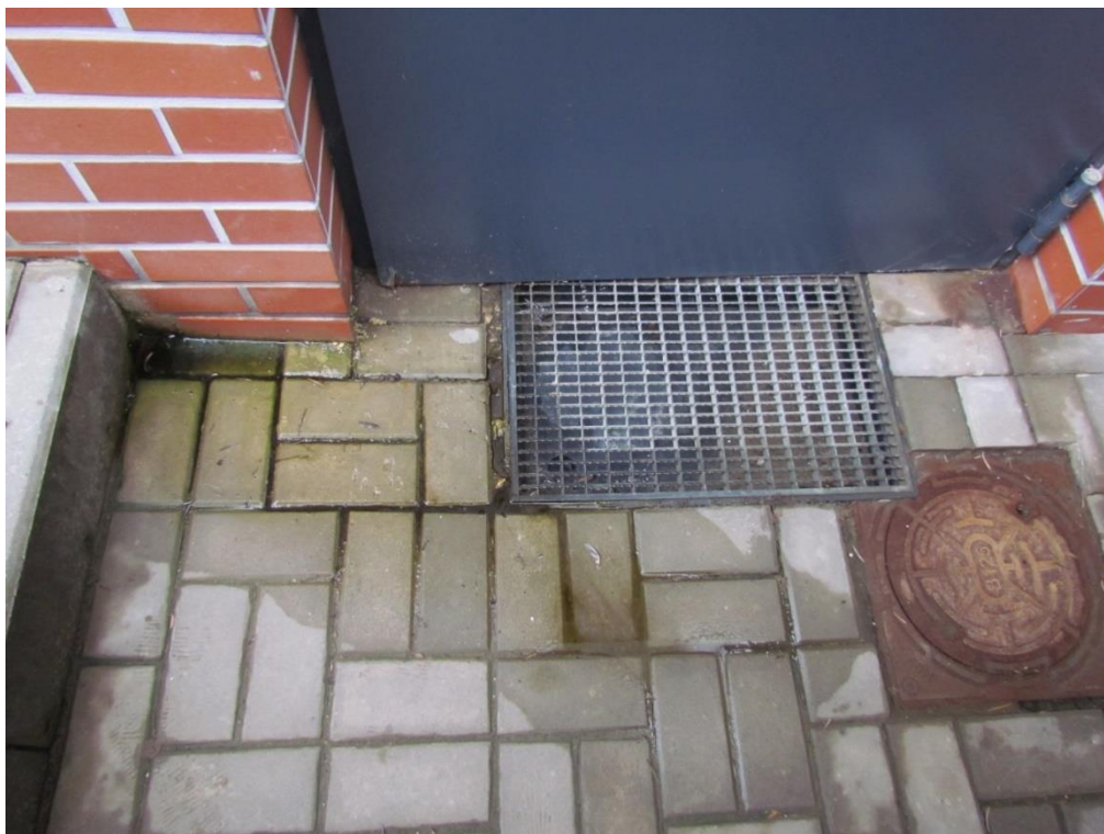
Fot.22. Wejście zewnętrzne do węzła szatniowo-sanitarnego. Widoczne przecieki wody gruntowej
