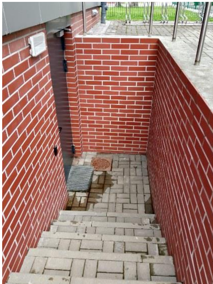
Fot.4. Elewacja południowo-wschodnia – zejście do węzła szatniowo-sanitarnego zlokalizowanego w piwnicy budynku. Widoczne przecieki wody gruntowej.
