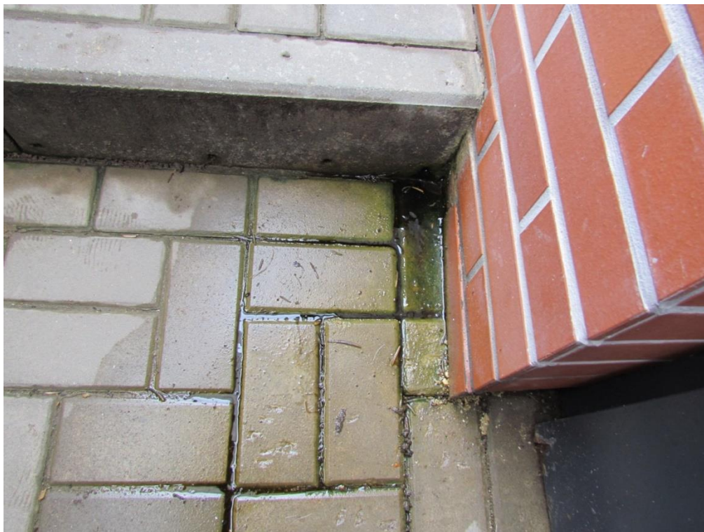
Fot.23. Wejście zewnętrzne do węzła szatniowo-sanitarnego. Widoczne przecieki wody gruntowej
