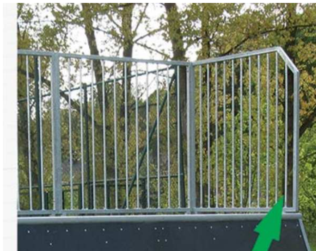
Zdjęcie 1. Ścięty kant barierki
