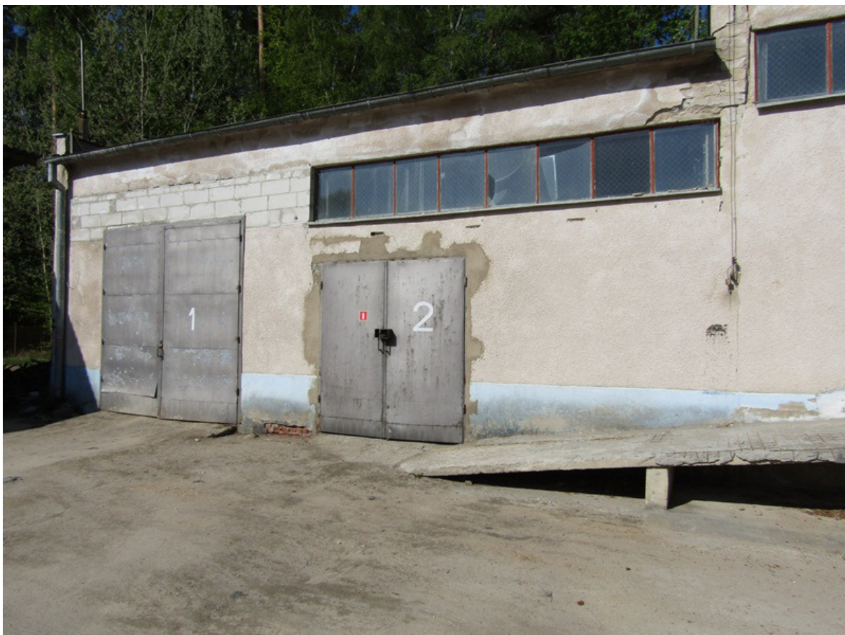
Fot. 1. Elewacja frontowa (wschodnia), drzwi nr 1 do wymiany, drzwi nr 2 nowy otwór i wielkość. Okno nad bramą 2 do zamurowania. Uszkodzenia muru pomiędzy niską i wysoką częścią.
