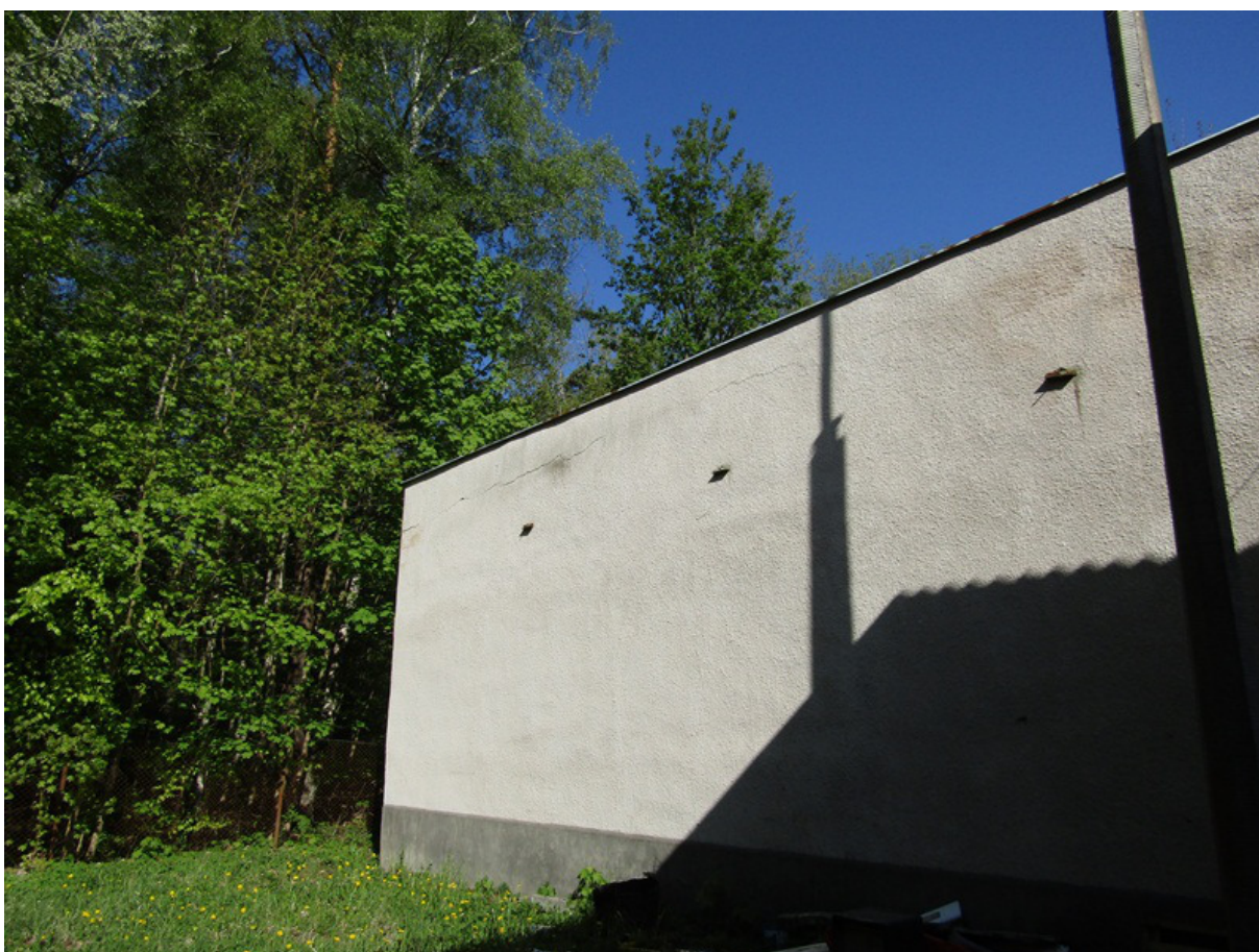
Fot. 7. Elewacja południowa. Wsporniki do usunięcia.
