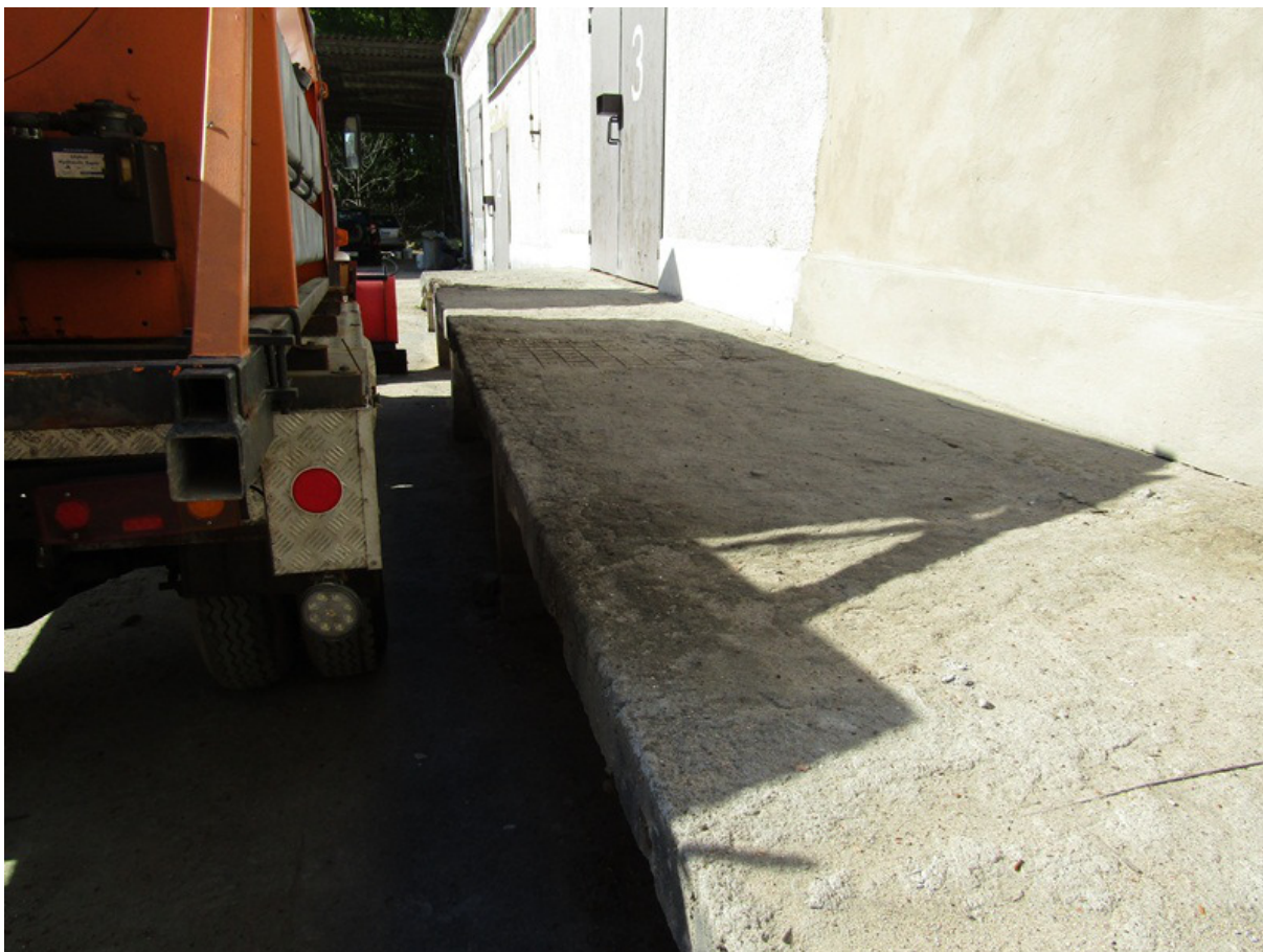
Fot. 6. Elewacja wschodnia cd. Widoczne uszkodzenia rampy betonowej.
