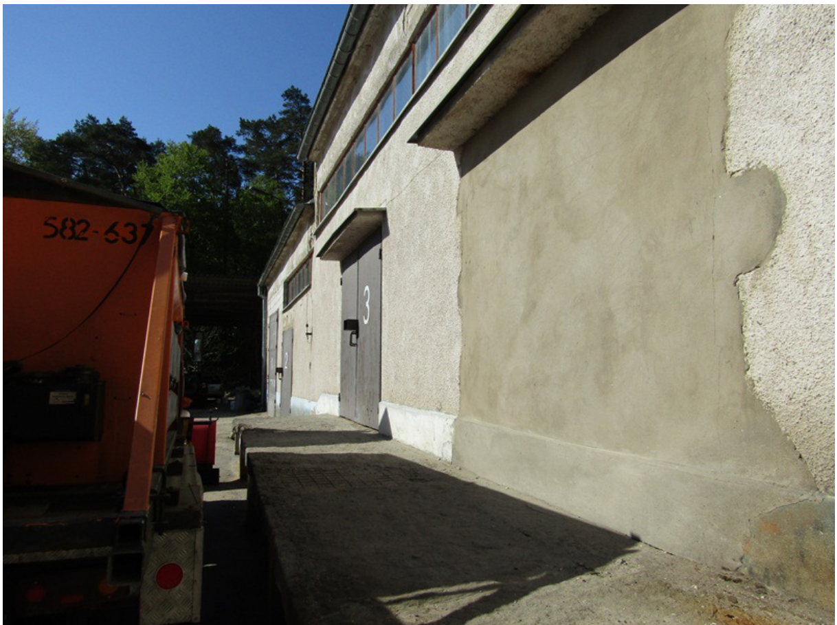
Fot. 4. Elewacja wschodnia cd. Brama nr 3 do wymiany a okno nad nią do zamurowania.
