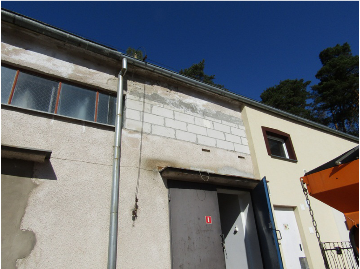
Fot. 3. Elewacja wschodnia cd. Styk z częścią ocieploną (biurową) i granica z nową rynną. Brama nr 4 do wymiany.
