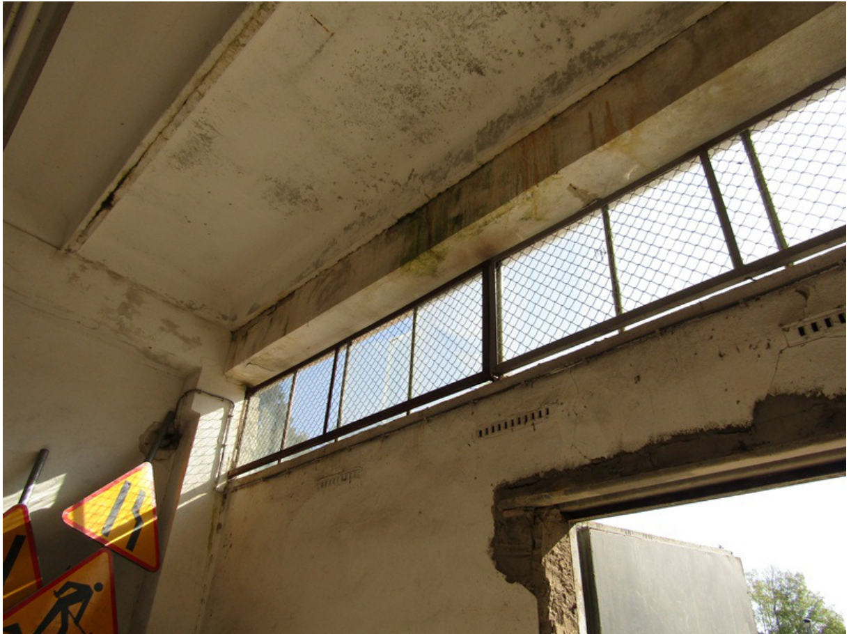
Fot. 8. Uszkodzenia i zagrzybienia tynku – przy bramie nr 2.
