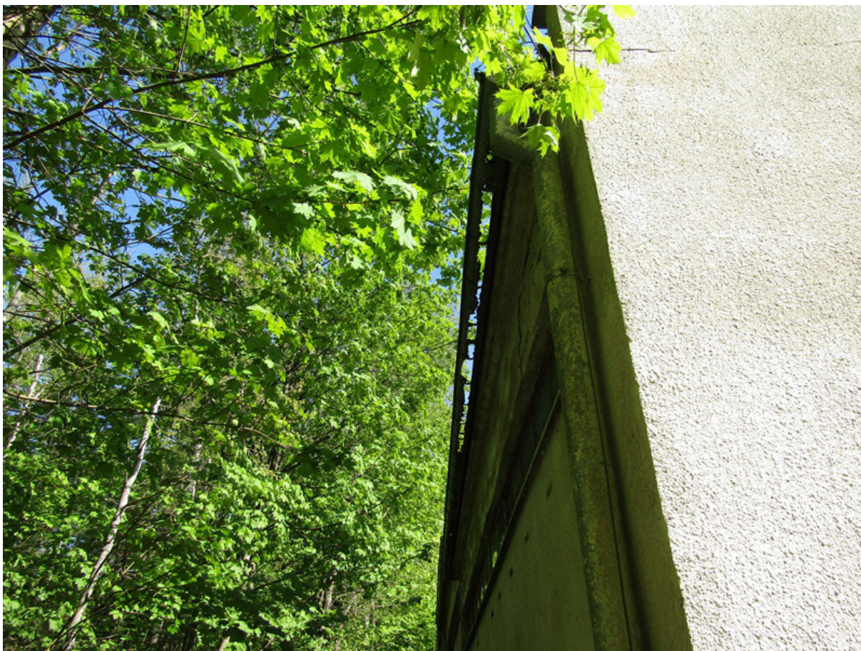
Fot. 10. Zniszczona rynna wzdłuż elewacji tylnej (zachodniej).
