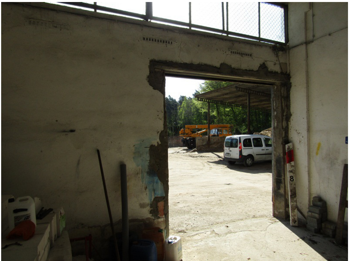
Fot. 9. Uszkodzenia i zagrzybienia tynku – przy bramie nr 2 cd.
