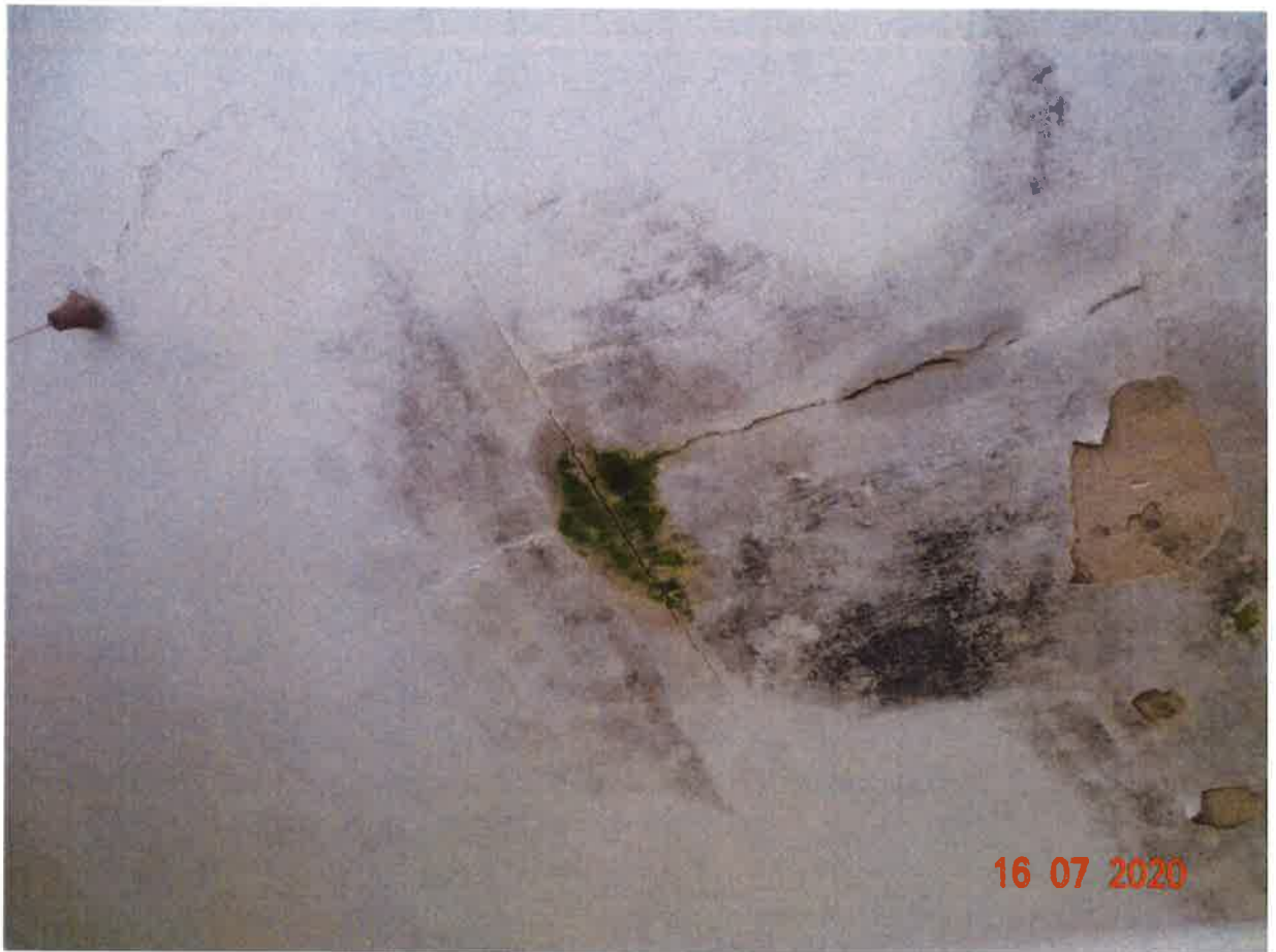
zdjęcie 2. Zagrzybienie sufitu
