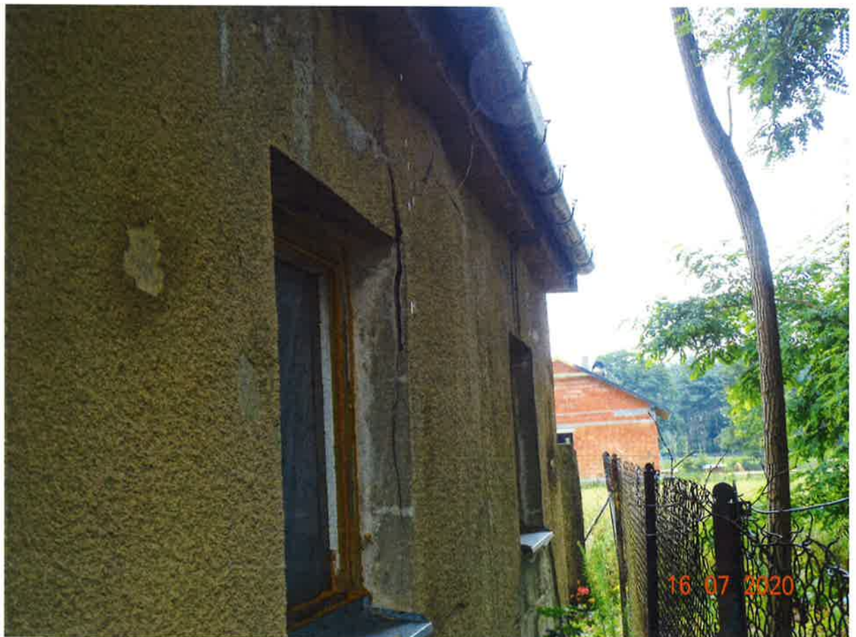
zdjęcie 3. Degradacja ściany
