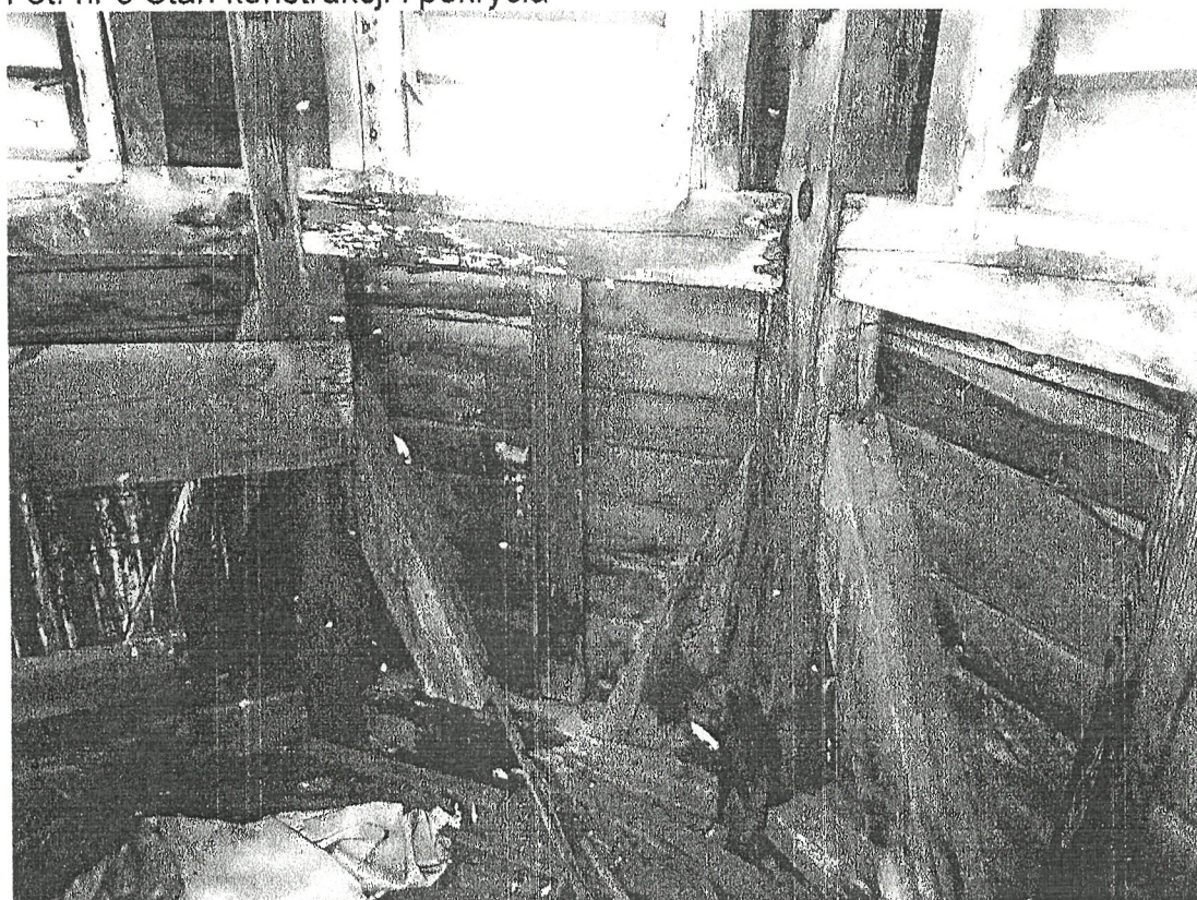
Fot. nr 6 Stan konstrukcji i pokrycia
