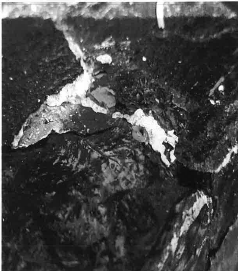
fot. 4 i 5 Zniszczenia mensy wynikające z zawilgocenia
