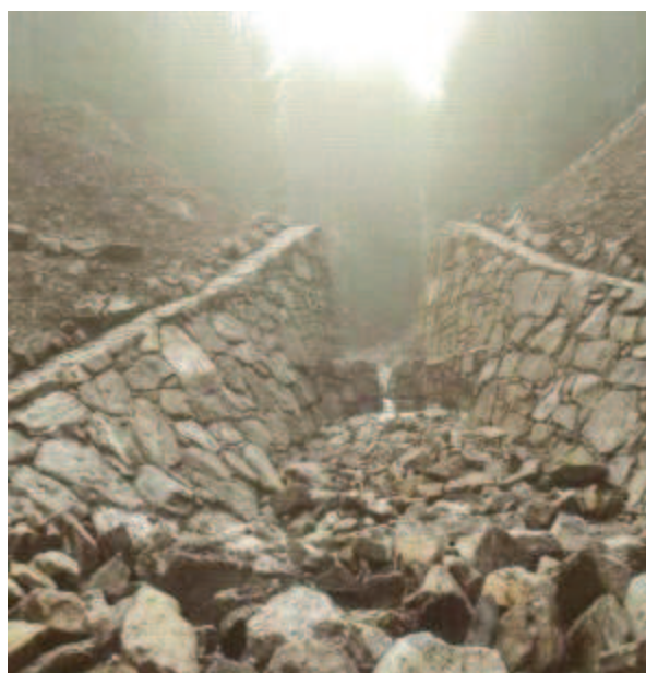
Przepławka szczelinowa na suchym zbiorniku w I-ctwie Jawornica (fot. N-ctwo Międzylesie)
