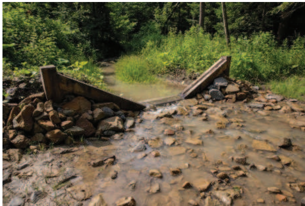
Próg powyżej brodu ukierunkowujący wodę na bród.
