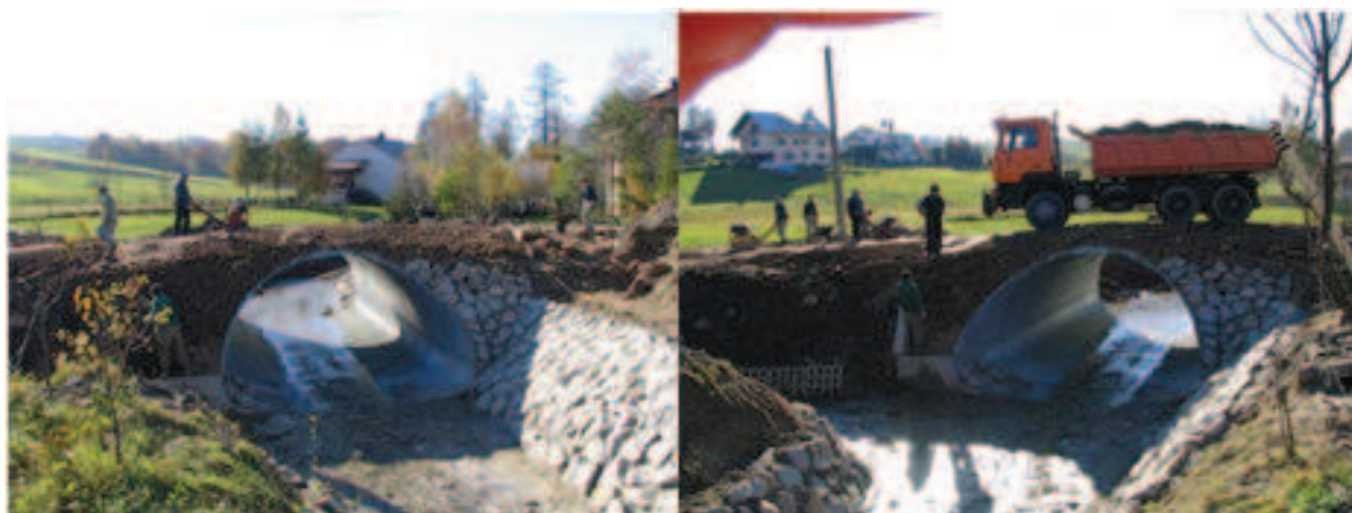
Przykłady adaptacji przepustów do zmian klimatu.
