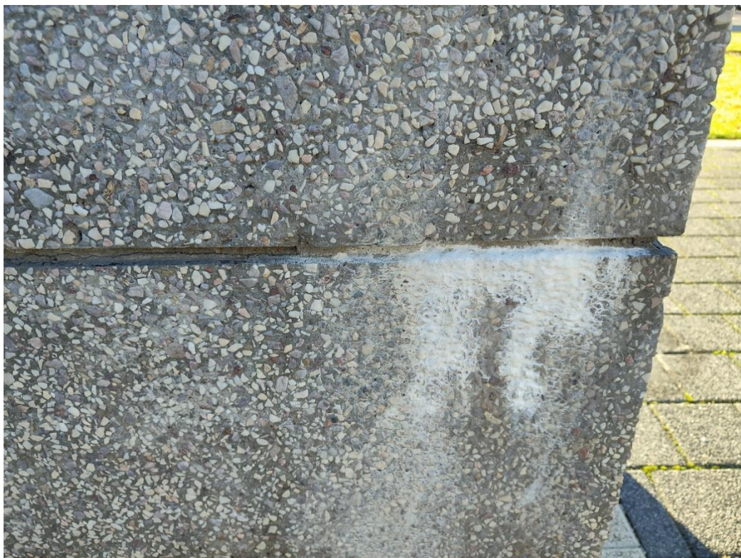
Fot. 11 Wykwity na połączeniu 1 i 2 segmentu. Połączenia pomiędzy elementami nie wypełnione.
