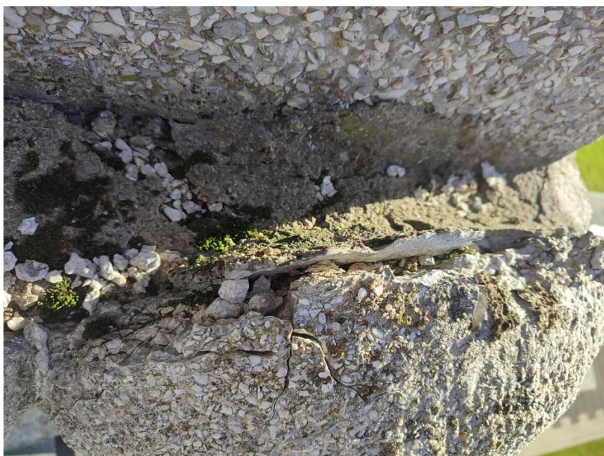
Fot. 32 Struktura płaskorzeźb wyraźnie rozwarstwiona, ślady penetracji wody, korozji betonu, częściowe zniszczenie materiału- widok z góry.
