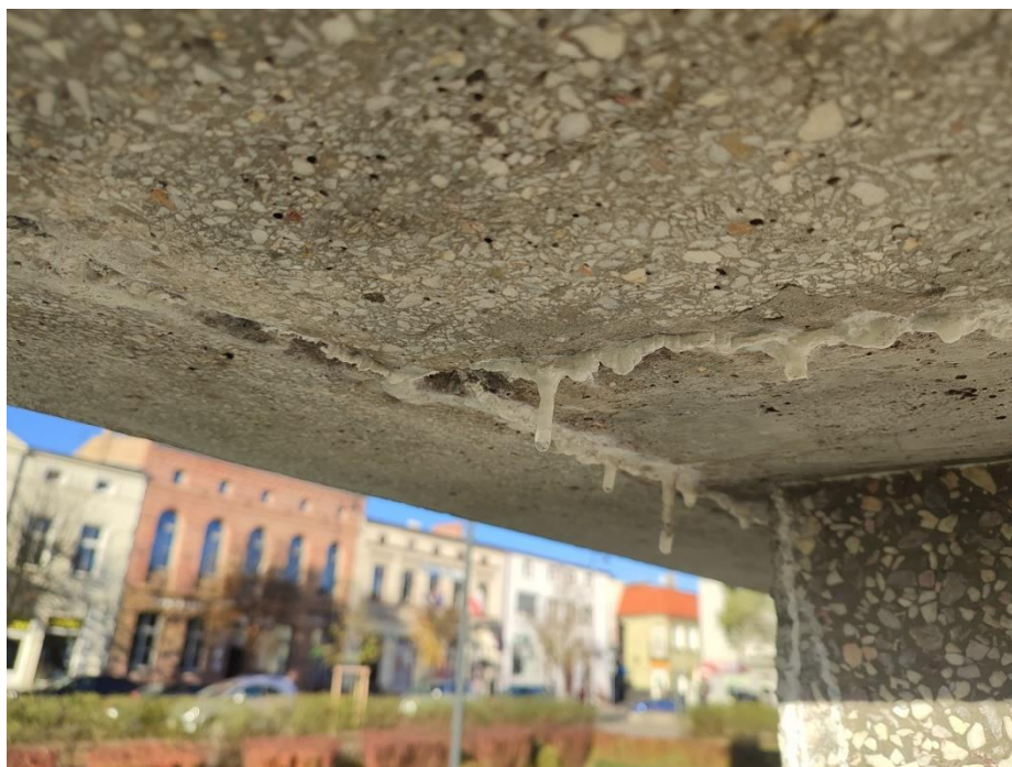
Fot. 21 Na połączeniach płyt pamiątkowych zwisają kilkucentymetrowe stalaktyty po których ścieka woda.
