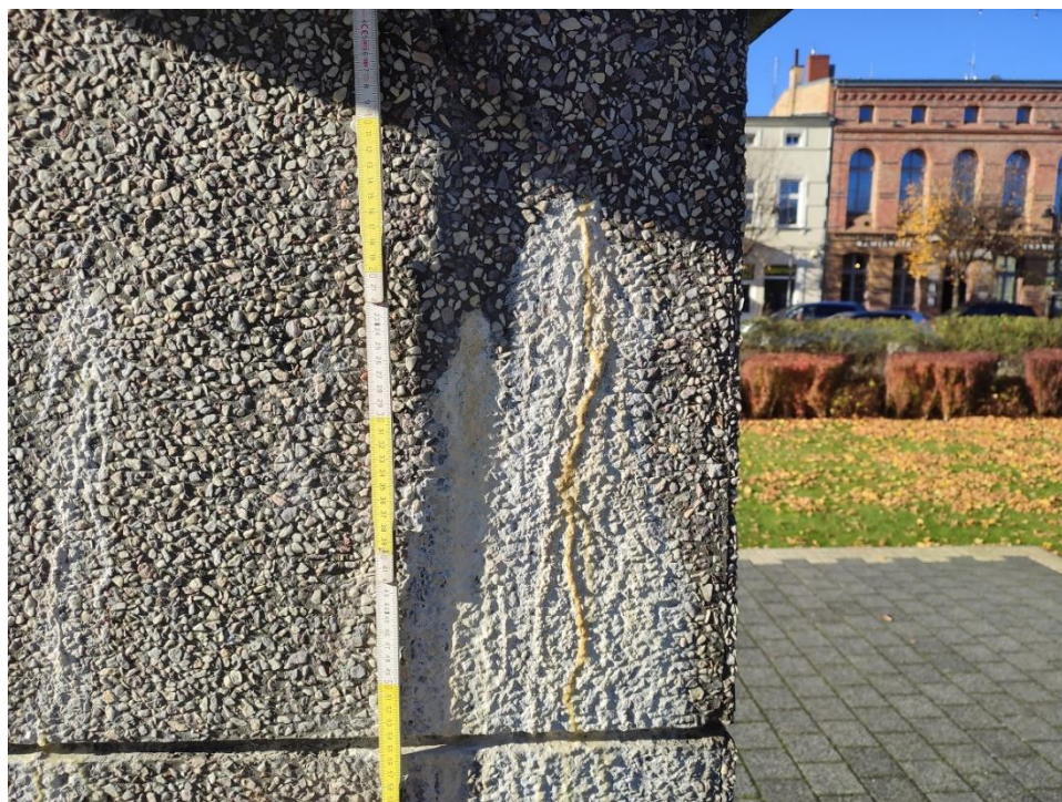
Fot. 10 Zbliżenie na wycieki na 2 i 3 segmencie od strony wschodniej.
