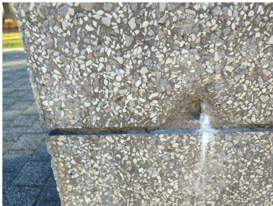
Fot. 14 kilkucentymetrowe wykruszenie na styku 1 i 2 segmentu. Widoczne wykwyty wapienne.
