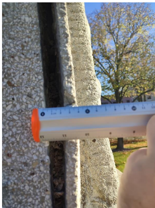
Fot. 29 Płyta odstaje 2,5cm od płaskorzeźby i jest wyraźnie luźna. Za jej lica wysypuje się luźne kruszywo.
