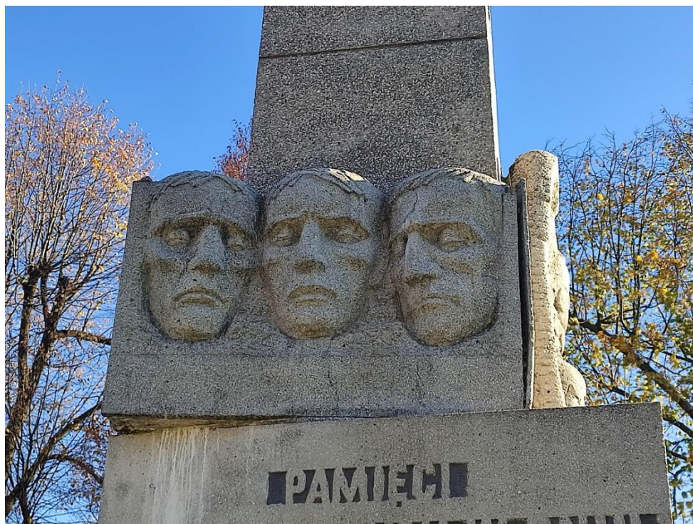
Fot. 31 Na płaskorzeźbie przedstawiającej ofiary II Wojny Światowej liczne spękania i wykruszenia.
