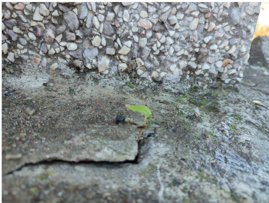
Fot. 35 Brak odpowiedniego wyprofilowania powierzchni poziomej powyżej rzeźb, nieszczelne połączenia, widoczne pęknięcia w których rośnie roślinność. Pomimo godziny 12.00 i braku opadów powierzchnia cały czas wilgotna.
