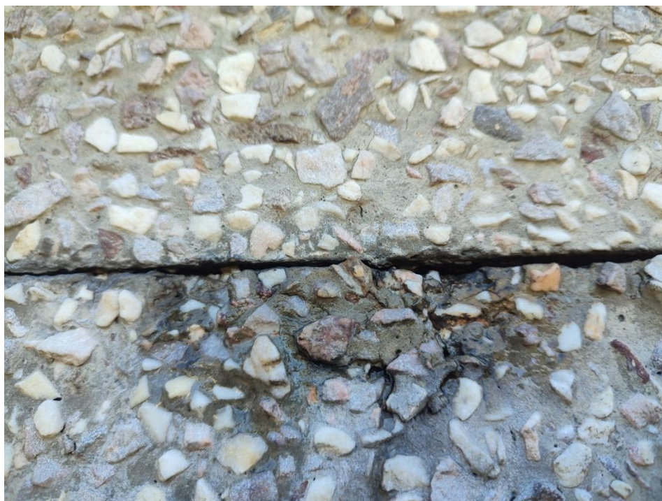
Fot. 17 Wyciek wody spomiędzy segmentów, widoczne wykruszenie. Spoiny pomiędzy segmentami różnej szerokości.
