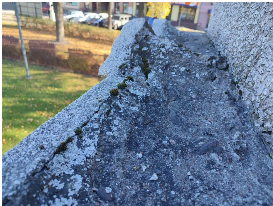
Fot. 33 Połączenie płaskorzeźb z pomnikiem- widoczna korozja biologiczna, korozja wystającego zbrojenia, wegetacja roślin, liczne niecki w których gromadzi się woda.
