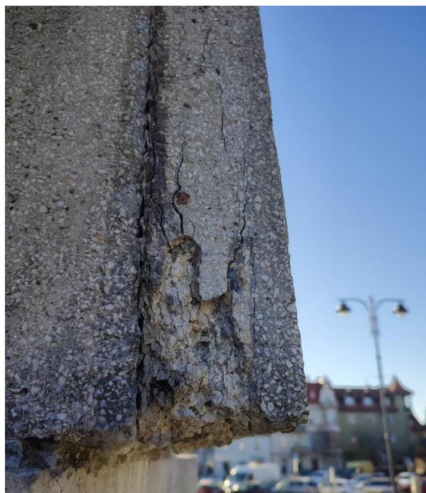
Fot. 24 Fragment płyty z płaskorzeźbą- całkowite zniszczenie struktury materiału. Doszło do rozwarstwienia struktury i wyszczerbienia materiału.
