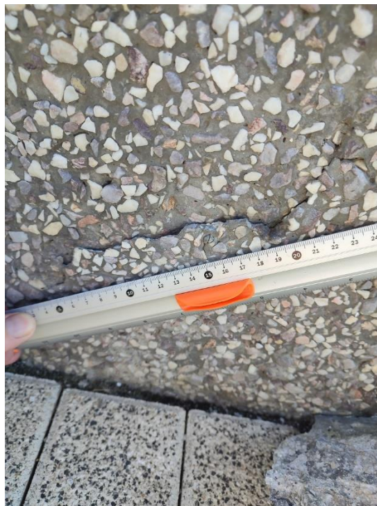
Fot. 16 U podstawy pierwszego segmentu odspojenie i wykruszenie na długości kilkunastu centymetrów.
