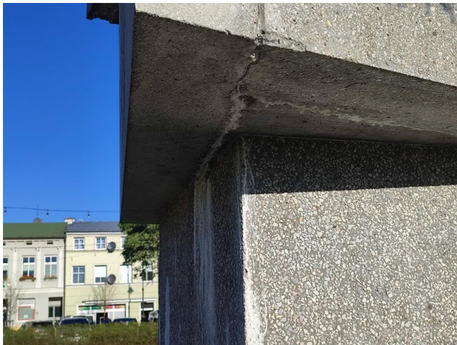
Fot. 23 Wyszczerbienia płyt pamiątkowych w pobliżu połączeń. Wykruszenia materiału.
