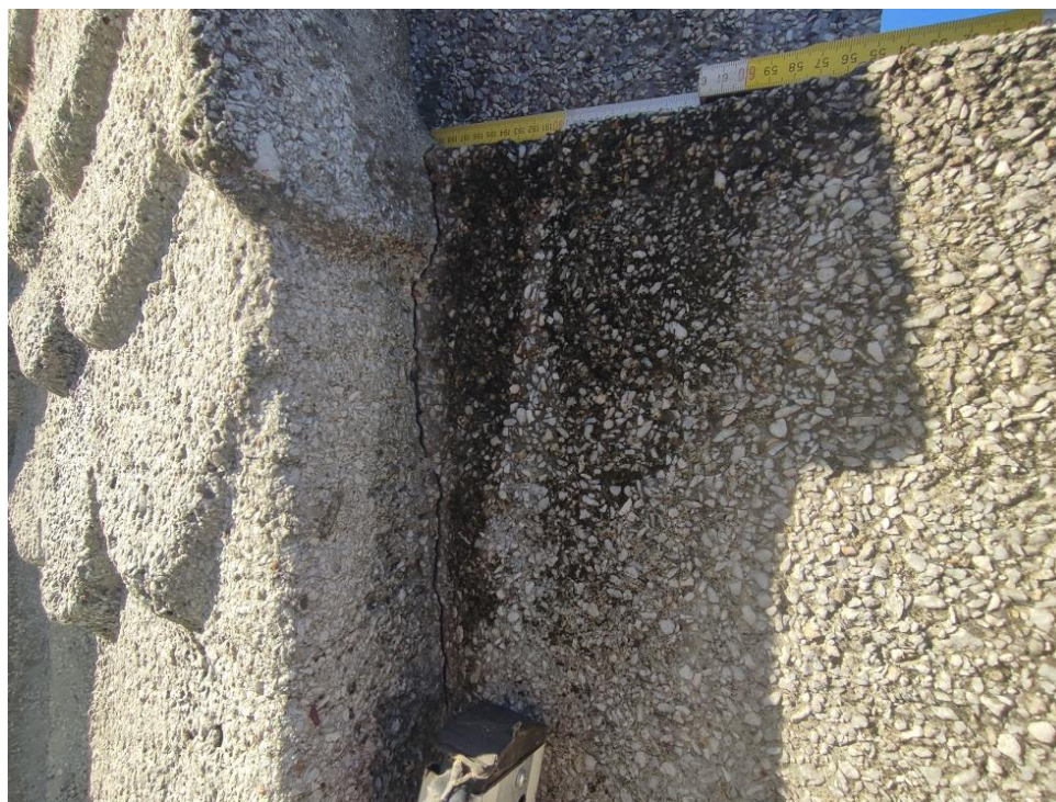
Fot. 36 Na połączeniu rzeźby orła z pomnikiem wyraźne pęknięcie pionowe.
