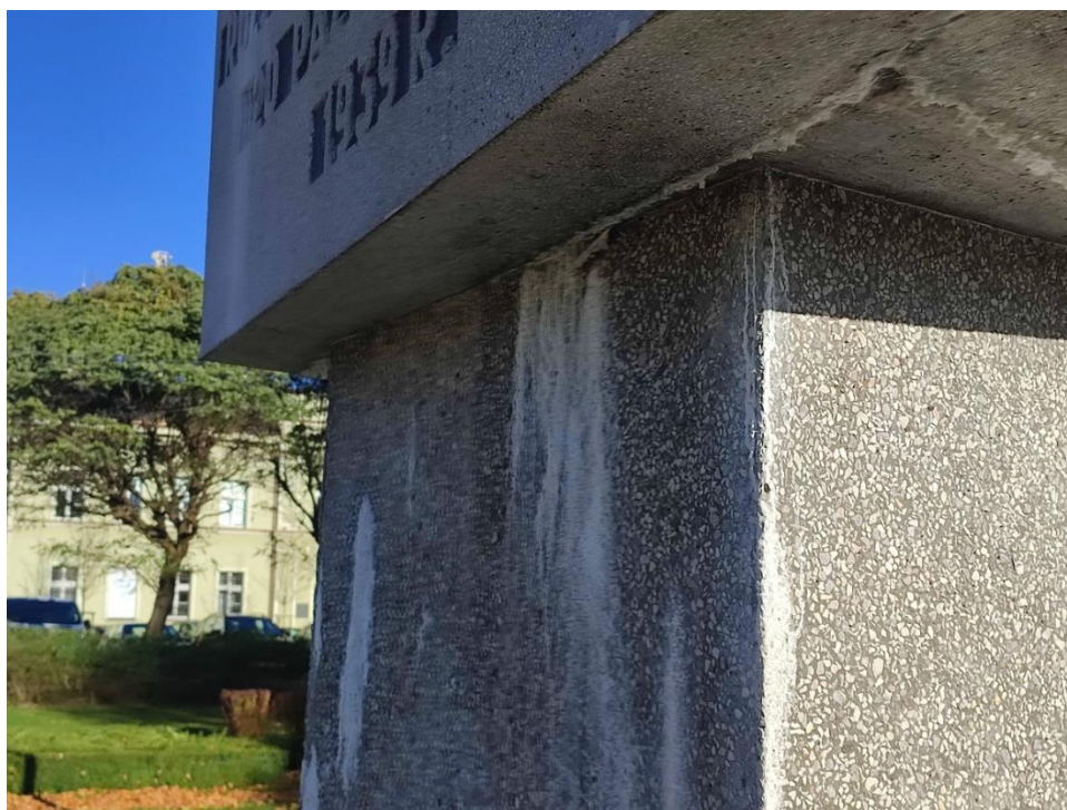
Fot. 22 Wycieki spod płyty pamiątkowej od strony północnej.
