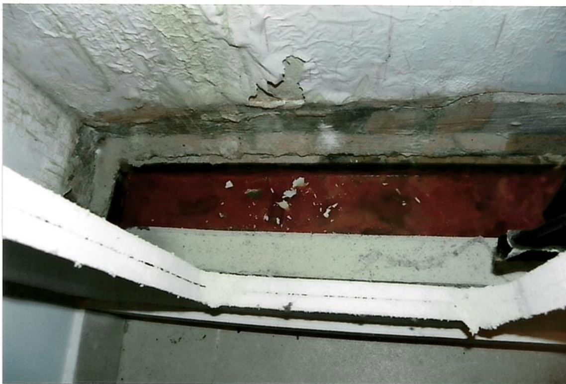
Widok na korytko zbiorcze zlokalizowane za przepierzeniem z płyt g-w. Rozwiązanie nieuwjęte w projekcie budowlanym.
