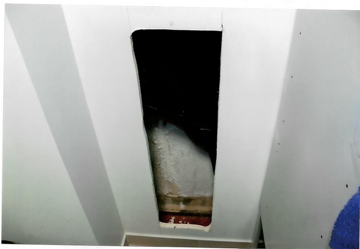
Widok na otwory badawcze w przepierzeniu nie ujętego w projekcie budowlanym.
