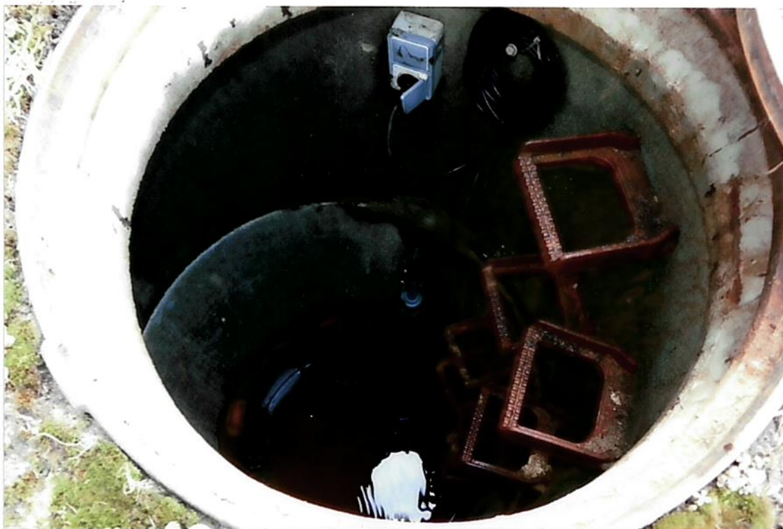
Widok ogólny na przepompownie wód drenarskich.
