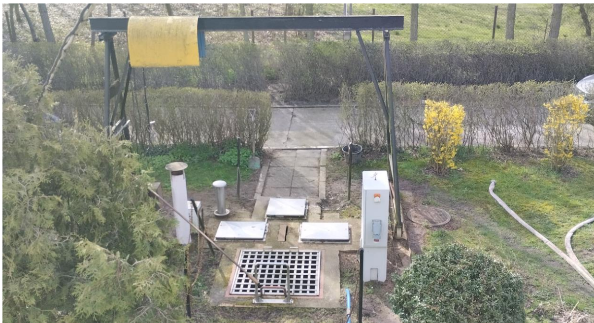
Rysunek 4 Pompownia ścieków z kratą koszową
