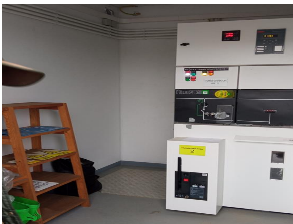
RYСУNEK. WIDOK ROZDZIELNI SN w STACJI WRW8278
