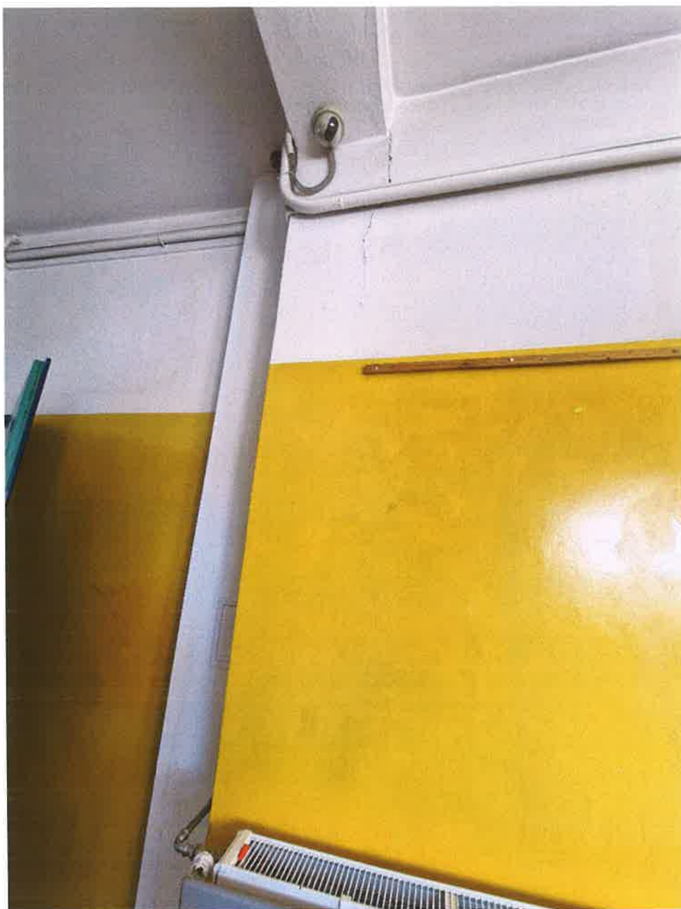
Zdjęcie nr. 3 Widok rysy powstałej w wyniku pracy konstrukcji
