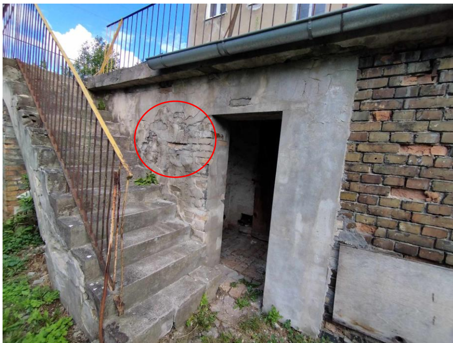
Fot. 9 Widoczne wyeksplotowane tynki na ścianach, schody na taras. Istniejąca balustrada do wymiany.
