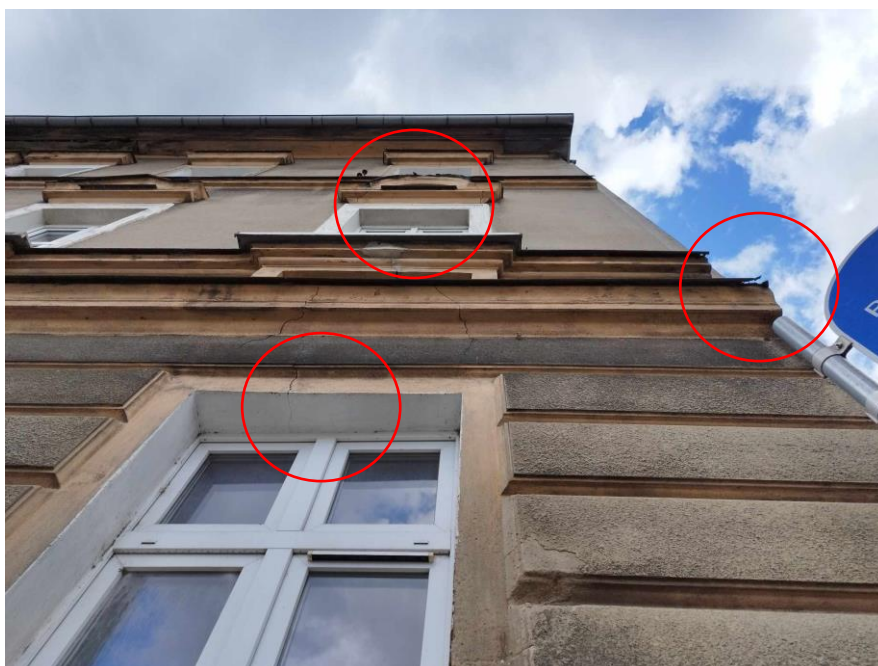
Fot. 2 Widoczne spękania tynków, uzupełnienia zapraw, zniszczone opierzenia gzymsów.
