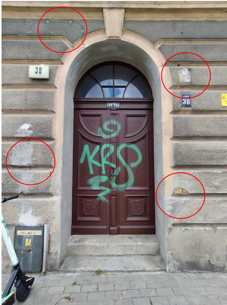
Fot. 1 Widoczne ubytki spowodowane montażem instalacji czy też tabliczek, część z nich została uzupełniona przypadkowymi zaprawami mineralnymi zaburzając estetykę elewacji, a tym samym zatarte zostały profile. Ubytki w tynku odsłoniły cegły. Widoczna dewastacja drzwi frontowych. Zawilgocenie ścian.
