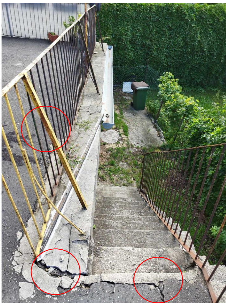
Fot. 10 Nawierzchnia tarasu w złym stanie technicznym.
