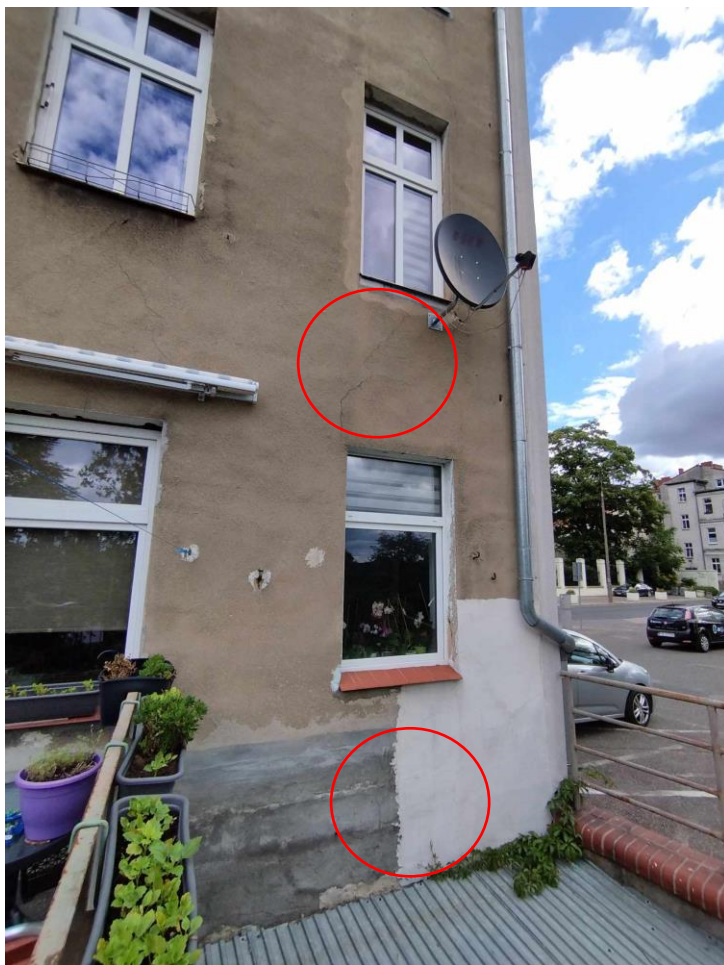
Fot. 7 Widoczne spękanie tynków, różnego rodzaju zaprawy tynkarskie
