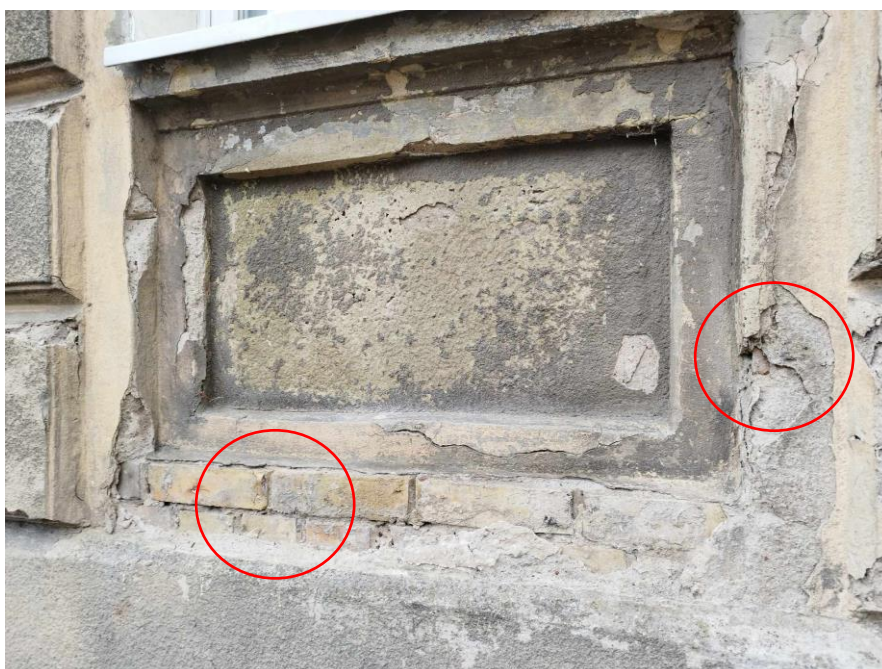
Fot. 4 Widoczne odsłonięcie cegieł, ubytki w tynkach
