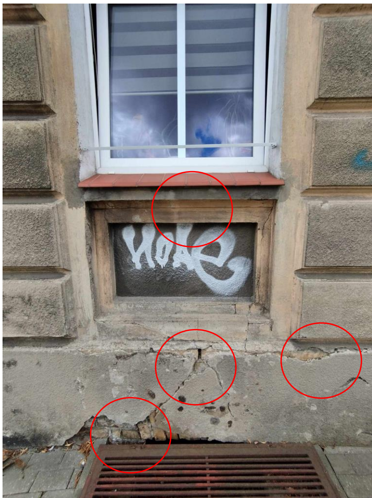
Fot. 3 Widoczne pęknięcia i rysy, przed rozpoczęciem wykonywania robót budowlanych należy sprawdzić stan techniczny konstrukcji murowej i w przypadku stwierdzenia ich złego stanu należy wykonać projekt wzmocnień konstrukcji murowej np. w systemie Helifix, Brutt Saver, Stati- Cal. Widoczne braki spoin. Uzupelnienia tynków zaprawami.
