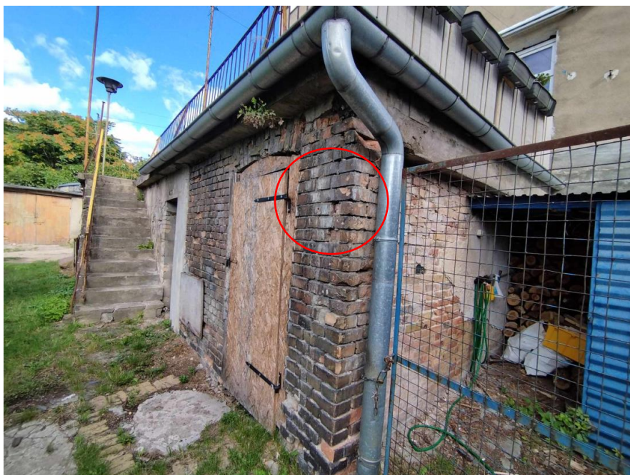
Fot. 8 Zły stan techniczny ścian tarasu. Widoczne braki cegieł, spoin, zawilgocenie muru. Wrota do wymiany.
