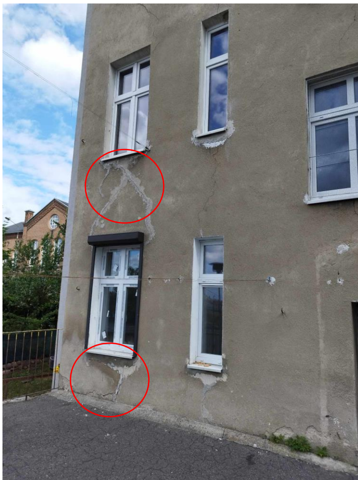
Fot. 6 Widoczne pęknięcia i rysy na elewacji od strony podwórza, przed rozpoczęciem wykonywania robót budowlanych należy sprawdzić stan techniczny konstrukcji murowej i w przypadku stwierdzenia ich złego stanu należy wykonać projekt wzmocnień konstrukcji murowej np. w systemie Helifix, Brutt Saver, Stati- Cal.
