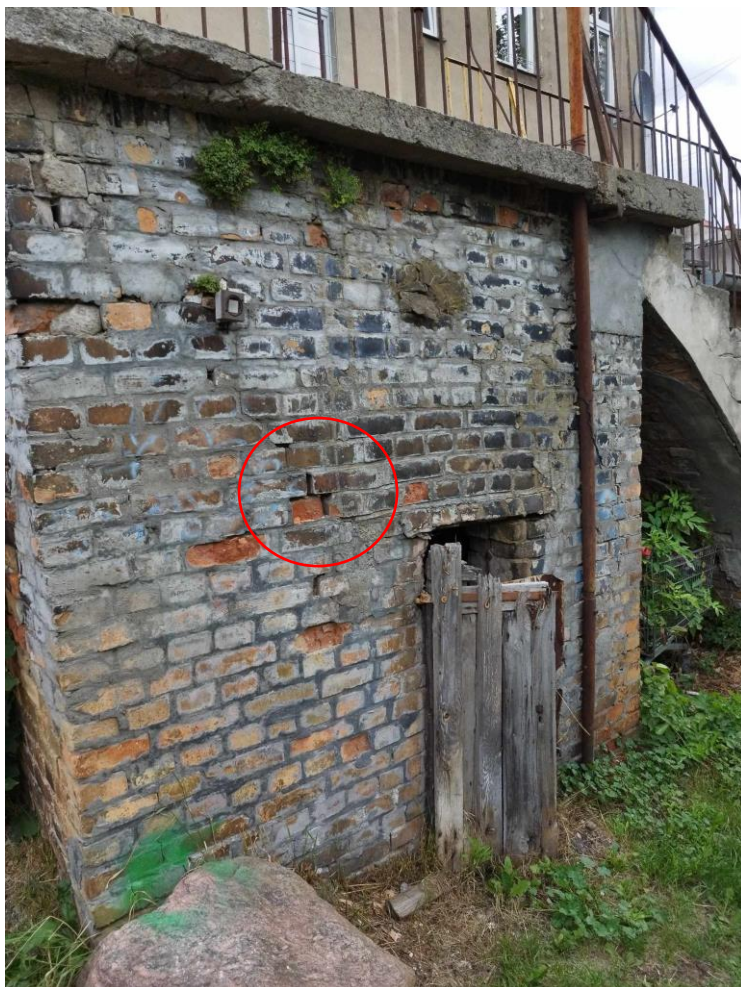
Fot. 11 Przed wykonywaniem robót należy sprawdzić stan techniczny konstrukcji ścian tarasu-narożnika, widoczne braki spoin, pęknięcia muru- ogólny stan techniczny tarasu określony jest jako zły.
