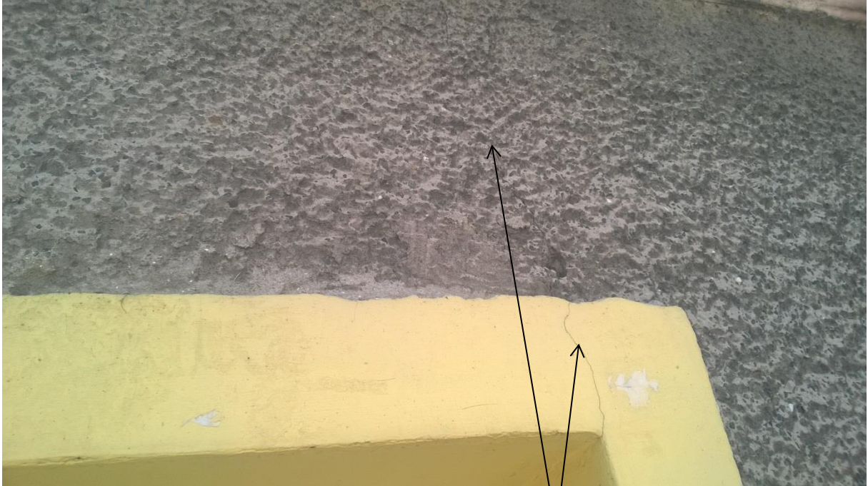
spękanie ściany nad oknem parteru
