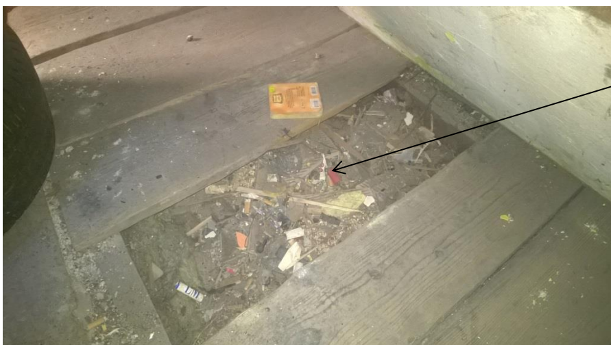
ubytek desek posadzki
