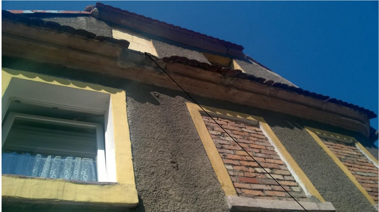
ubytek obróbki z dachówek ceramicznych na gzymsie międzypiętrowym
