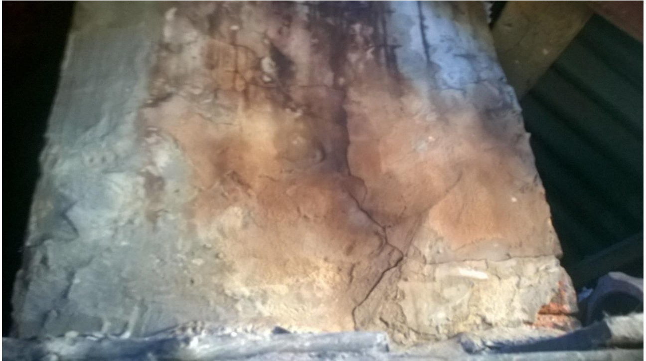
spękanie tynku na ścianie kominowej
