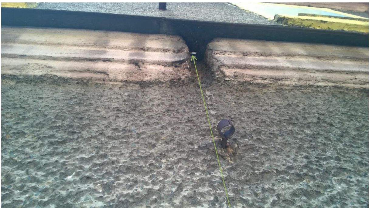
korozja obróbki blacharskiej, nieszczelność obróbki
