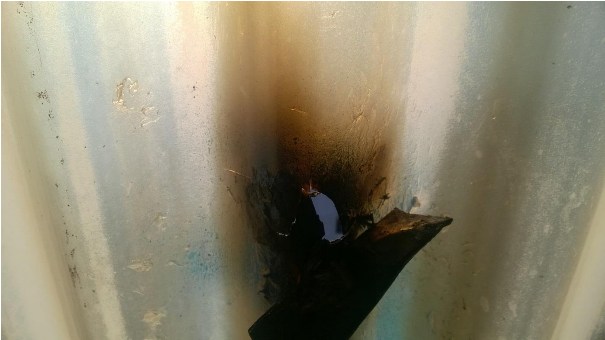
uszkodzenie pokrycia dachowego z płyty falistej pcv
