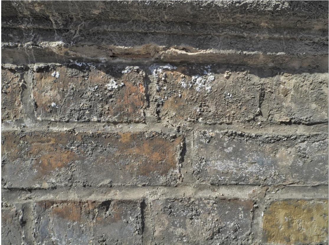
Fot.24. Gorzów Wlkp. ul. Wyszyńskiego 29, fasada, wysolenia na cegle w dolnej partii cokołu, widoczna opracowana fuga (wyk. P. Antoniuk).
