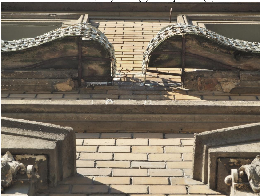
Fot.17. Gorzów Wlkp. ul. Wyszyńskiego 29, fasada, parapety mansardy, widoczne zniszczenia w obrębie gizmsów oraz drewnie parapetów (wyk. P. Antoniuk).
