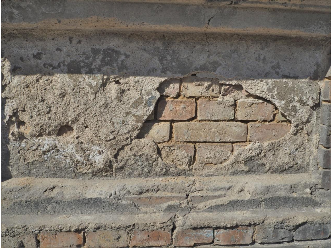
Fot.22. Gorzów Wlkp. ul. Wyszyńskiego 29, fasada, stan zachowania tyków w górnej partii cokołu (wyk. P. Antoniuk).
