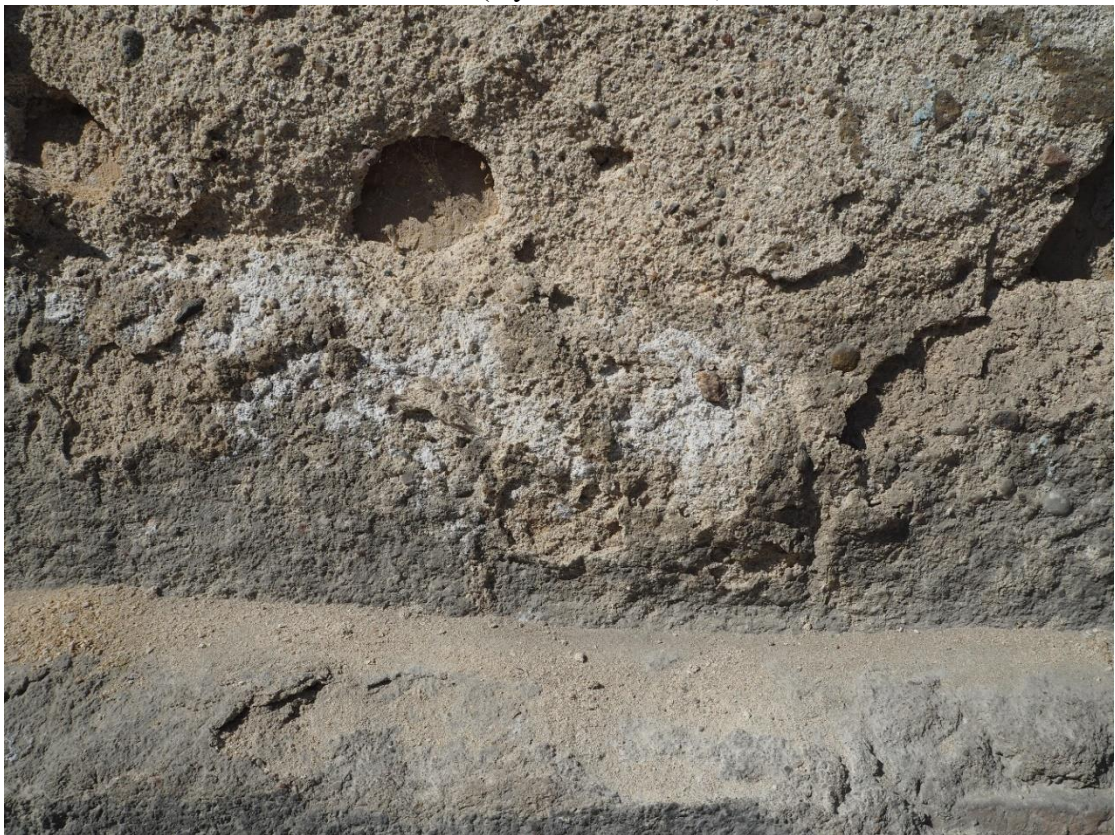
Fot.23. Gorzów Wlkp. ul. Wyszyńskiego 29, fasada, wysolenia na powierzchni tynków (wyk. P. Antoniuk).
