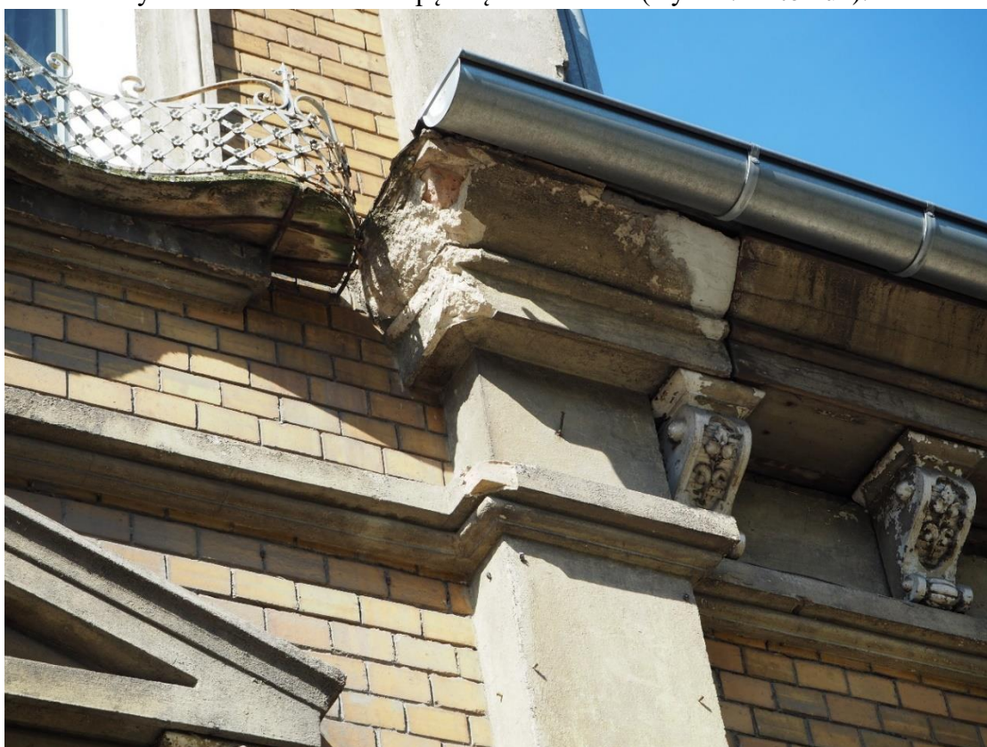
Fot.19. Gorzów Wlkp. ul. Wyszyńskiego 29, fasada, widoczne uszkodzenie kapitelu pilastra (wyk. P. Antoniuk).
