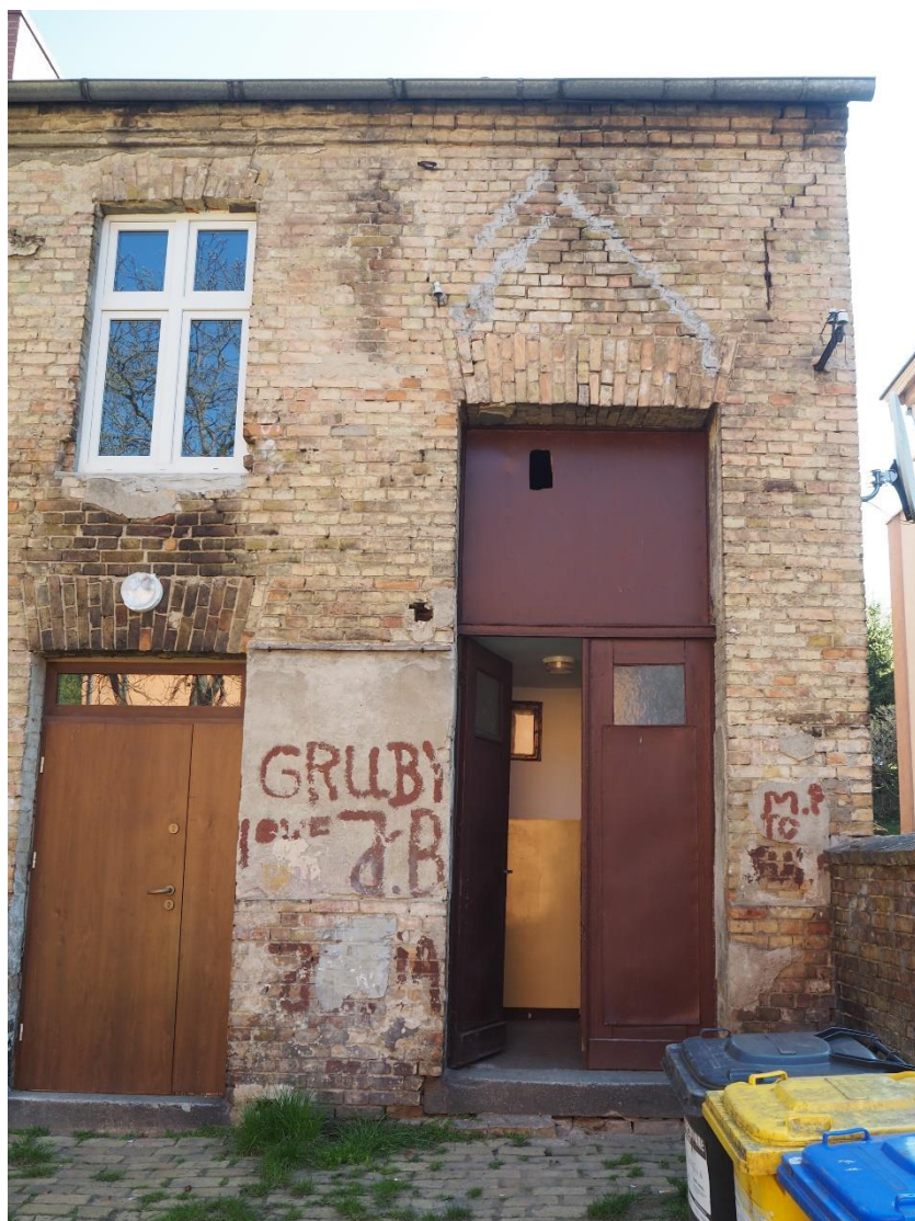
Fot.26. Gorzów Wlkp. ul. Wyszyńskiego 29, elewacja od podwórza, otwory drzwiowe, napisy, pęknięcia muru (wyk. P. Antoniuk).
