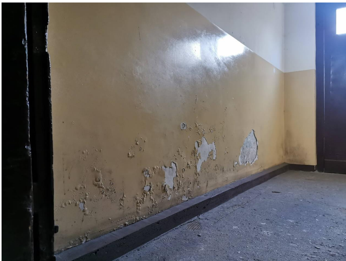
Fot.14. Gorzów Wlkp. ul. Wyszyńskiego 29, korytarz, efekt zawilgocenia oraz działania soli rozpuszczalnych w wodzie (wyk. P. Antoniuk).
