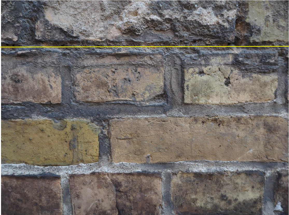
Fot.36. Gorzów Wlkp. ul. Wyszyńskiego 29, elewacja szczytowa, opracowana fuga poniżej izolacji poziomej, pozostałości tynku powyżej (wyk. P. Antoniuk).
