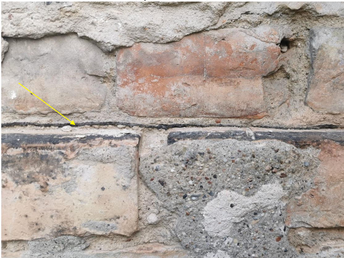
Fot.33. Gorzów Wlkp. ul. Wyszyńskiego 29, elewacja od podwórza, izolacja pozioma widoczna tuż nad cokołem, wtórne zaprawy (wyk. P. Antoniuk).
