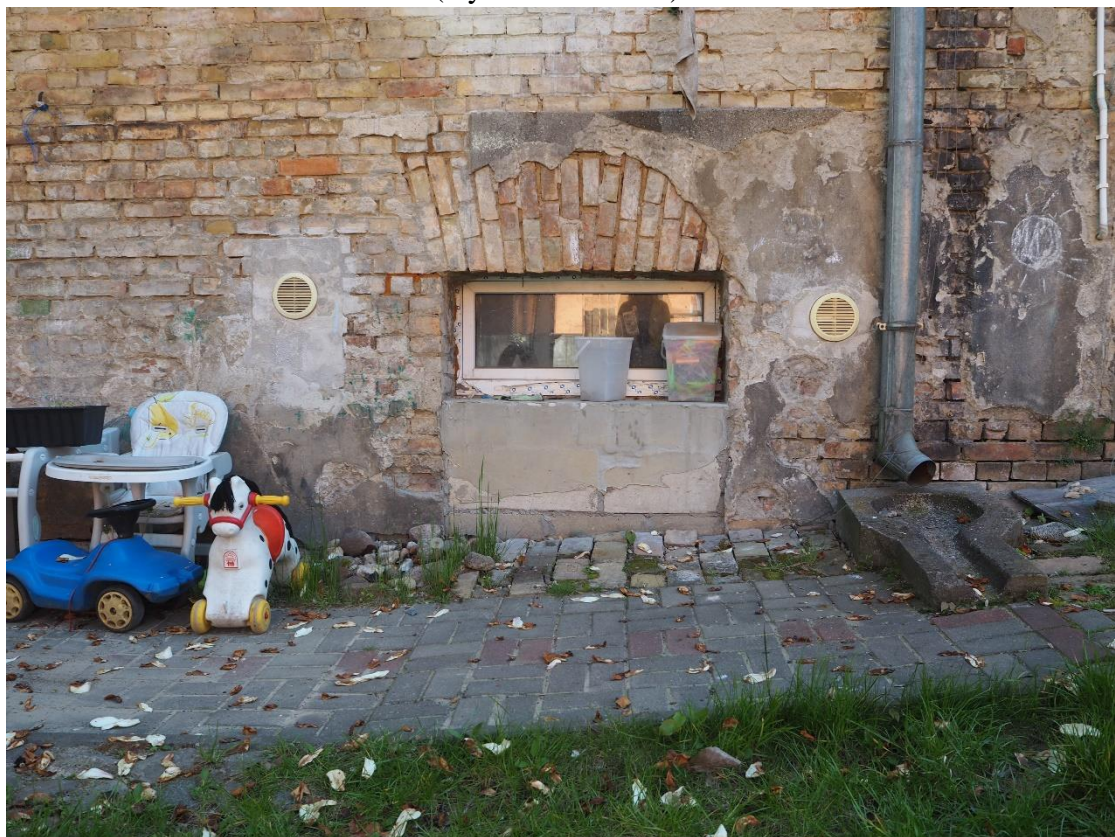
Fot.31. Gorzów Wlkp. ul. Wyszyńskiego 29, elewacja od podwórza, okienko ciepłowni, otwory wentylacyjne na różnych wysokościach, odpływ z rynny (wyk. P. Antoniuk).
