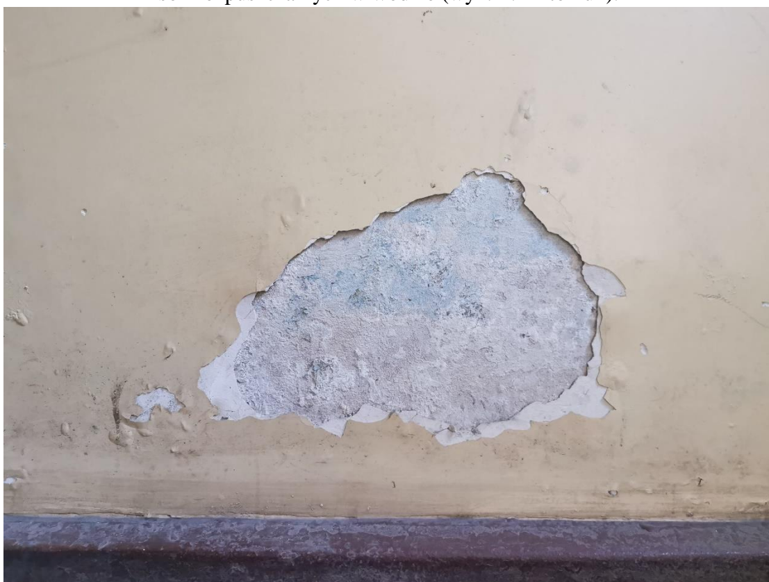
Fot.15. Gorzów Wlkp. ul. Wyszyńskiego 29, korytarz, odpadające współczesne warstwy gładzi gipsowych odsłaniające tynk (wyk. P. Antoniuk).
