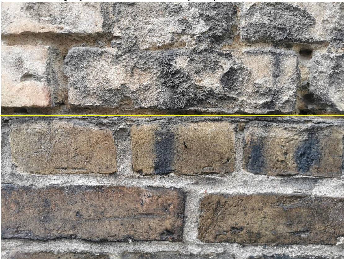
Fot.35. Gorzów Wlkp. ul. Wyszyńskiego 29, elewacja szczytowa, widoczne wyraźne odcięcie powierzchni tynkowanej i nietynkowanej, izolacja (wyk. P. Antoniuk).
