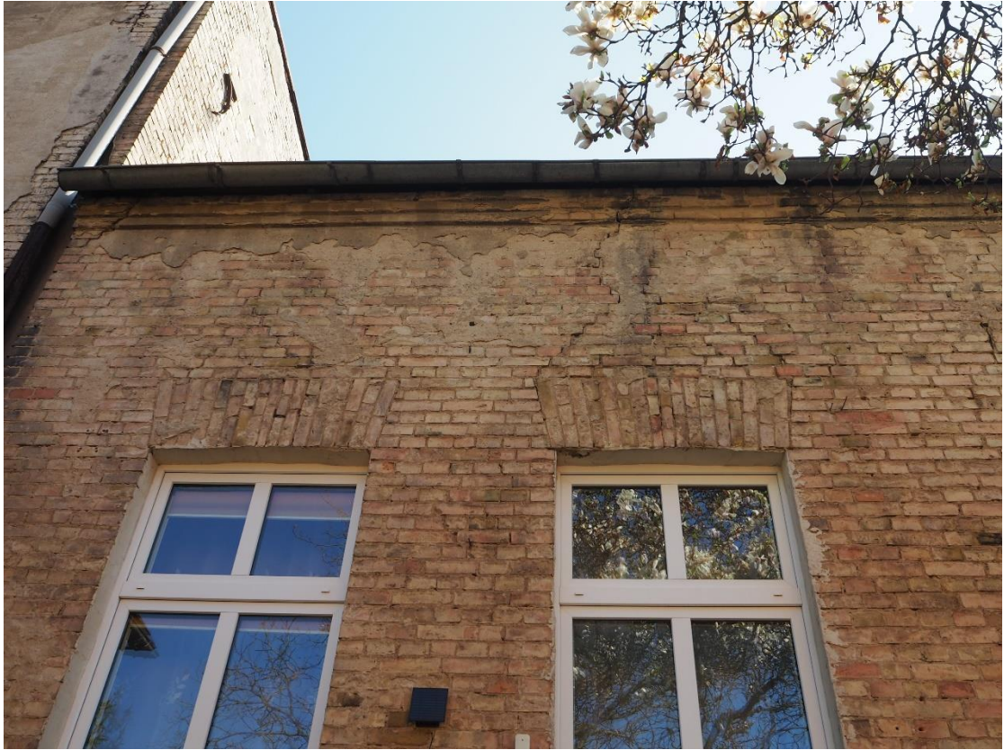
Fot.28. Gorzów Wlkp. ul. Wyszyńskiego 29, lewa część elewacji od podwórza, pęknięcia muru, zachowane częściowo tynki (wyk. P. Antoniuk).
