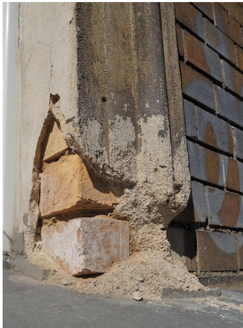
Fot.21. Gorzów Wlkp. ul. Wyszyńskiego 29, fasada, osypywanie tynku obramienia okna tuż nad parapetem (wyk. P. Antoniuk).
