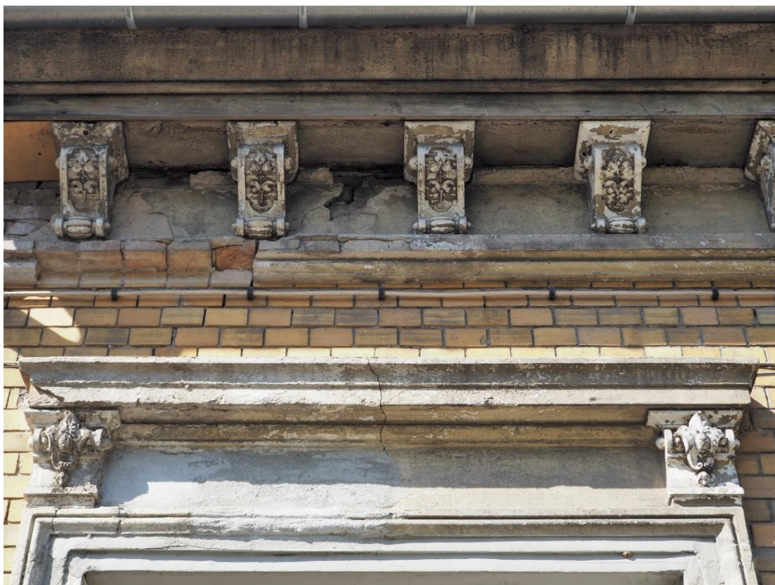
Fot.18. Gorzów Wlkp. ul. Wyszyńskiego 29, fasada, widoczne uszkodzenia gzymsów, tynku za konsolami oraz pęknięcie naczółka (wyk. P. Antoniuk).
