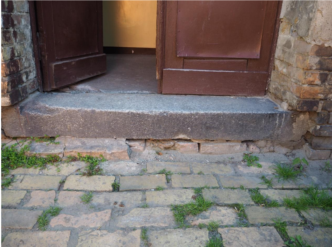
Fot.32. Gorzów Wlkp. ul. Wyszyńskiego 29, elewacja od podwórza, granitowy stopień (wyk. P. Antoniuk).
