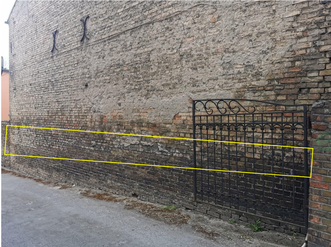
Fot.34. Gorzów Wlkp. ul. Wyszyńskiego 29, elewacja szczytowa, widoczne pozostałości po tynku w układzie schodkowym (wyk. P. Antoniuk).
