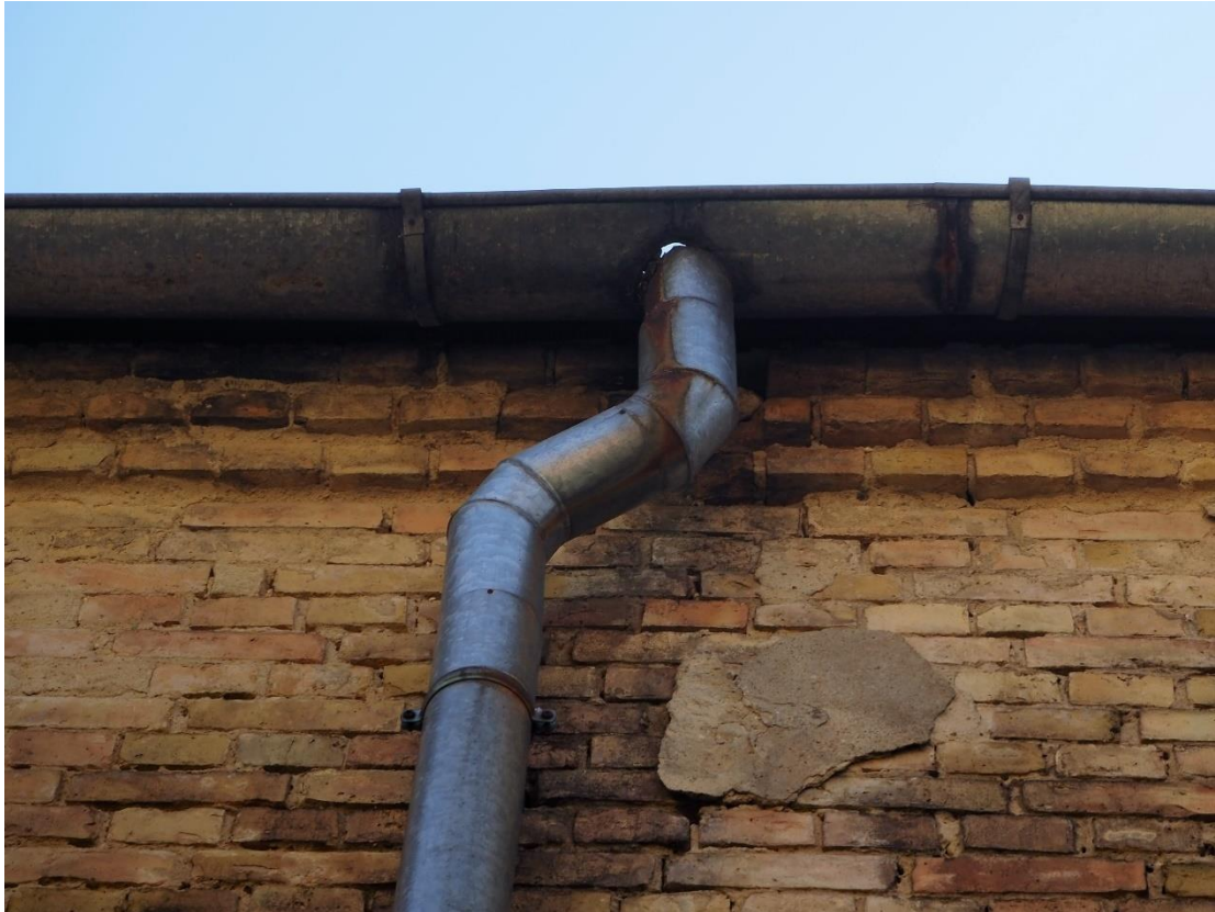
Fot.30. Gorzów Wlkp. ul. Wyszyńskiego 29, elewacja od podwórza, nieszczelność rynny (wyk. P. Antoniuk).
