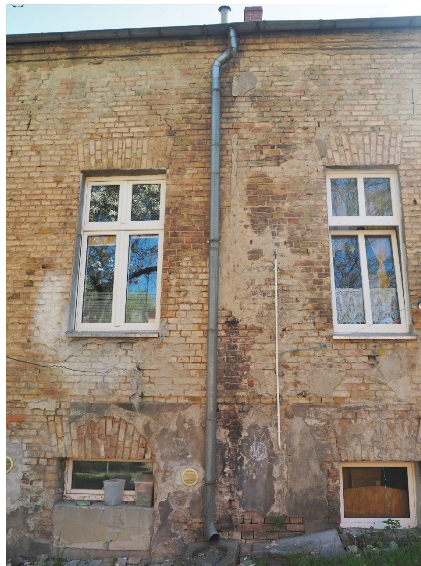
Fot.27. Gorzów Wlkp. ul. Wyszyńskiego 29, elewacja od podwórza, rynna, wtórne zaprawy, pęknięcia muru (wyk. P. Antoniuk).
