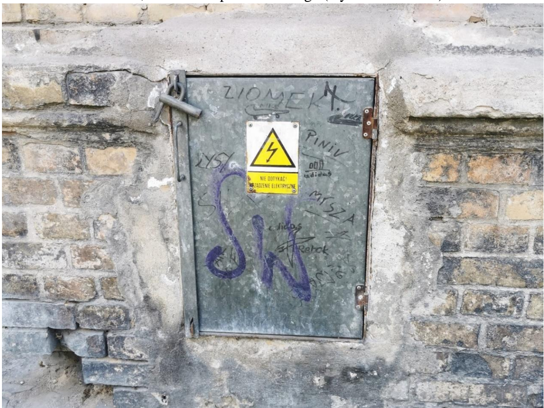
Fot.25. Gorzów Wlkp. ul. Wyszyńskiego 29, fasada, nieestetyczny i inwazyjny montaż skrzynki elektrycznej (wyk. P. Antoniuk).
