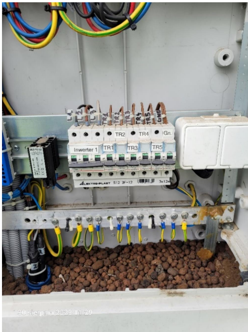
Rysunek 25 - aparatura zabezpieczeniowa AC w złączach RDC
