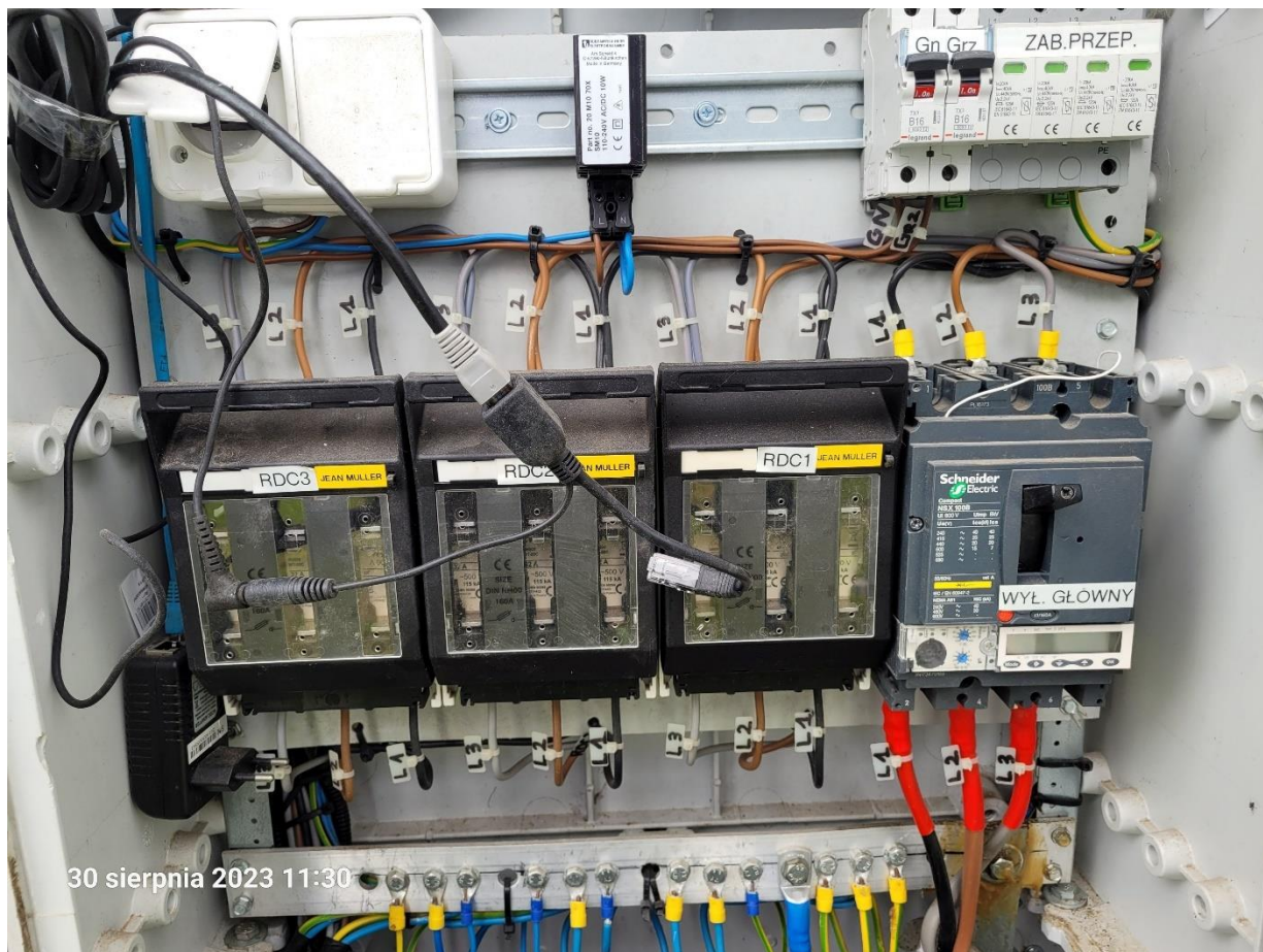
Rysunek 26 - Aparatura zabezpieczeniowa w rozdzielni RF
