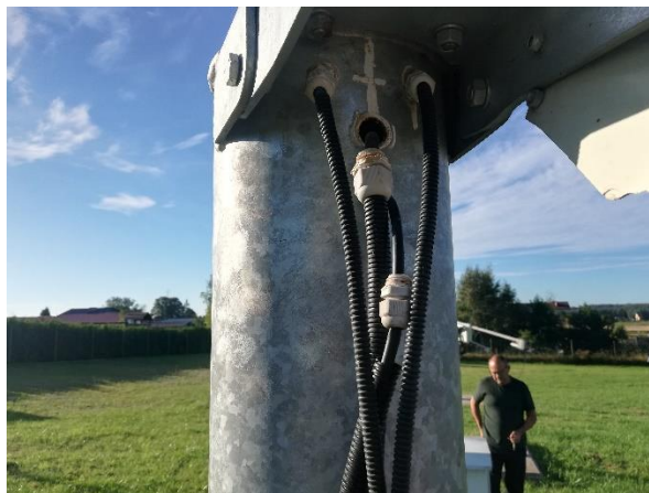
Rysunek 21 - pozrywane dławnice kablowe i rury ochronne
