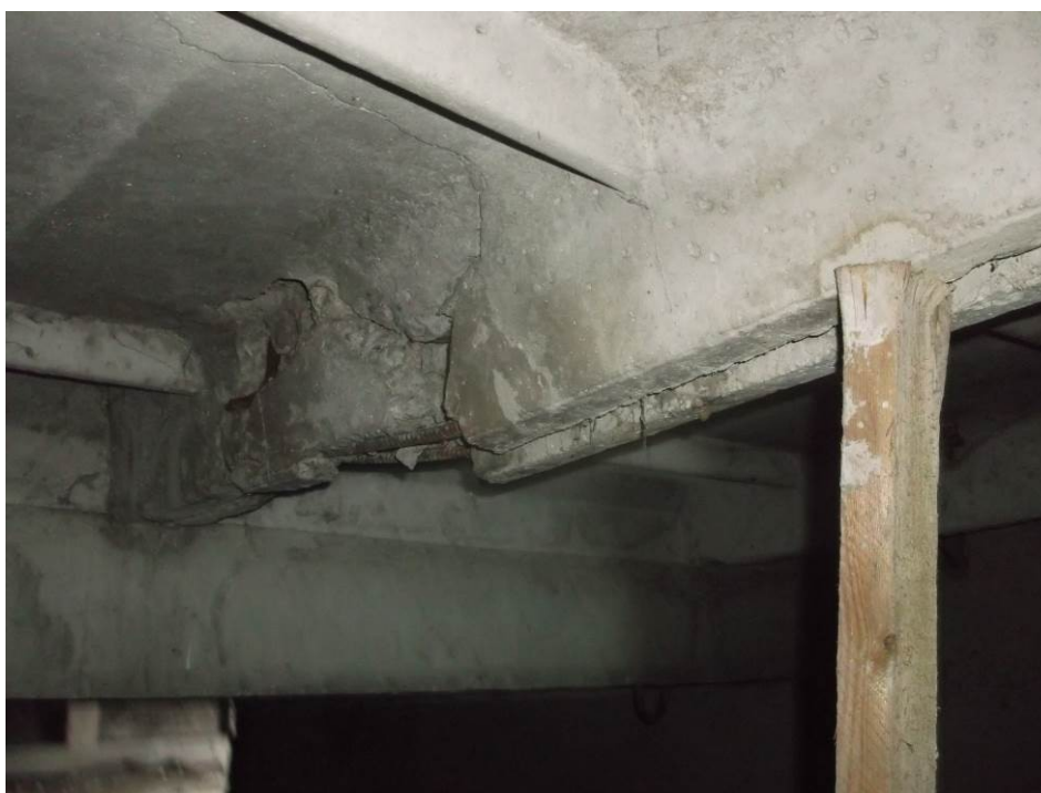
FOT. 10. Doraźne podparcie żebra uszkodzonej płyty drewnianym słupkiem o za małym przekroju
