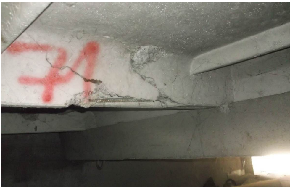
FOT. 6. Przykład uszkodzonej płyty w strefie podparcia na belce korytkowej
