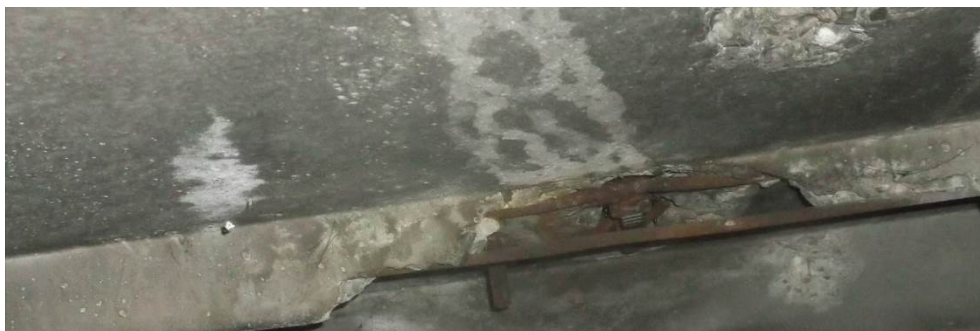
FOT. 8. Odsłonięte zbrojenie żeberka poprzecznego płyty – pręty \varnothing 6mm (stal A-I)
