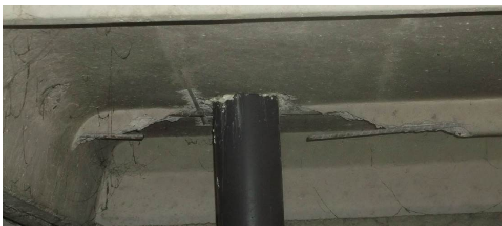
FOT. 7. Przebicie instalacyjne – uszkodzone żeberko wraz z rozciętym zbrojeniem
