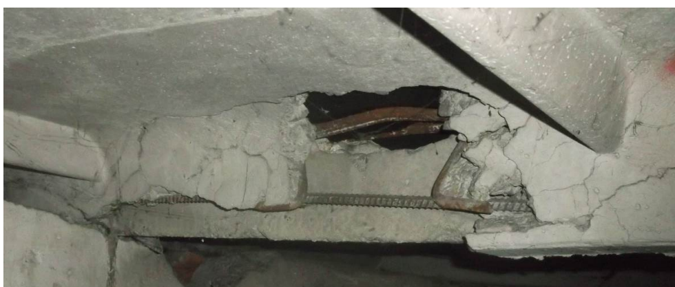
FOT. 9. Odsłonięte zbrojenie żebra głównego płyty – pręty \varnothing 12 mm dołem (A-III), hak montażowy \varnothing 12 mm oraz pręt górą \varnothing 10mm (A-I)
