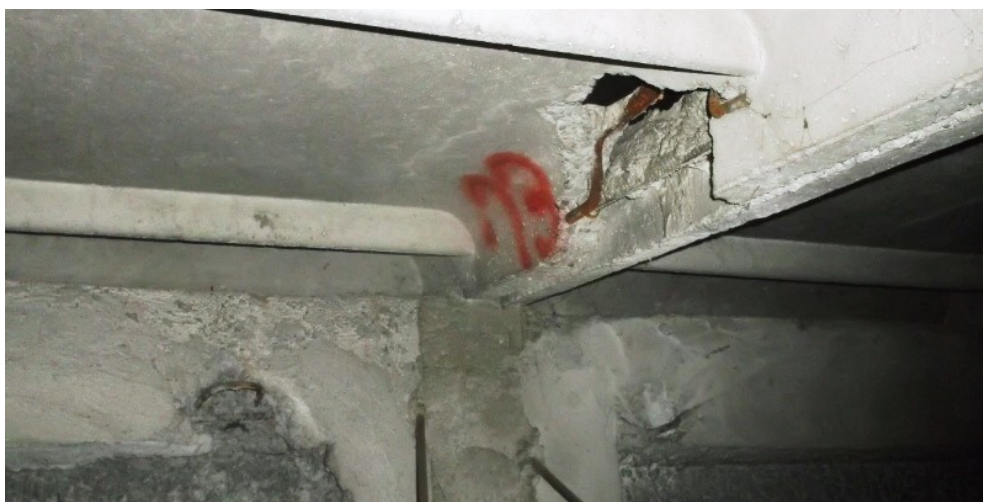
FOT. 5. Przykłady uszkodzeń w strefie podparcia na ścianie atykowej
