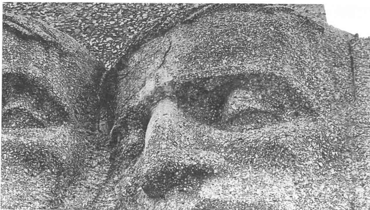
Fot. 1-3 . Mosina, Pomnik Powstańców Wielkopolskich – uszkodzenia zapraw, wtórna korona orła, na dolnym zdjęciu widoczne zróżnicowanie uziarnienia i tonacji barwnej lastryka.
