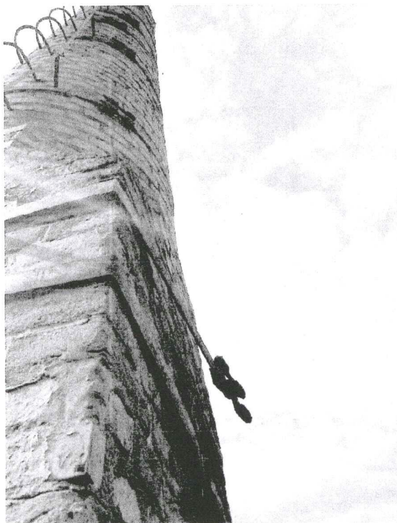
Fot. 7. Powierzchnia trzonu – widoczne uszkodzenia / pęknięta obręcz
