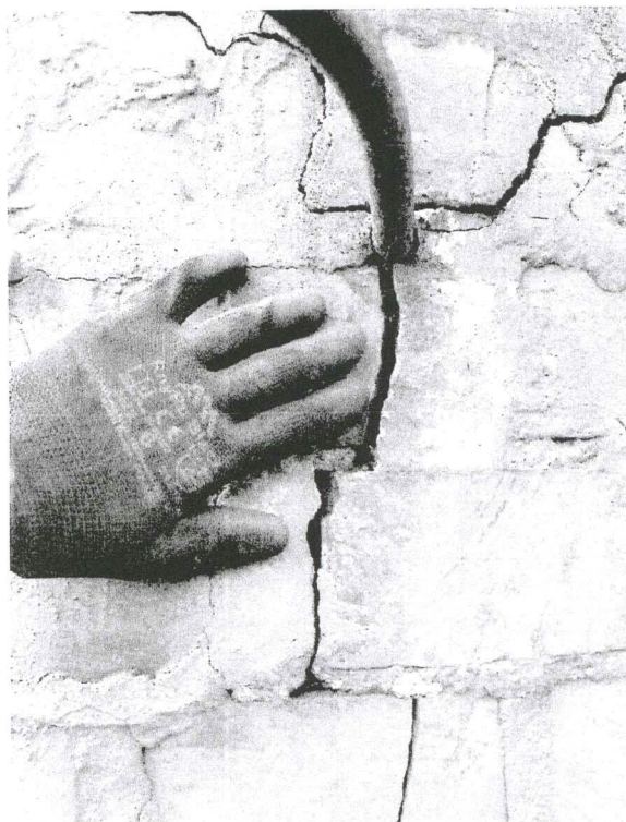
Fot. 15. Powierzchnia trzonu - różnokierunkowe pęknięcia
