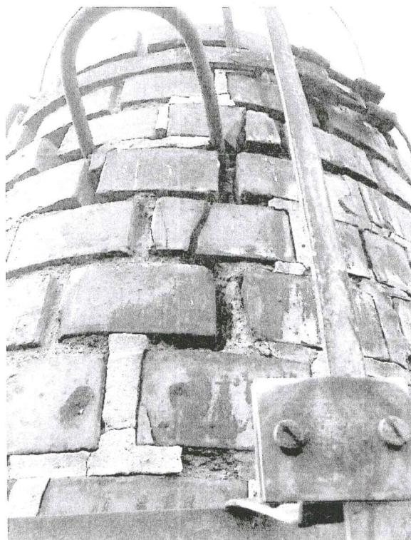
Fot. 18. Głowica komina - głębokie ubytki zaprawy w spoinowaniu
