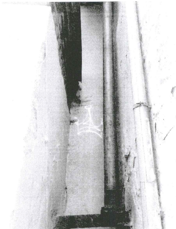
Fot. 3. Podstawa trzonu – uszkodzenia powierzchni
