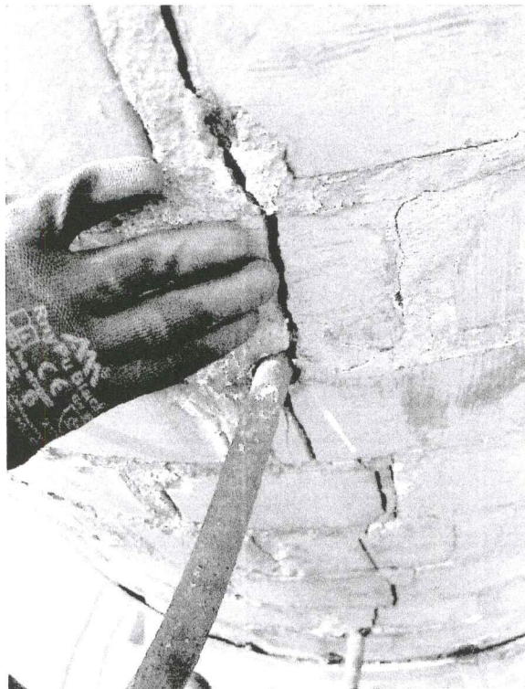
Fot. 14. Powierzchnia trzonu - różnokierunkowe pęknięcia
