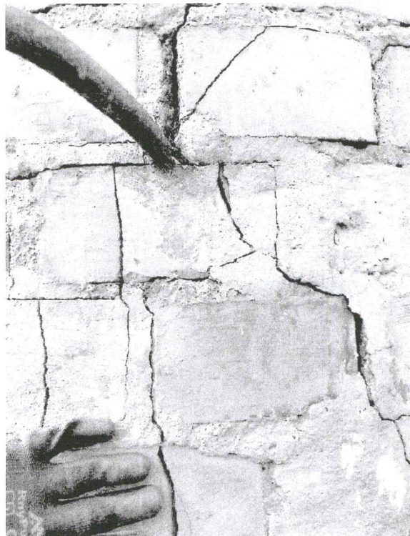
Fot. 13. Powierzchnia trzonu - różnokierunkowe pęknięcia
