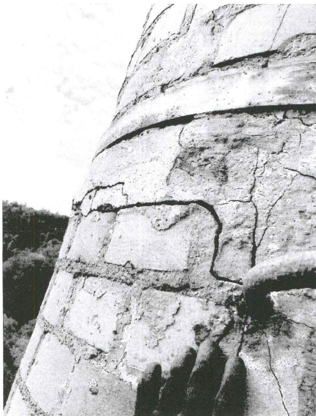
Fot. 16. Powierzchnia trzonu - różnokierunkowe pęknięcia
