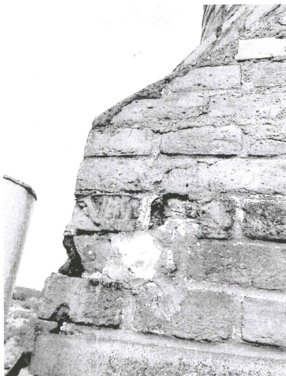
Fot. 5. Powierzchnia trzonu – drobne uszkodzenia / ubytki cegieł
