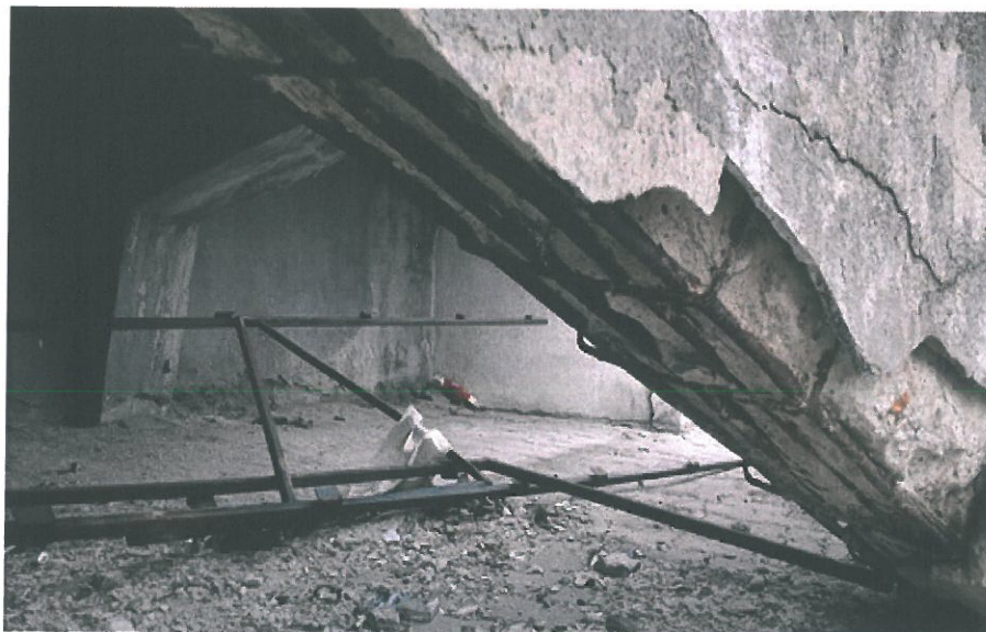
Zdj. nr 8. Ubytki w konstrukcji rampy rozładunkowej.
