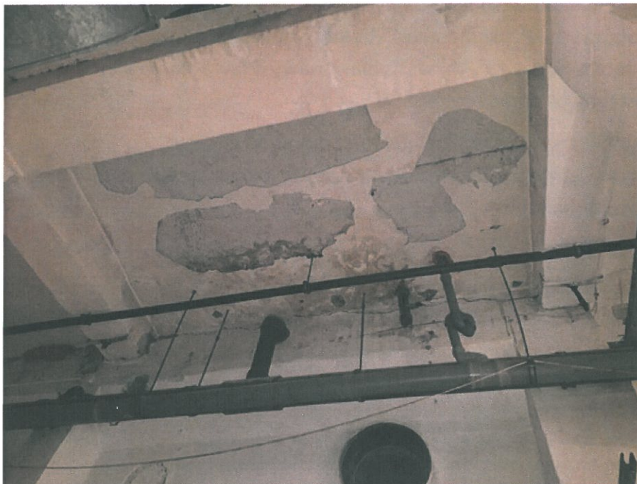
Zdj. nr 1. Odspojenia tynku od stropu.
