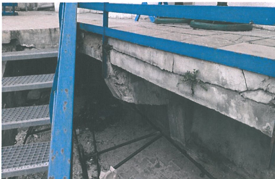
Zdj. nr 7. Ubytki w konstrukcji rampy rozładunkowej.
