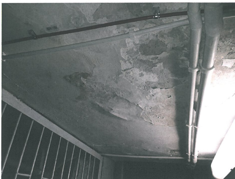
Zdj. nr 2. Zawilgocenia stropu.
