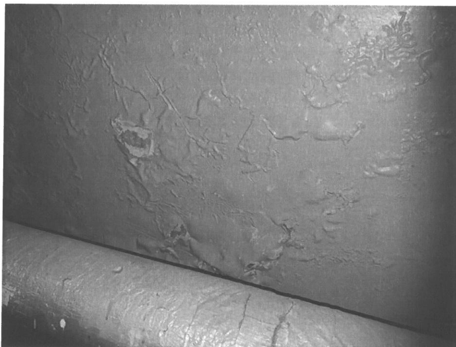
Zdj. nr 3. Zawilgocenia ściany.
