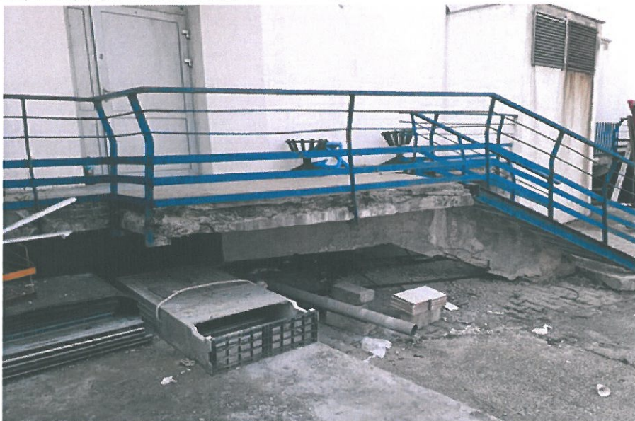
Zdj. nr 6. Ubytki w konstrukcji rampy rozładunkowej.
