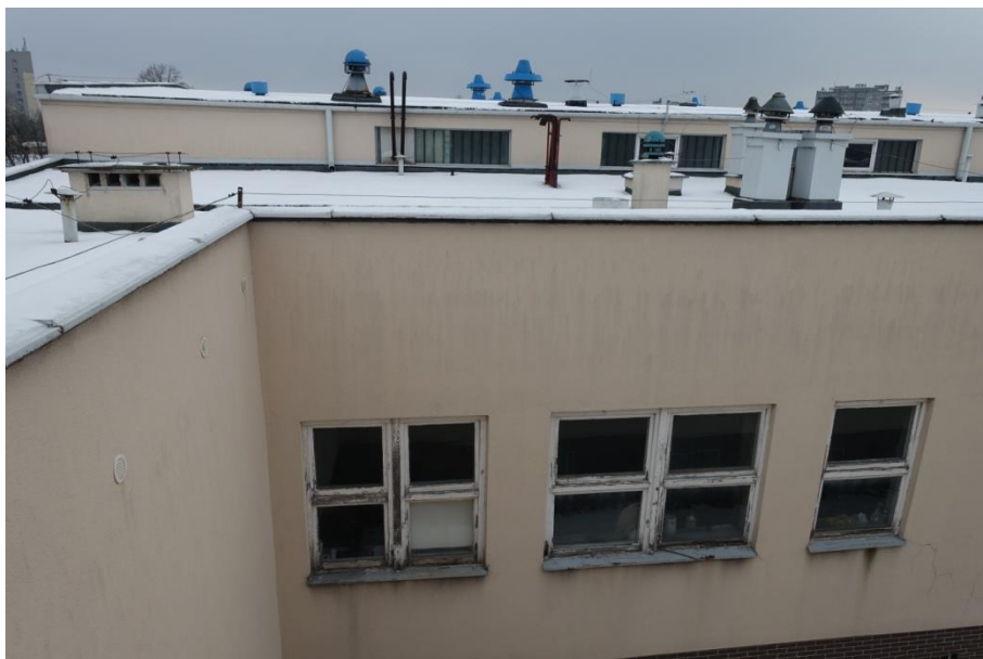
Fot. 8. Wyeksploatowana stolarka okienna na elewacji zachodniej
