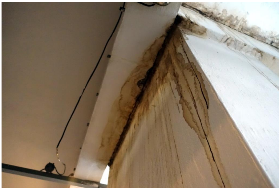
Fot. 4. Miejsce zalewania wodą stropu nad piwnicą wodą z nieszczelnych instalacji
