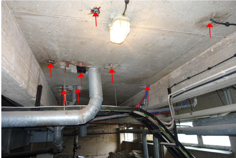
Fot. 3. Wtórnie wykonane przekucia instalacyjne w stropie nad piwnicą (oznaczono strzałkami)
