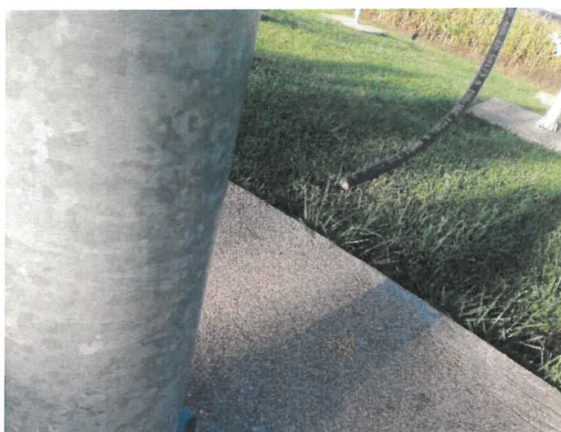
Rysunek 23 - luźno wiszący zerwany przewód DC
