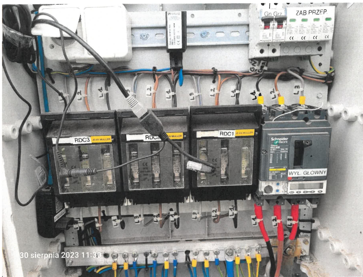
Rysunek 26 - Aparatura zabezpieczeniowa w rozdzielni RF
