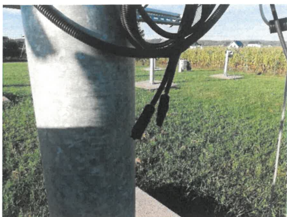
Rysunek 20 - uszkodzone, luźno wiszące złączki MC4 narażone na działanie czynników atmosferycznych
