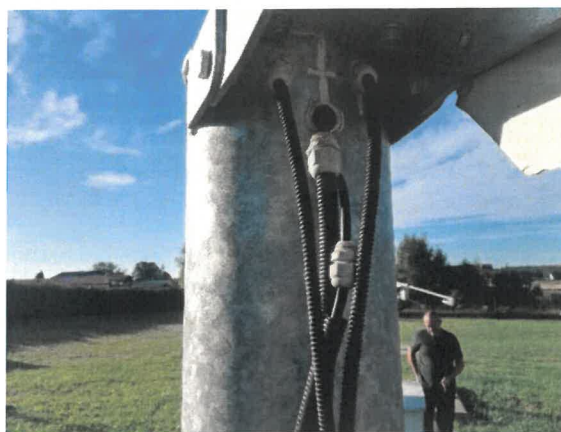
Rysunek 21 - pozrywane dławnice kablowe i rury ochronne
