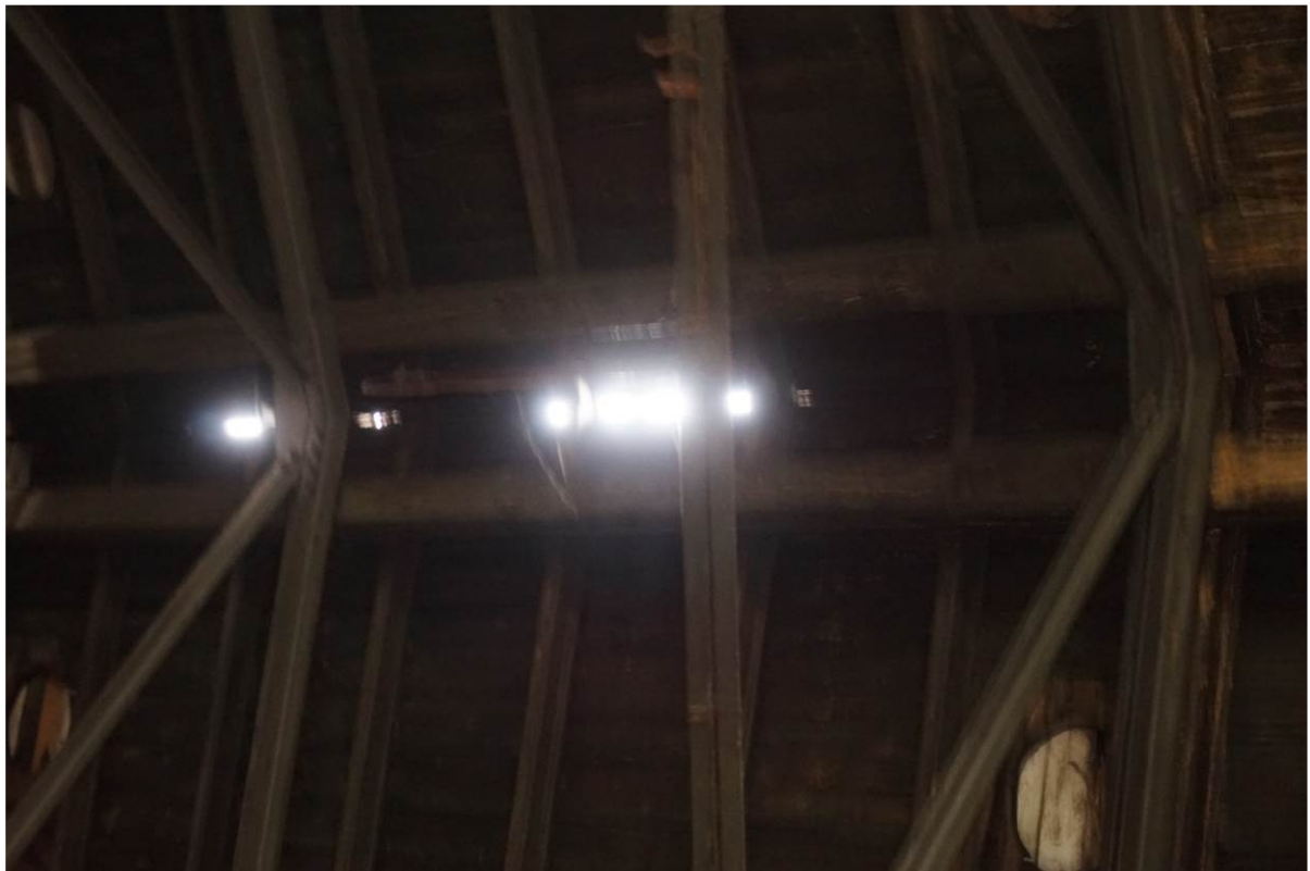
zdz. 3. Dziury w pokryciu w kalenicy.
