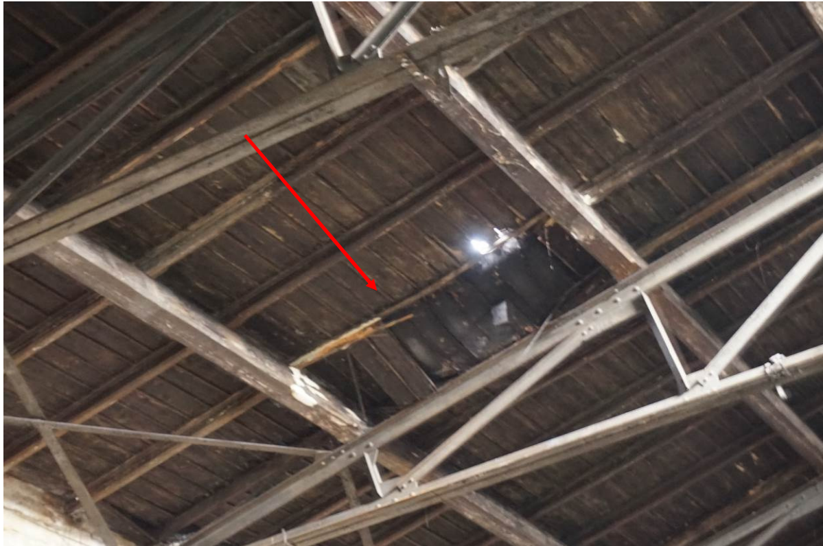
zdj. 5. Zniszczone belki nośne pokrycia dachu i zapadnięte deskowanie.
