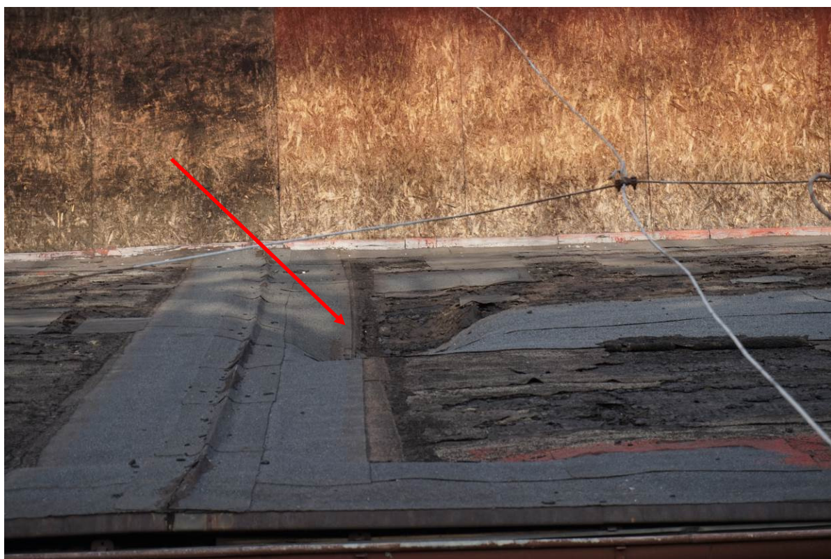
zdj. 7,8. Lej w pokryciu powstały w wyniku przegnicia deskowania pod papą i belek konstrukcyjnych pod deskowaniem. Miejsce niestabilne konstrukcyjnie grozi zawaleniem pod obciążeniem śniegiem.
