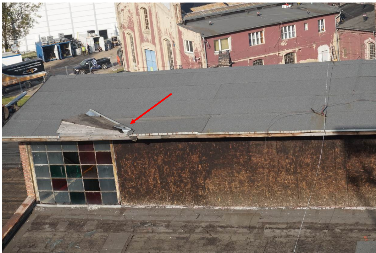
zdj.13. Dach świetlika - uszkodzona obróbka i częściowo pokrycie.
