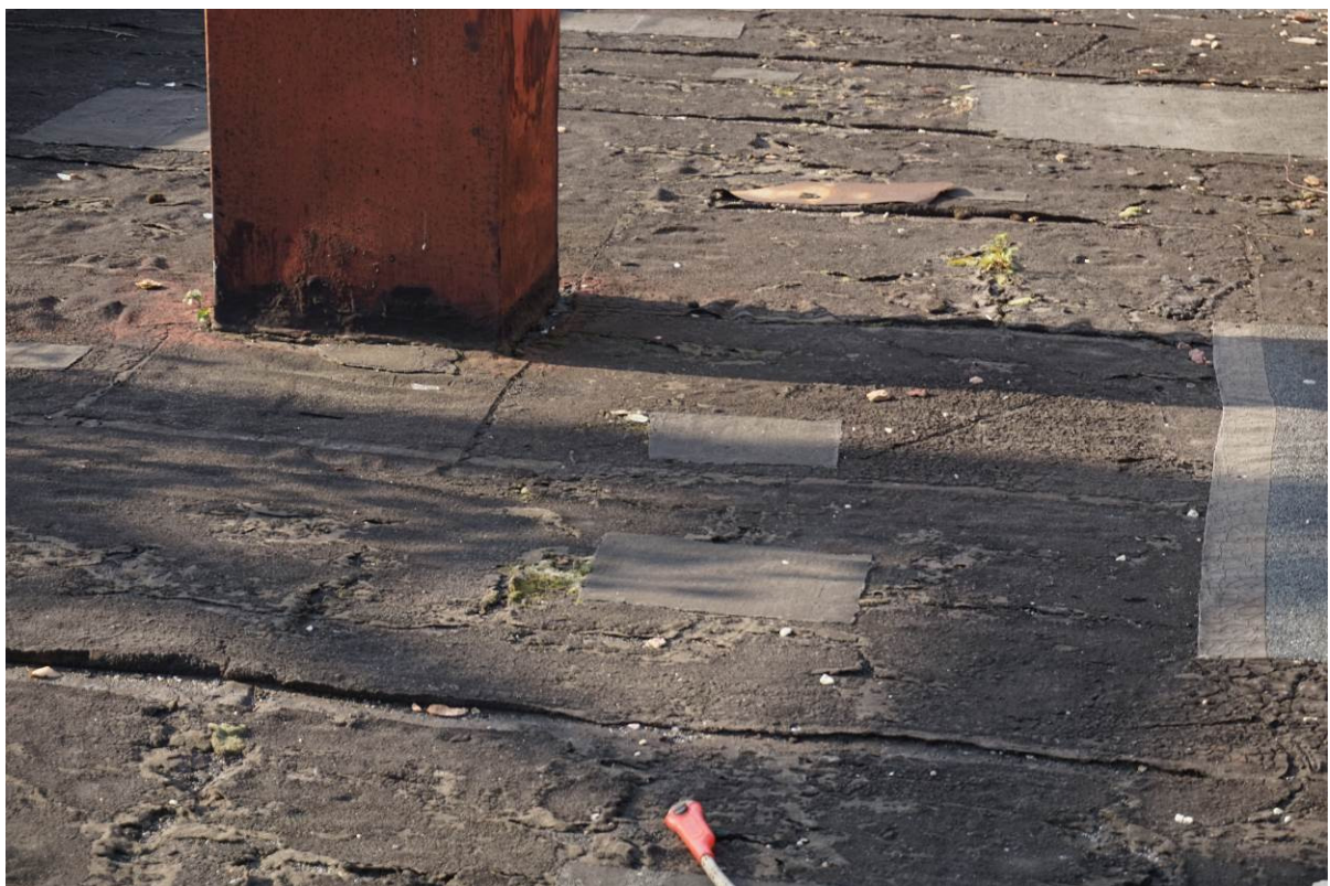
zdj.16, 17. Miejscowe uszkodzenia pokrycia.
