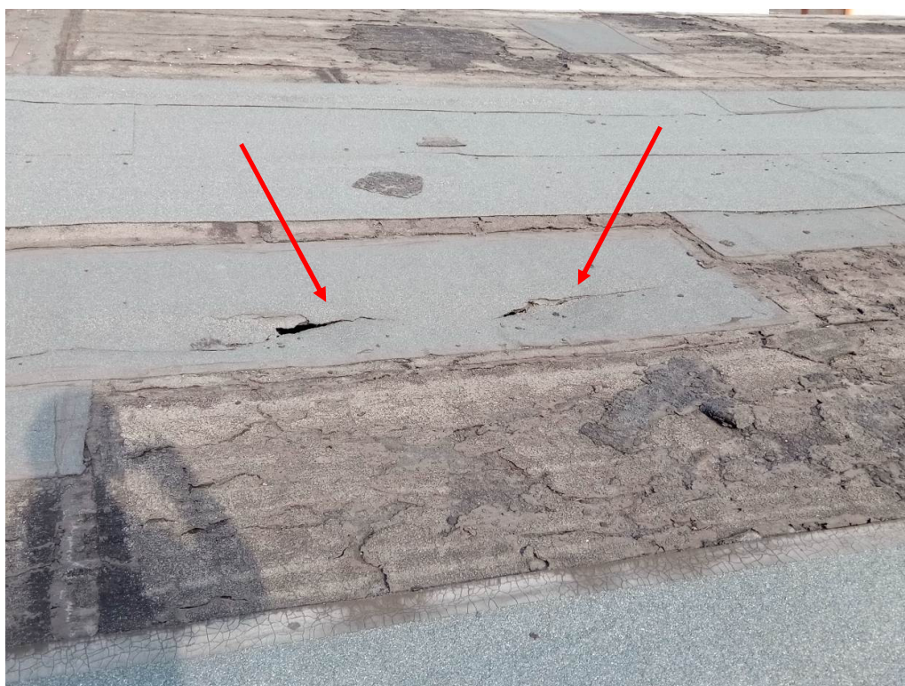
zdj.19. Uszkodzenie pokrycia w miejscu naprawy pokrycia papą termozgrzewalną.
