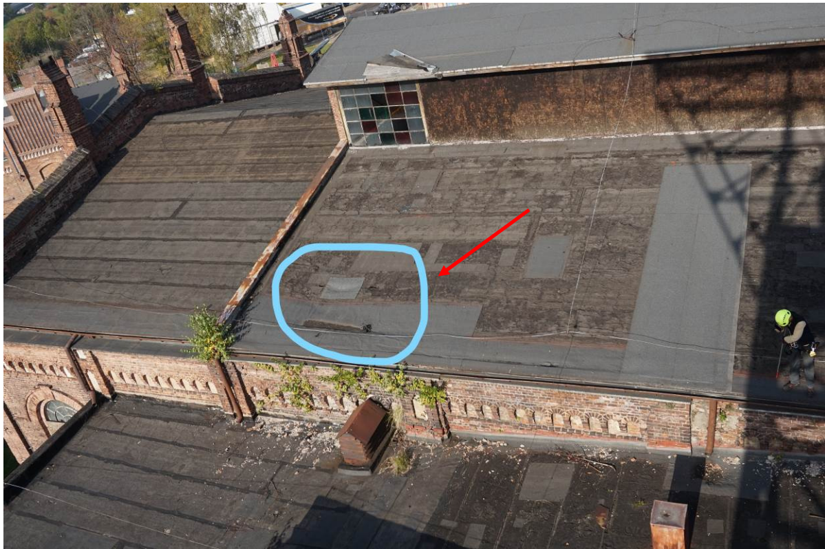
zdj.11. Drugi lej w pokryciu powstały w wyniku przegnięcia deskowania pod papą i belek konstrukcyjnych pod deskowaniem. Grozi zawaleniem pod obciążeniem śniegiem.
