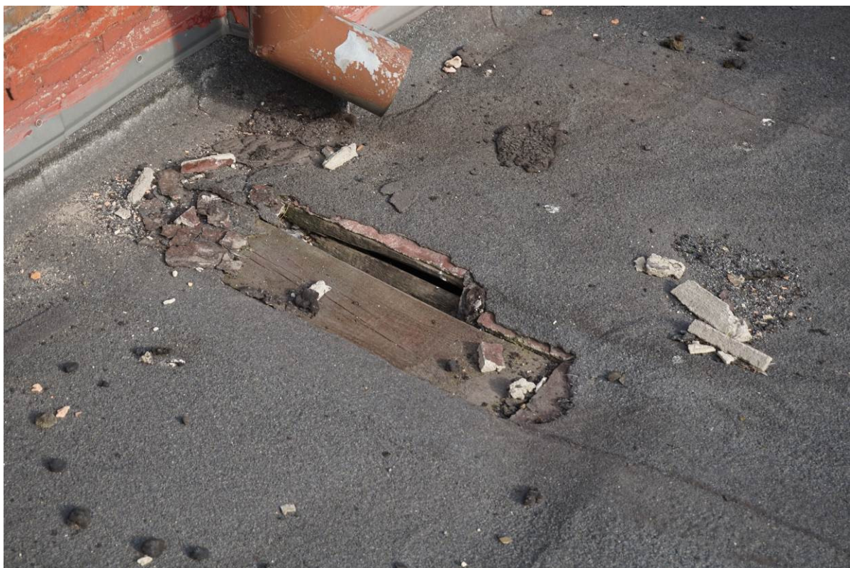
zdj. 6. Dziury w pokryciu dachu łącznika.
