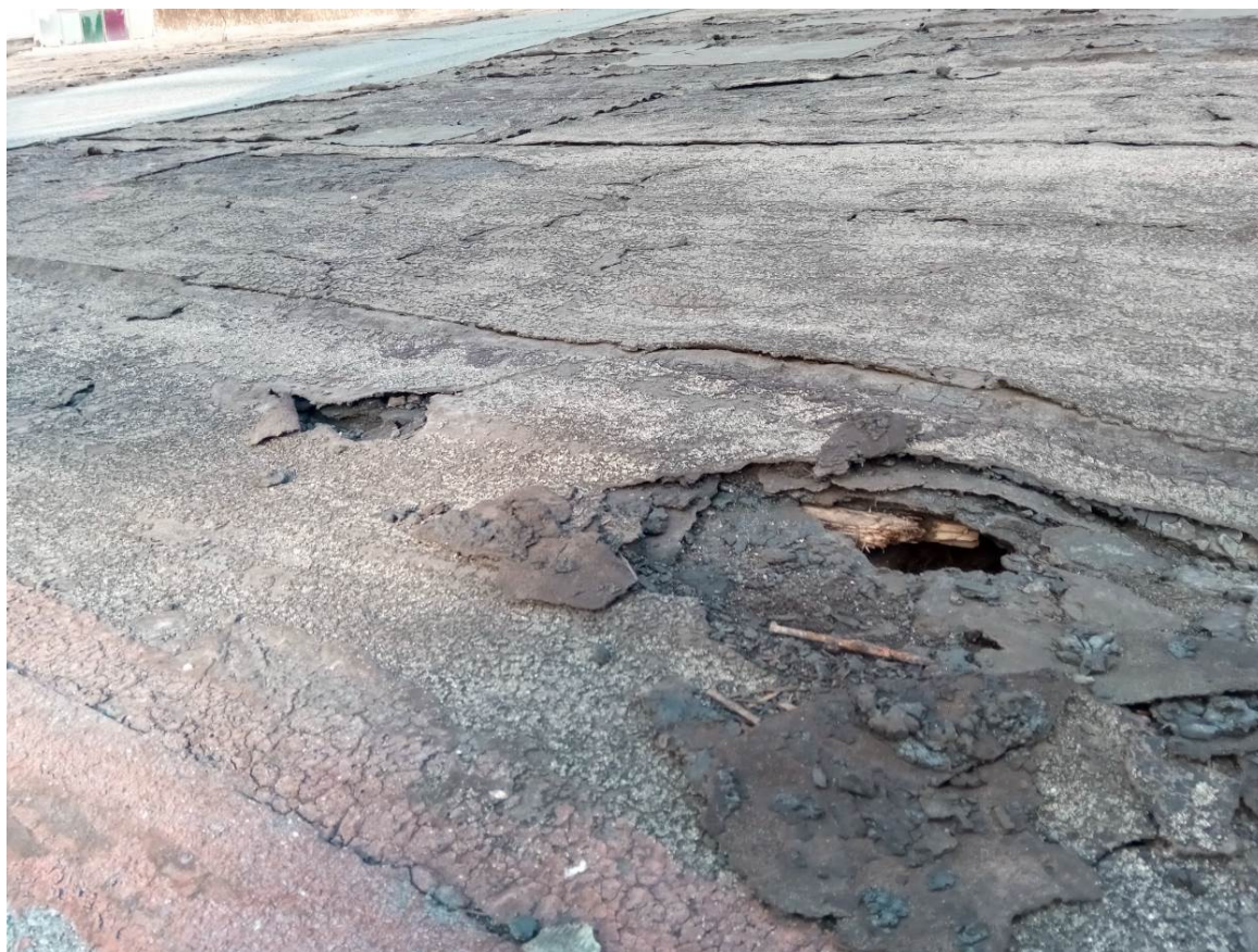
zdj.18. Miejscowe uszkodzenia pokrycia.
