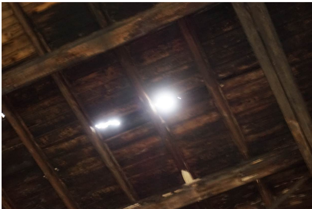
zdj. 2. Widoczne dziury w pokryciu.
