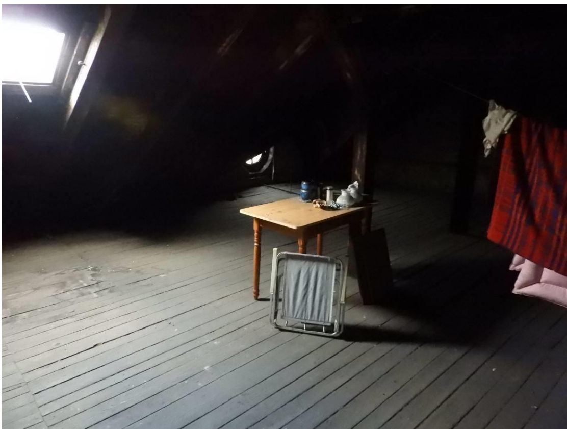
Fot. 13. Strych, brak śladów obecności nietoperzy.
