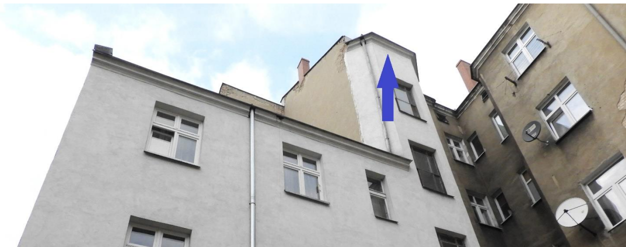
Fot.1. Działania kompensacyjne – proponowane miejsca powieszenia budek dla jerzyka. Strzałką zaznaczono miejsce pod krawędzią dachu na prawej klatce schodowej.
