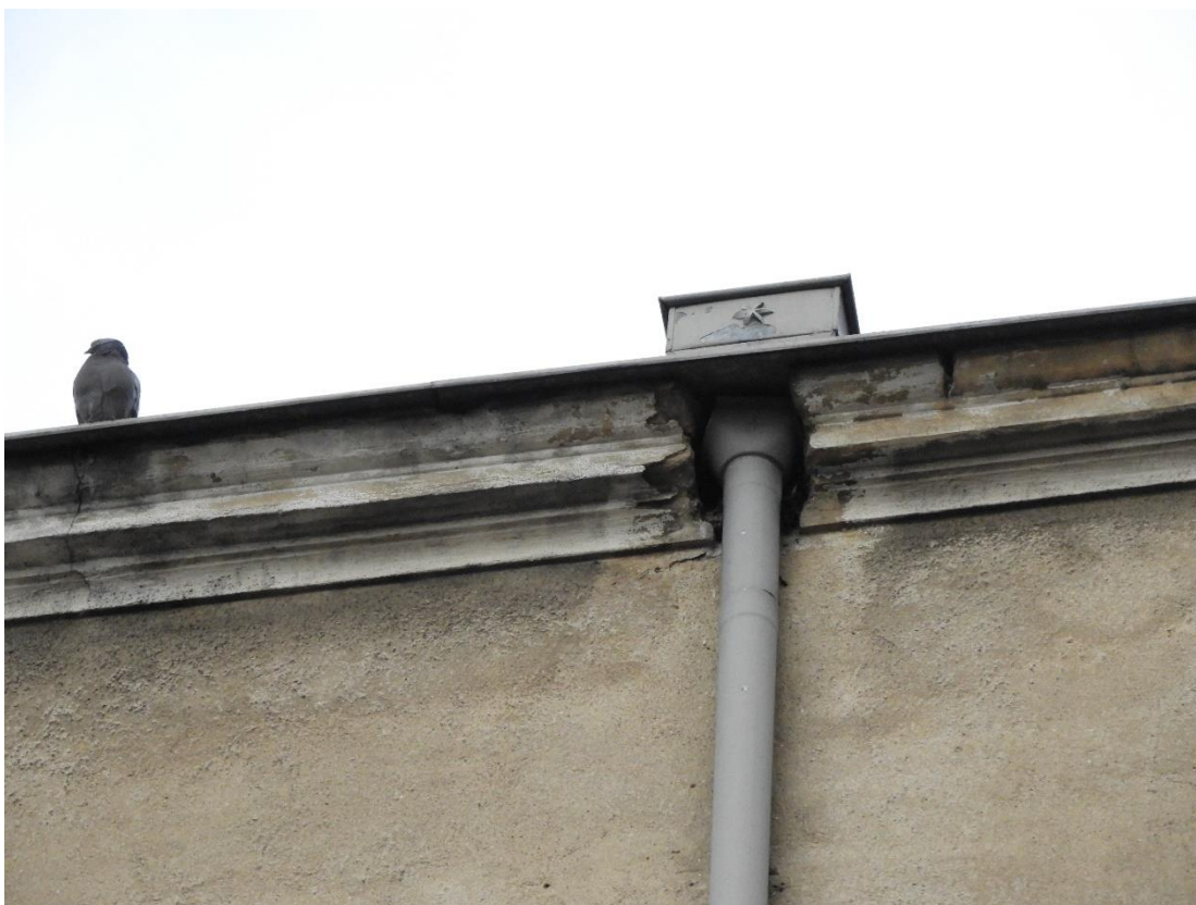
Fot. 9. Elewacja od podwórza – widoczne szczeliny za rynnami, na gzymsie gołąb miejski
