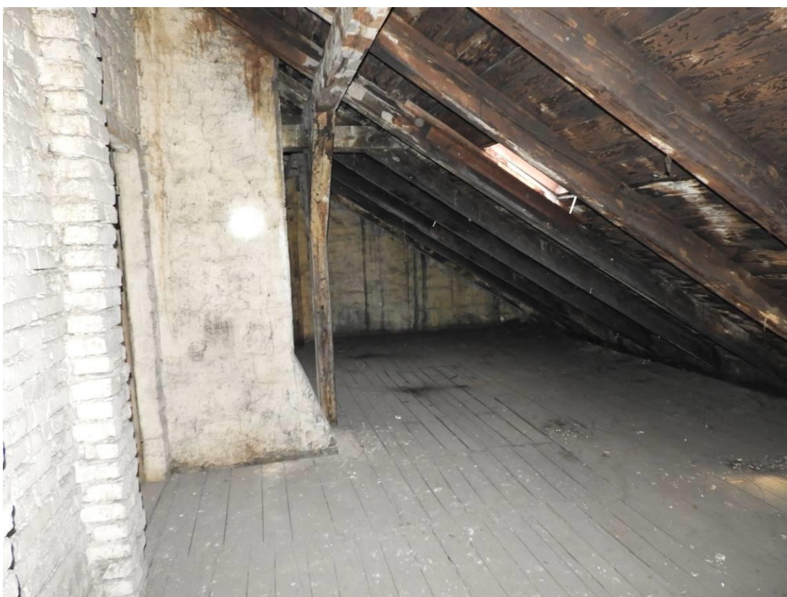
Fot. 14. Strych, brak śladów obecności nietoperzy.
