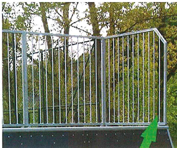
Zdjęcie 1. Ścięty kant barierki
