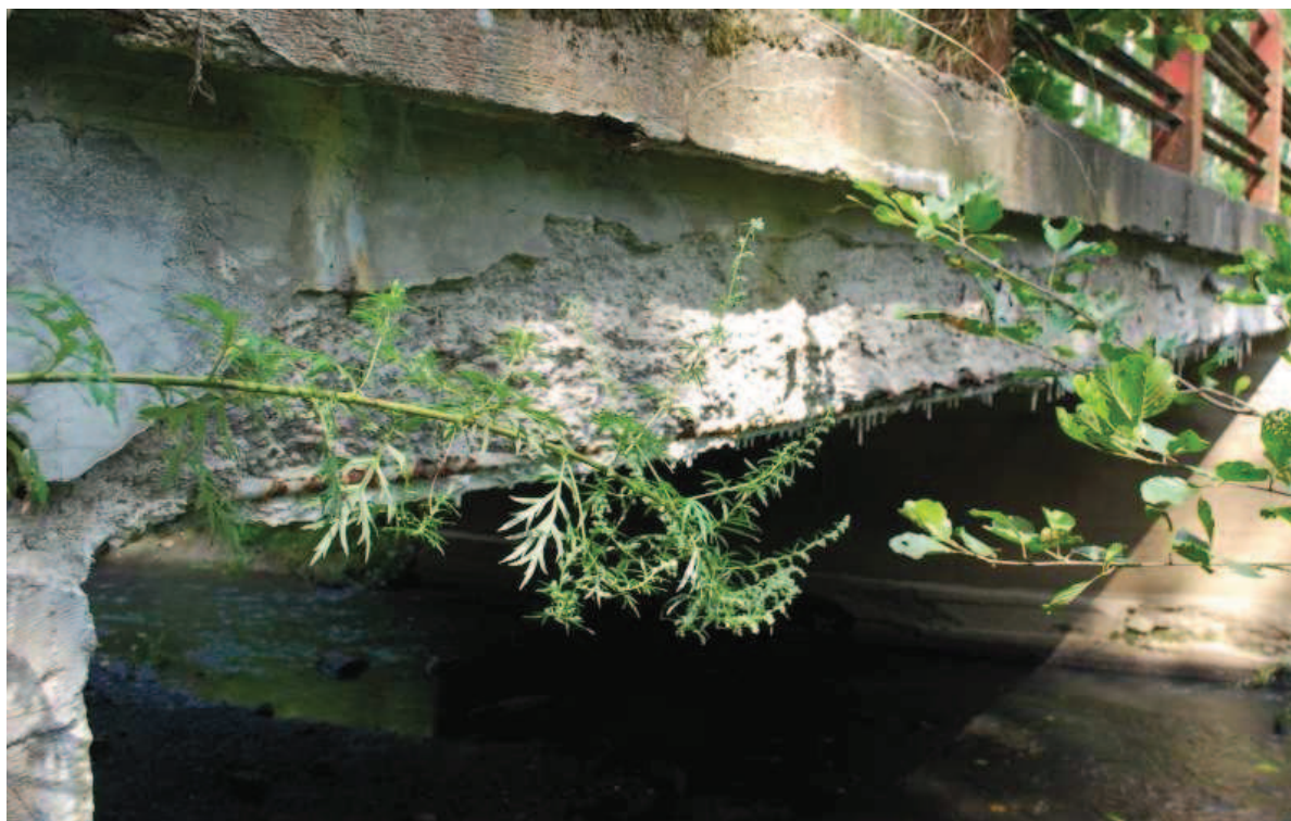
Fot. 3. Widok na konstrukcję od strony północnej. Widoczna korozja betonu oraz stali zbrojeniowej spowodowana niedostatecznym stanem izolacji pomostu.
