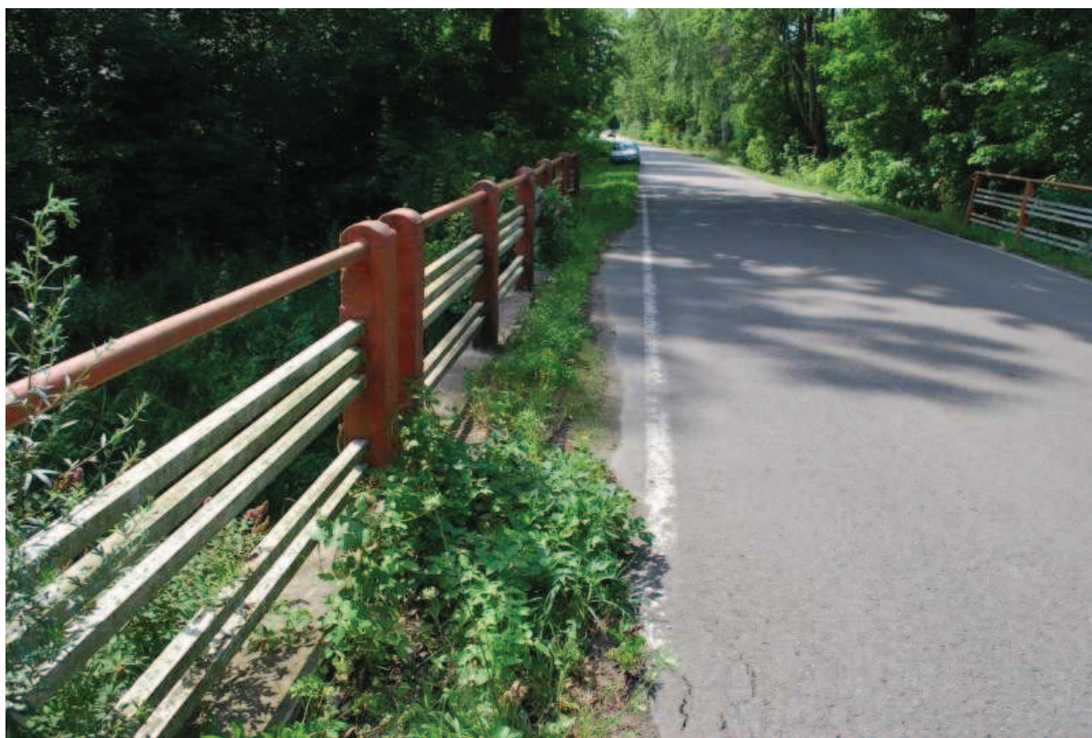
Fot. 14. Widok na intensywną wegetację roślinności po północnej stronie nawierzchni spowodowaną brakiem systematycznych prac utrzymaniowych.
