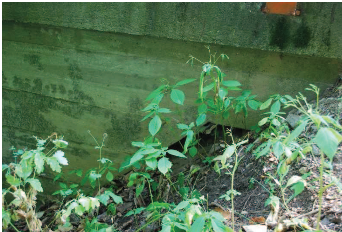
Fot. 11. Widok na skrzydło przyczółka wschodniego po stronie południowej. Odslonięta konstrukcja skrzydła wskazują na ubytek lub przemieszczenie terenu.
