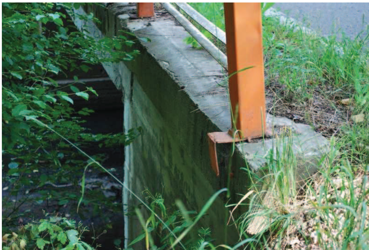
Fot. 12. Widok na gzyms przyczółka wschodniego od strony południowej. Widoczny brak połączenia podstawy słupka balustrady z belką gzymsową.
