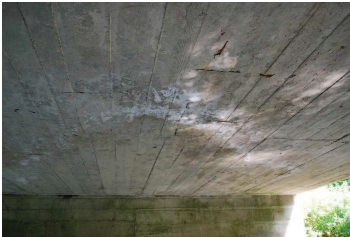
Fot. 5. Widok od spodu na konstrukcje pomostu w środku rozpiętości obiektu. Widoczne zacieki i osady wskazują na niedostateczny stan izolacji.
