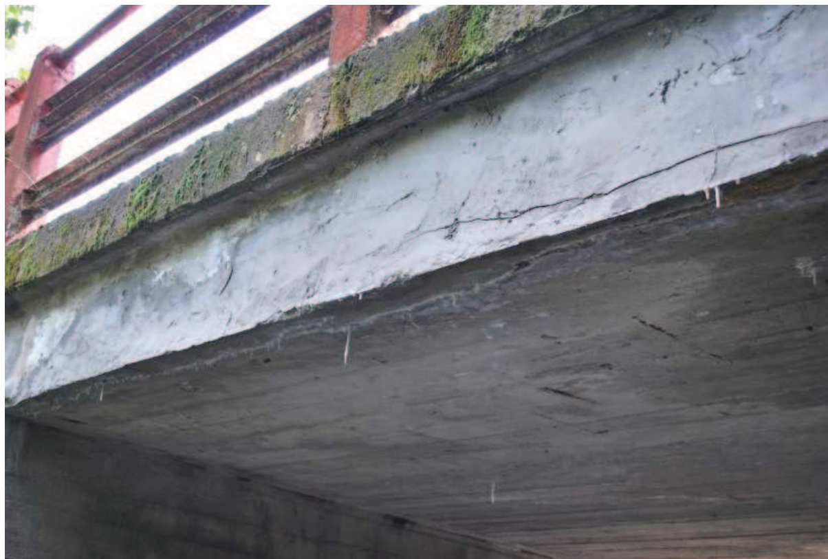
Fot. 7. Widok płyty pomostu od strony północnej. Widoczne rysy, zacieki i osady betony wskazują na niedostateczny stan izolacji pomostu.
