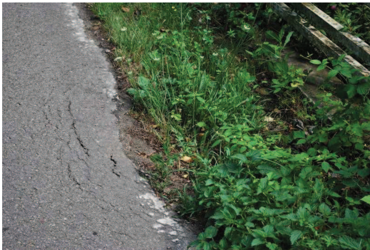
Fot. 17. Widok na deformację i rysy betonu na dojeździe po stronie północno – zachodniej spowodowane prawdopodobnie przemieszczeniem terenu.
