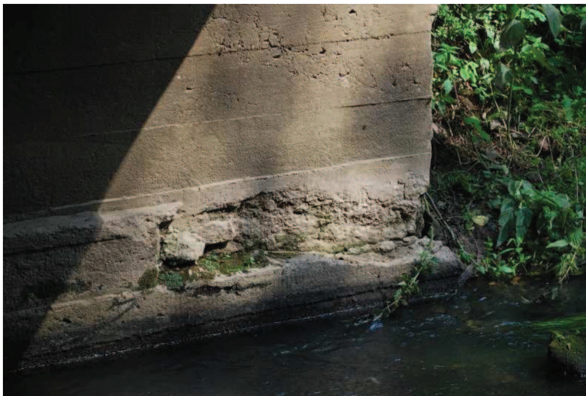
Fot. 8. Widok na ubytki betonu przyczółka zachodniego po stronie północnej.
