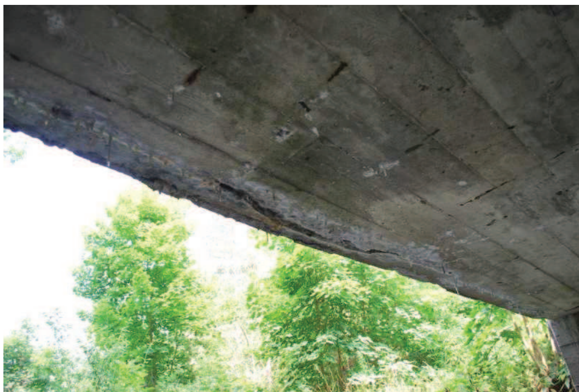
Fot. 4. Widok od spodu na konstrukcję pomostu po stronie północnej. Widoczne ubytki, cieki, osady i rysy betonu spowodowane niedostatecznym stanem izolacji pomostu.
