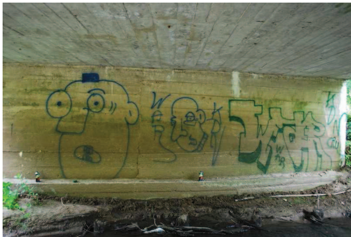
Fot. 10. Widok przyczółek wschodni. Widoczne zanieczyszczenia grafitti.
