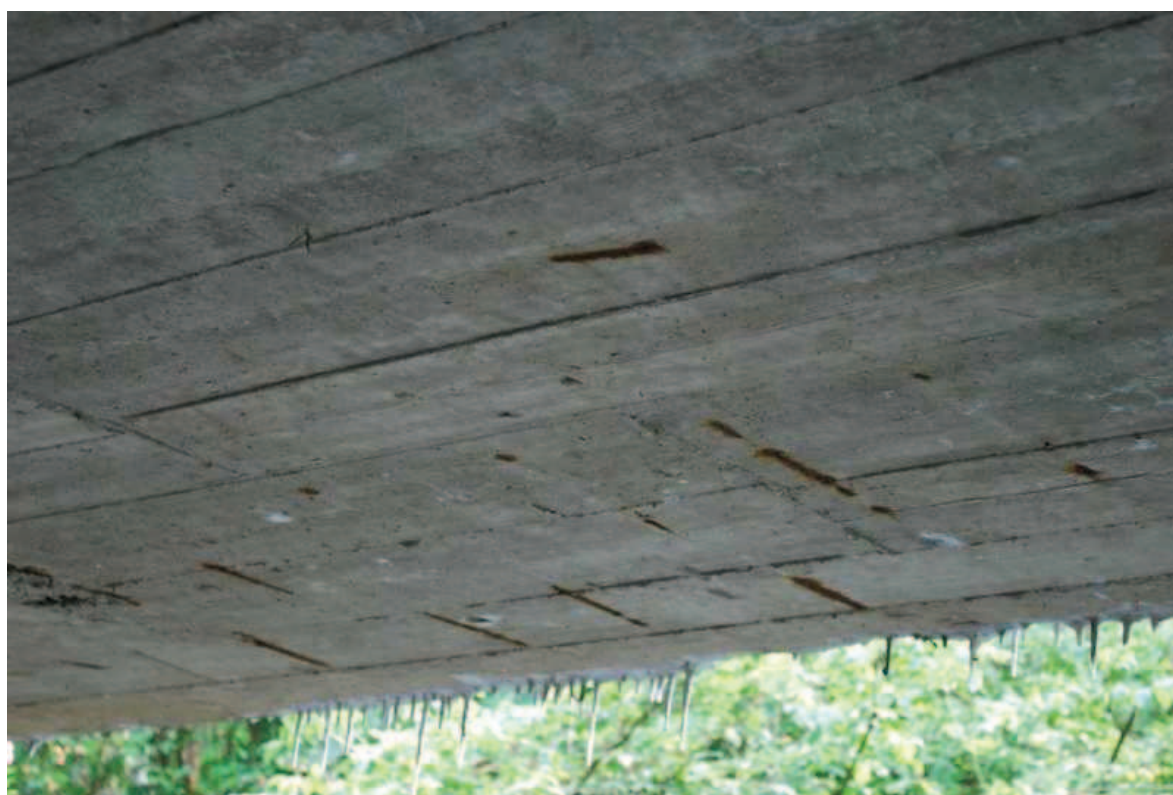
Fot. 6. Widok na konstrukcję pomostu po stronie północnej. Widoczne ubytki betonu, korozja stali zbrojeniowej oraz osady, które wskazują na niedostateczny stan izolacji płyty.
