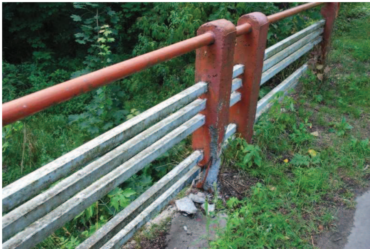
Fot. 15. Widok na słupek balustrady północnej. Widoczny ubytek betonu oraz korozja stali zbrojeniowej.
