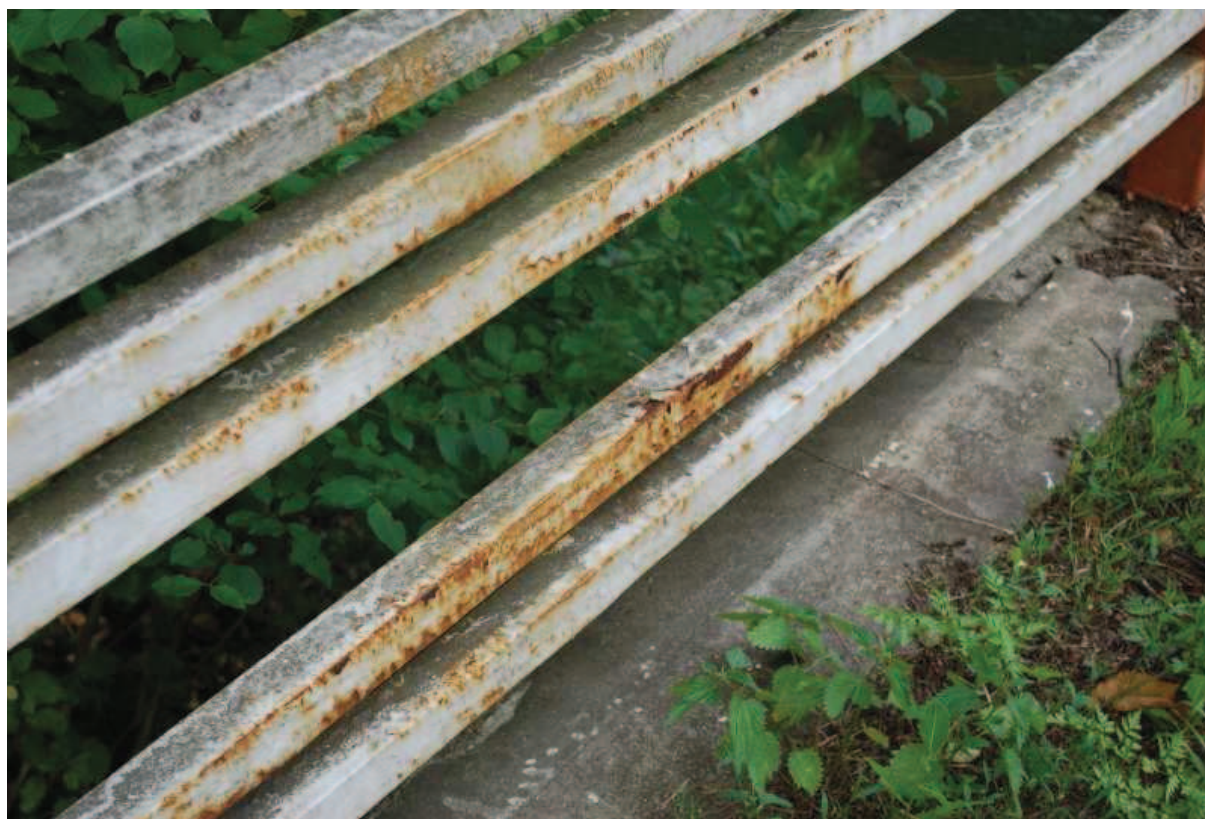
Fot. 16. Widok na przecięgi balustrady południowej. Widoczne zanieczyszczenie oraz korozja stali wskazują na brak wykonywania systematycznych prac utrzymaniowych.
