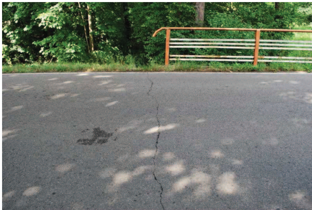
Fot. 18. Widok na strefę dylatacji po stronie wschodniej. Widoczne rysy asfaltu..
