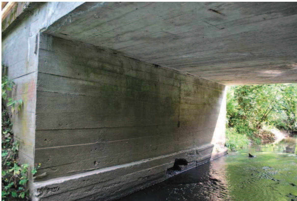
Fot. 9. Widok na przyczółek zachodni. Widoczny ubytek betonu.
