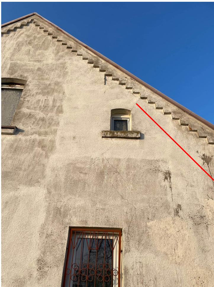
Zarysowanie na elewacji wschodniej
