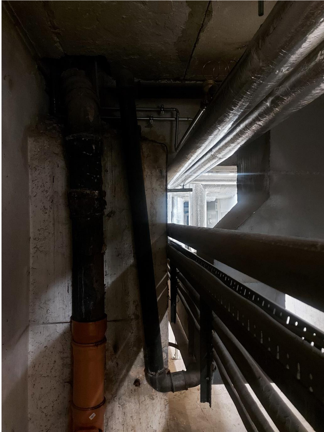
Rysunek 4 Aktualny widok elementów instalacji hydrantowej w części niskiej budynku - piwnica
