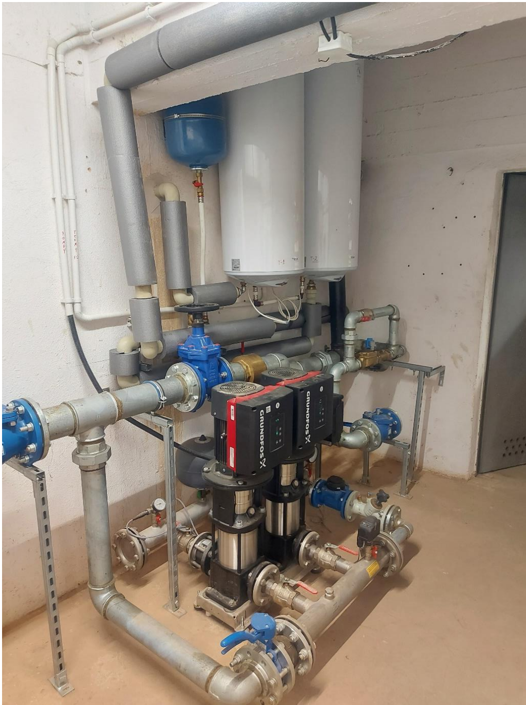
Rysunek 10 Aktualny widok nowej instalacji hydroforowej
