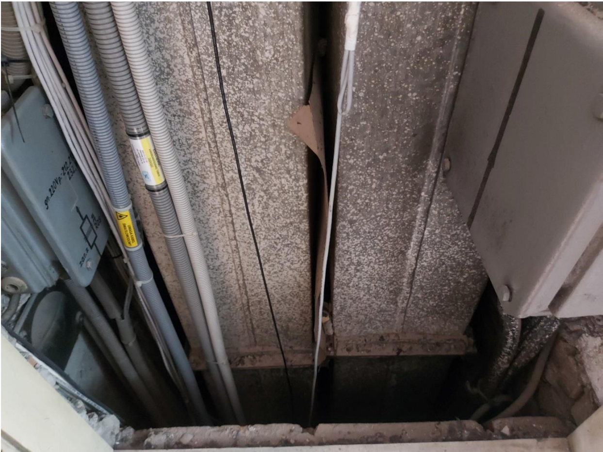
Rysunek 9 Aktualny widok szachtu (kanału pionowego) w części wysokiej budynku docelowo przeznaczanego do wykorzystania przy projektowaniu nowej instalacji hydrantowej
