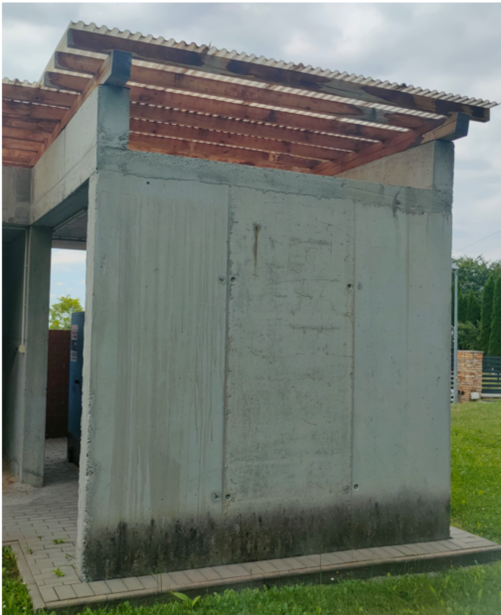
Ryc. 5. Istniejący system odprowadzenia wody – brak muru oporowego (od wschodu)
