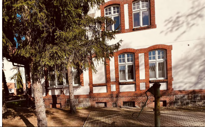
Elewacja zachodnia – na styku z gruntem widoczne zaślepienie wtórnie okienka piwniczne – docelowo lokalizacja końcówek instalacji wentylacji decentralnej
