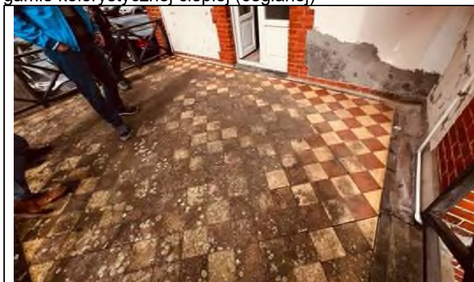
Widok obecnego stanu zniszczonej nawierzchni tarasu
