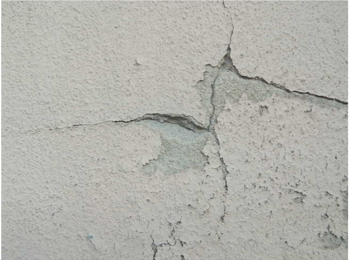
14. Pęknięcia tynków na lizenie w pasie parteru.
