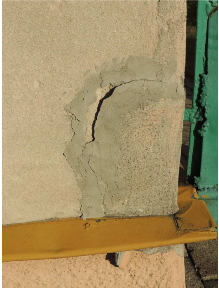
28. Pęknięcie naprawiane wielokrotnie.
