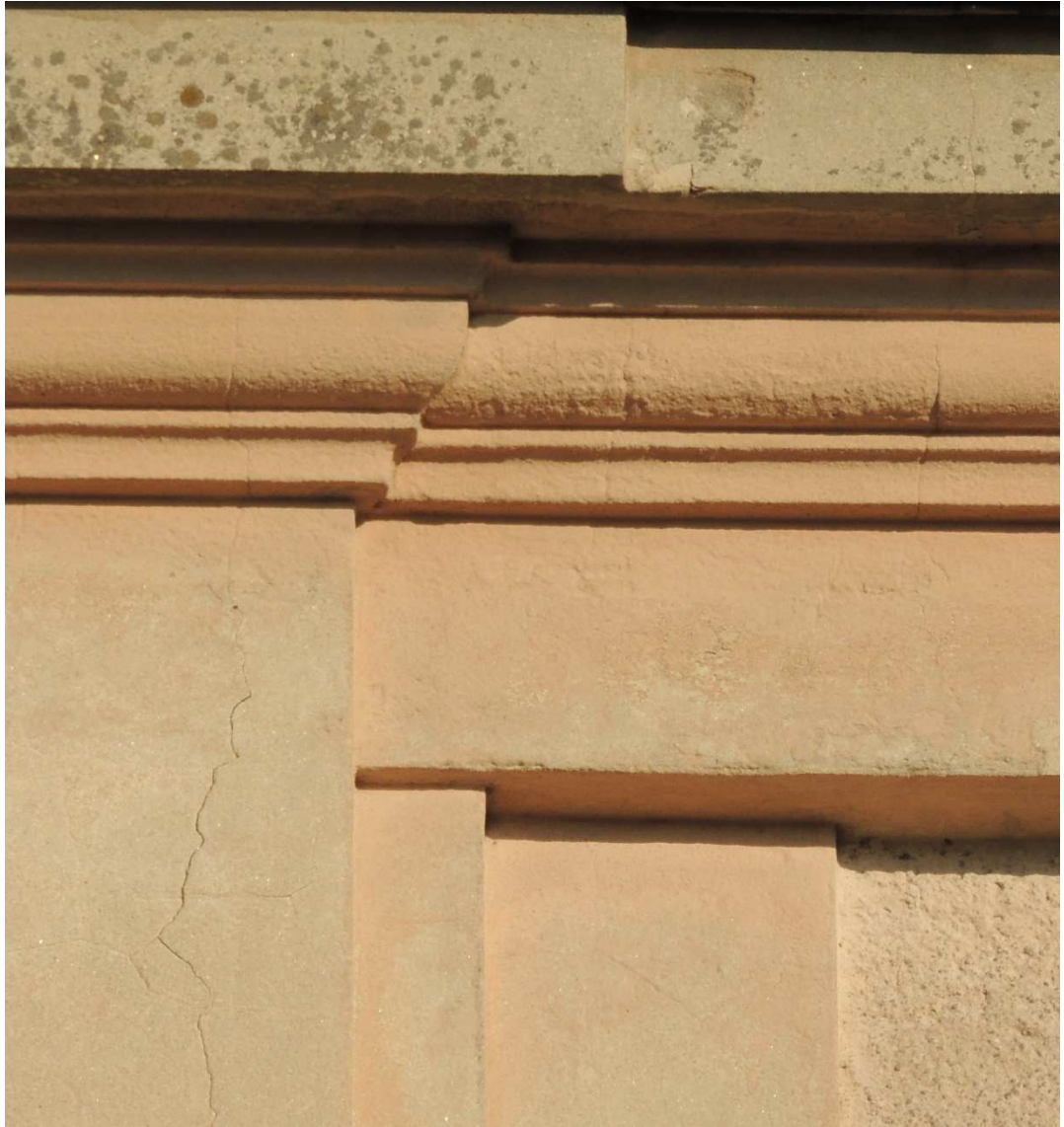
9. Spękany tynk pokryty różową farbą.
