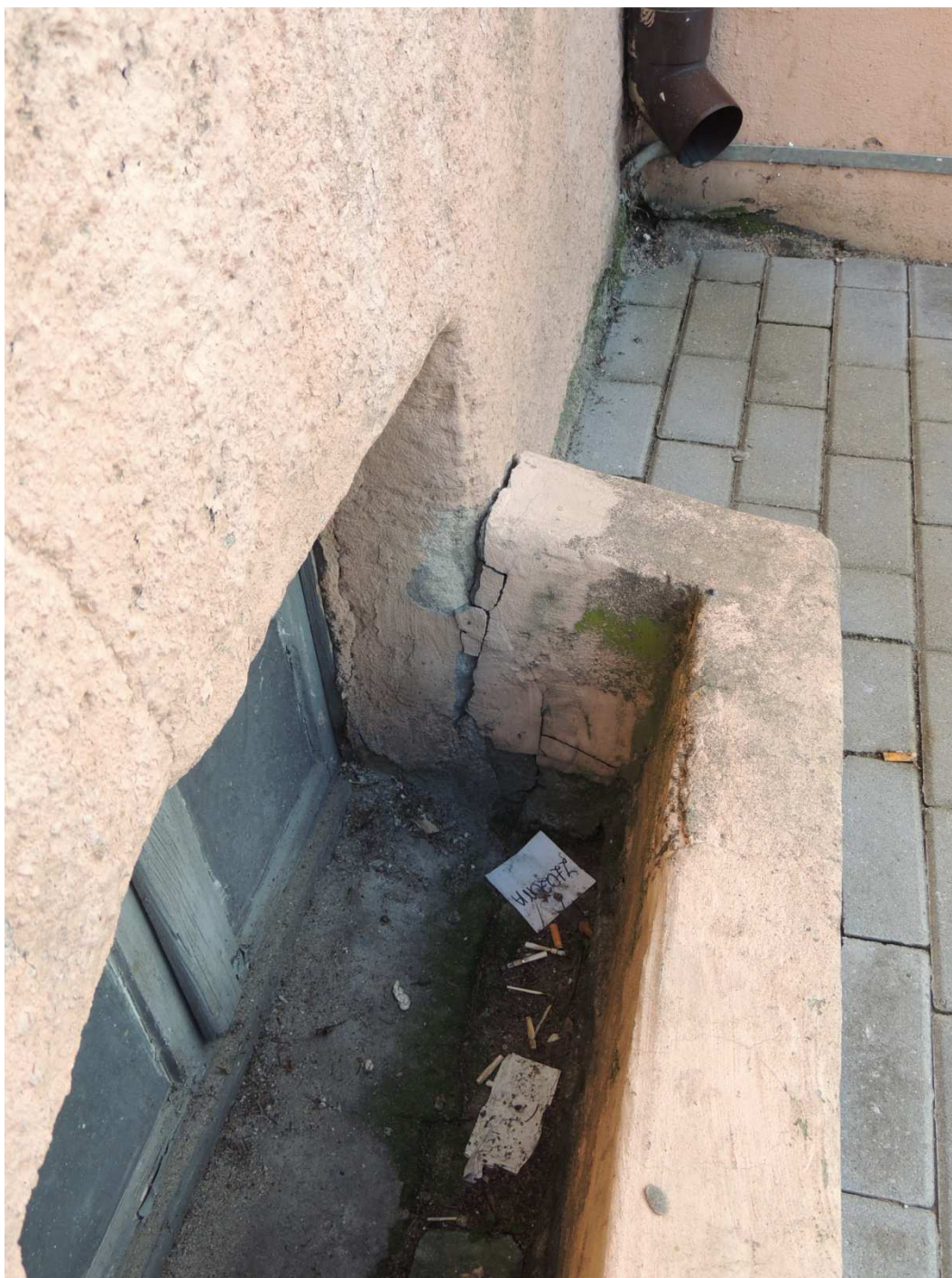
22. Obniżenie okienka piwnicznego, widoczne odspojenia obramienia, zazielenienia glonów, spękanie parapetu okienka gdzie przesiąka woda.
