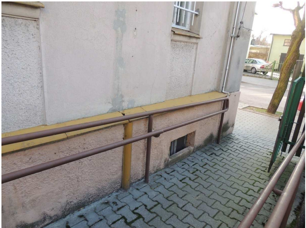
35. Podjazd, w przyziemiu przebarwienia spowodowane rozwojem mikroflory.
