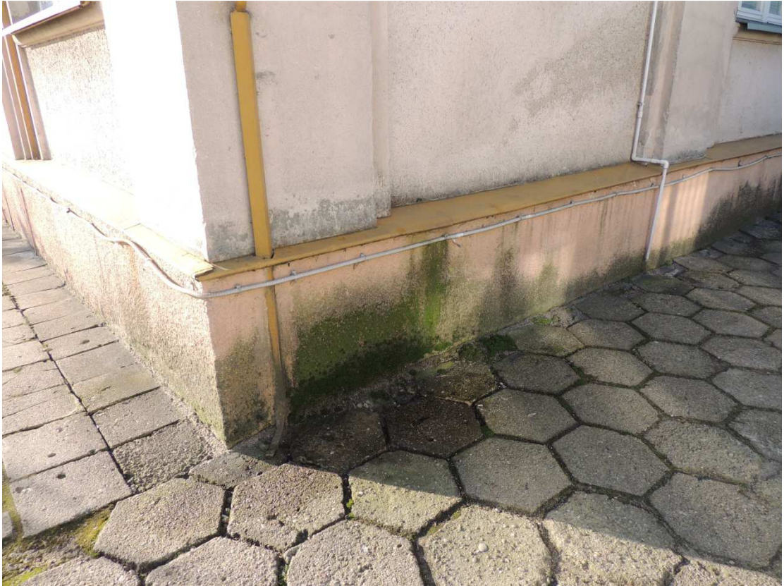
40. Stałe zawilgocenie narożnika spowodowane spadającymi kroplinami z klimatyzacji, zielone glony porastające tynk.
