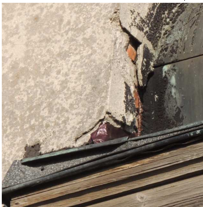
4. Detal fot.nr3. Widoczne na tynku plechy porostów i wyplamienia grzybów.
