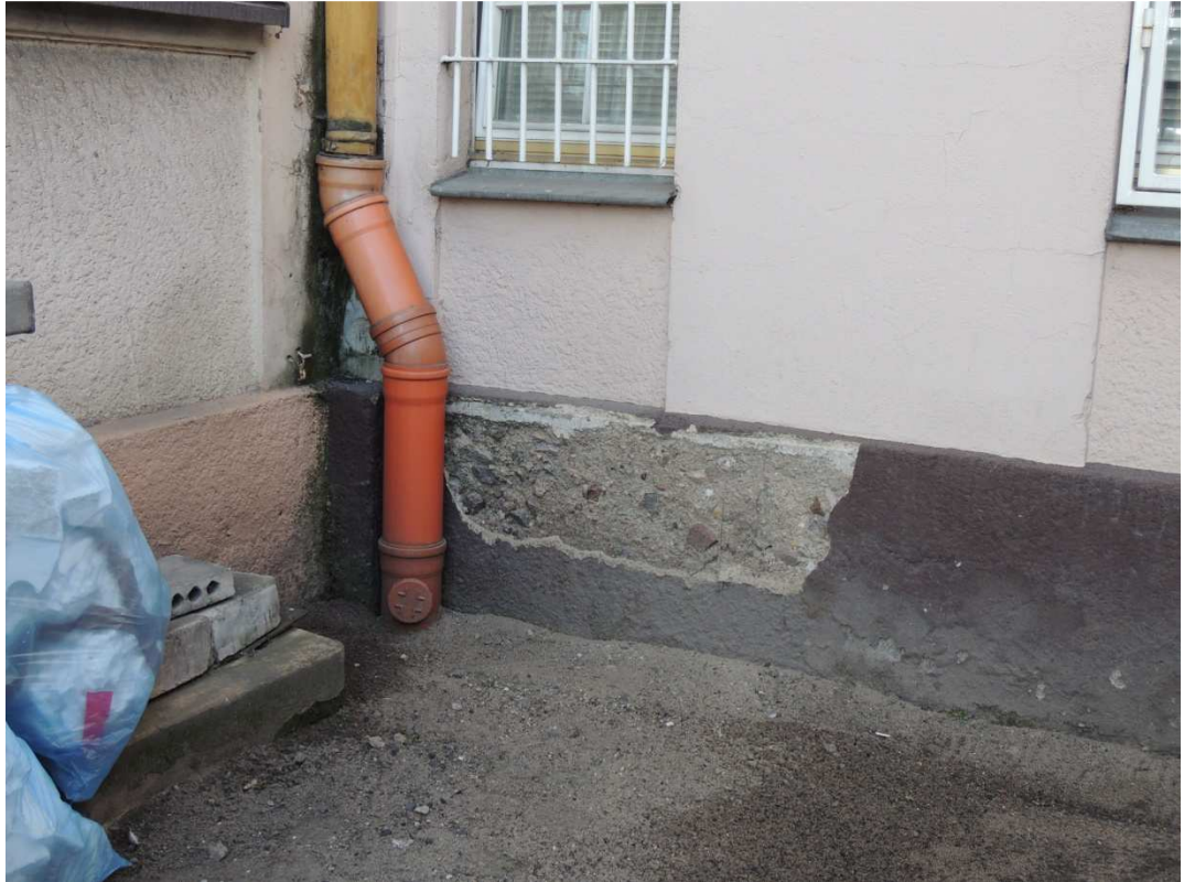
44. Wtórne rury spustowe, ubytek tynku na cokole łącznika.
