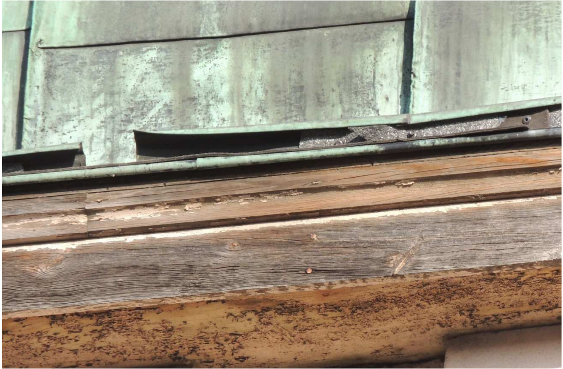
7. Ubytki blachy miedzianej, na powierzchni drewna widoczna różowa farba.
