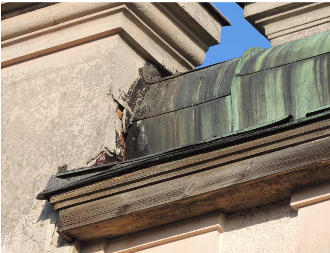
3. Zniszczenia i wtórne naprawy opierzenia, belka drewniana wspierająca konstrukcję. Lewa strona ryzalitu.
