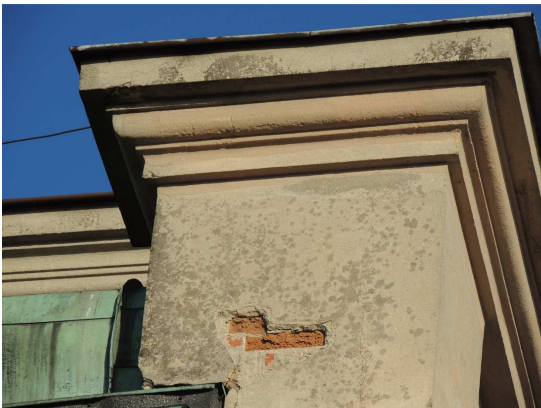
5. Ubytki tynku, porosty i grzyby.
