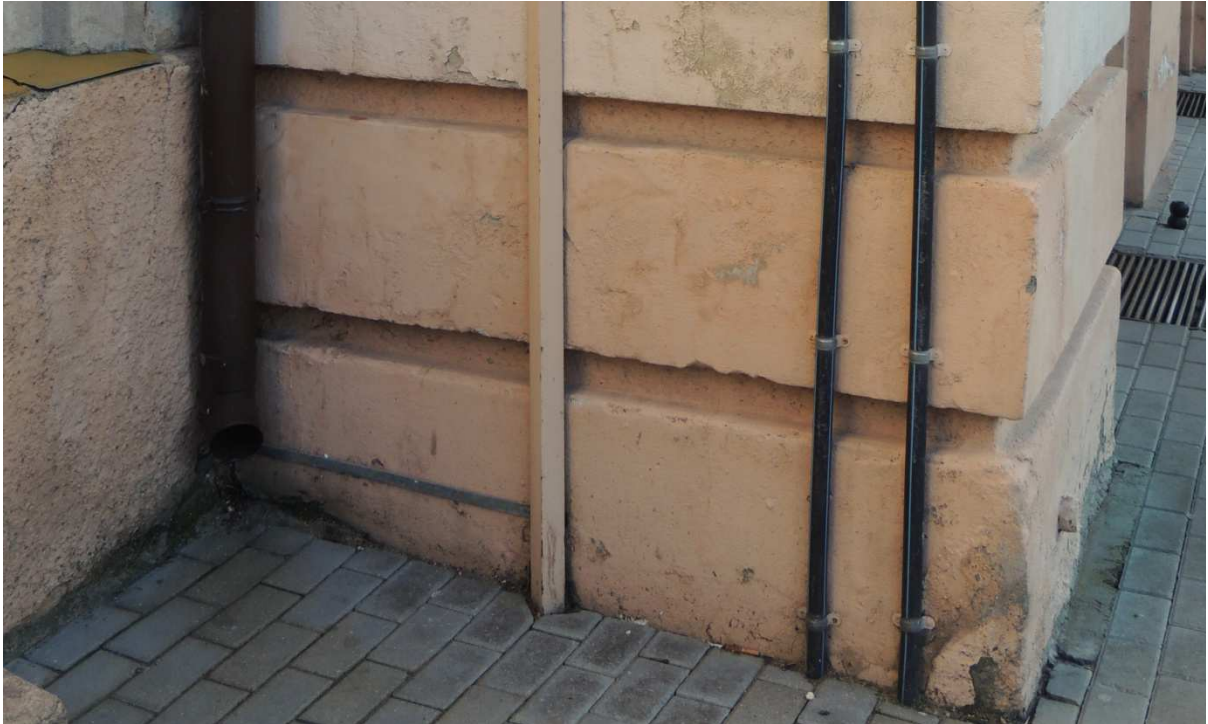
20. Nieprawidłowe odprowadzenie wody z dachu, wylot rury odprowadza wodę bezpośrednio do budynku.
