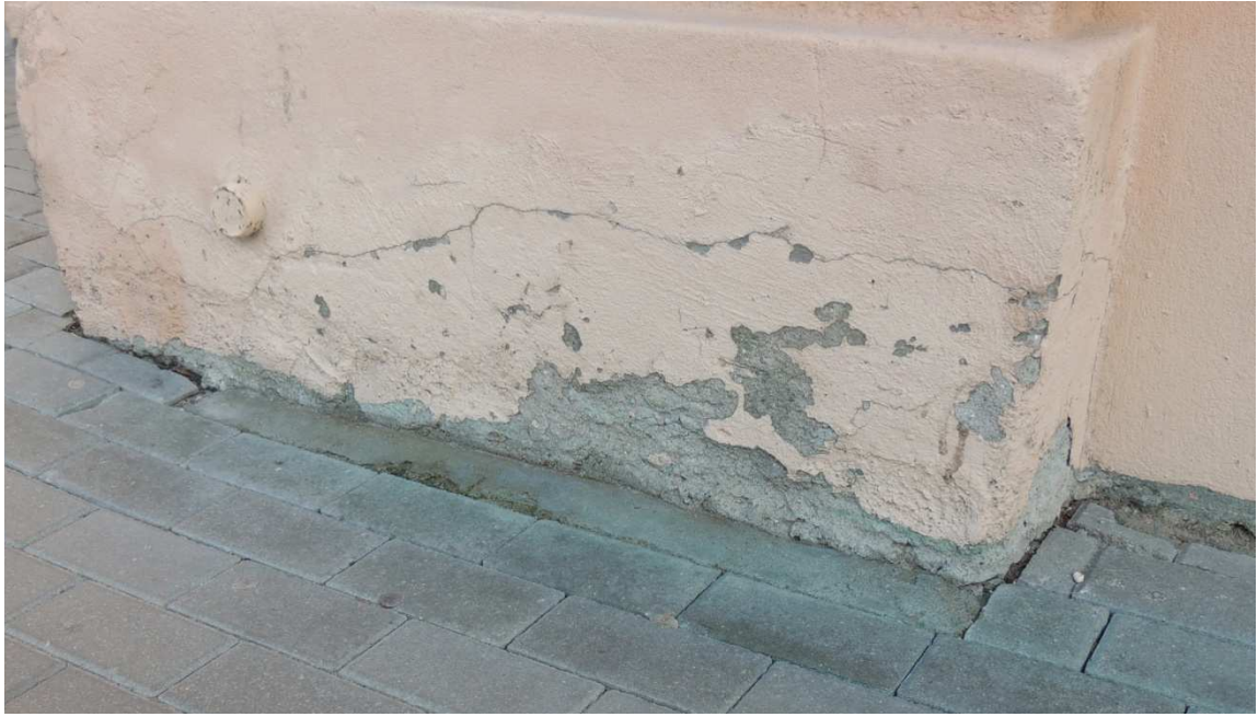
26. Ubytki tynku w przyziemiu.
