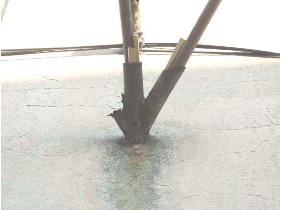
16. Spękania tynku, zniszczony i skorodowany uchwyt na flagi.
