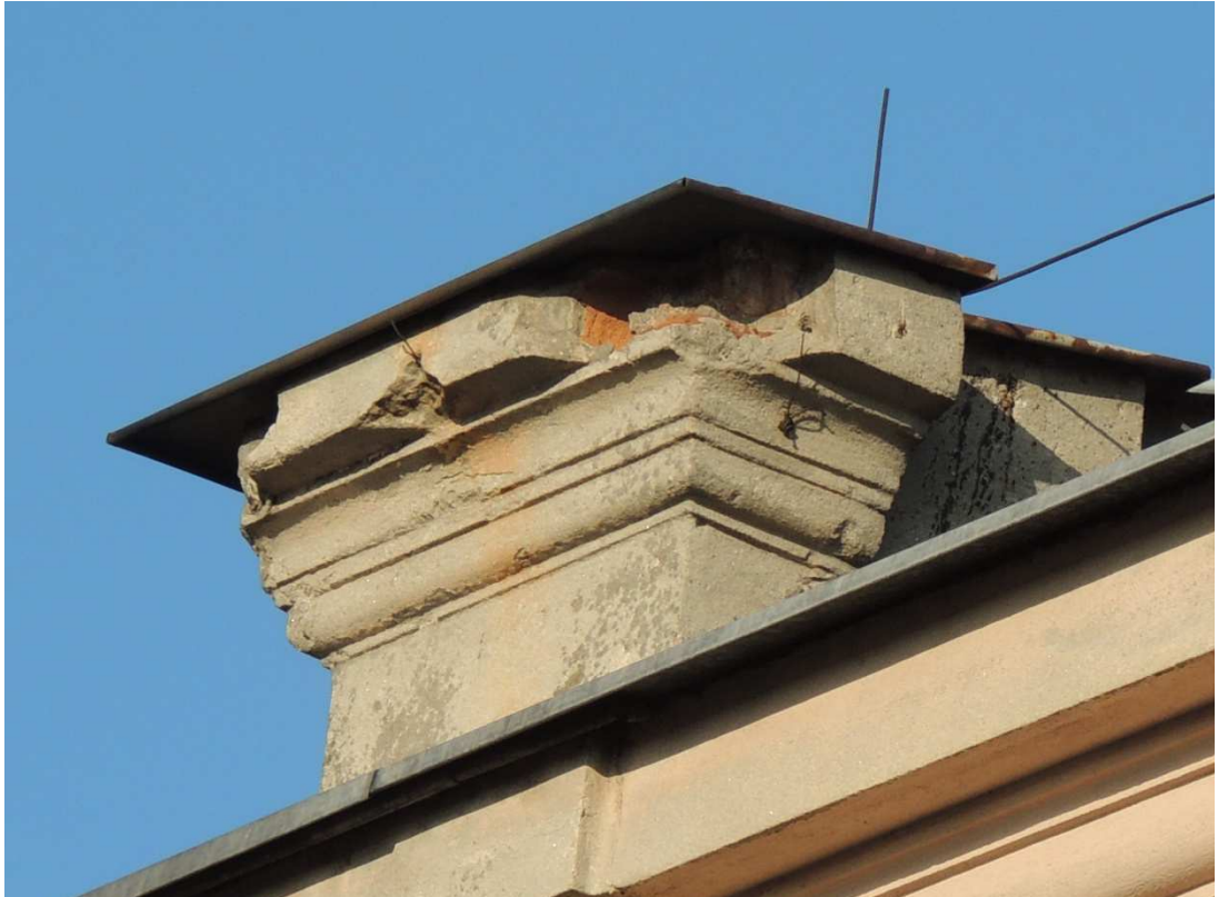
10. Zniszczenia szczytów attyki spowodowane zalewaniem muru wodą deszczową z powodu niesprawnej blacharki.
