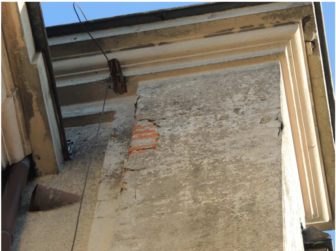
17. Zniszczenia tynków ryzalitu.
