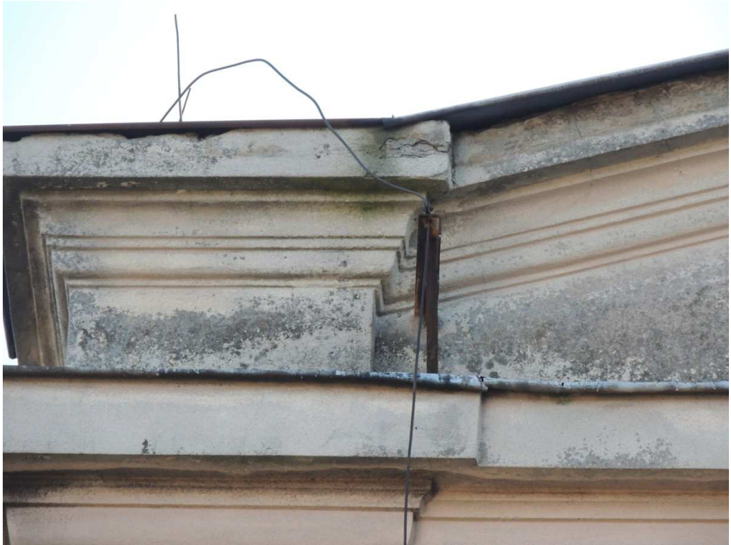
34. Zniszczenia attyki, warstwy porostów i grzyby.
