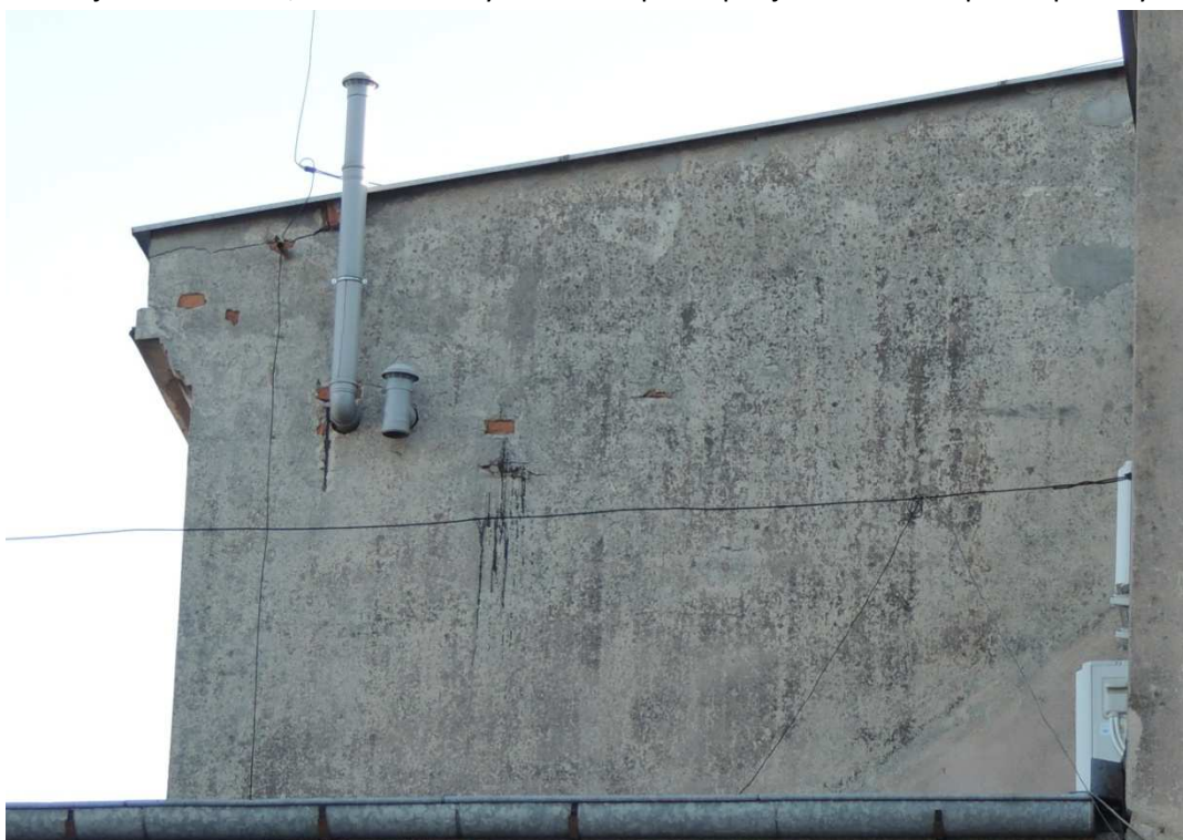
33. Elewacja boczna głównego korpusu. Porażona mikrobiologicznie, z wtórnym wylotem kominowym.
