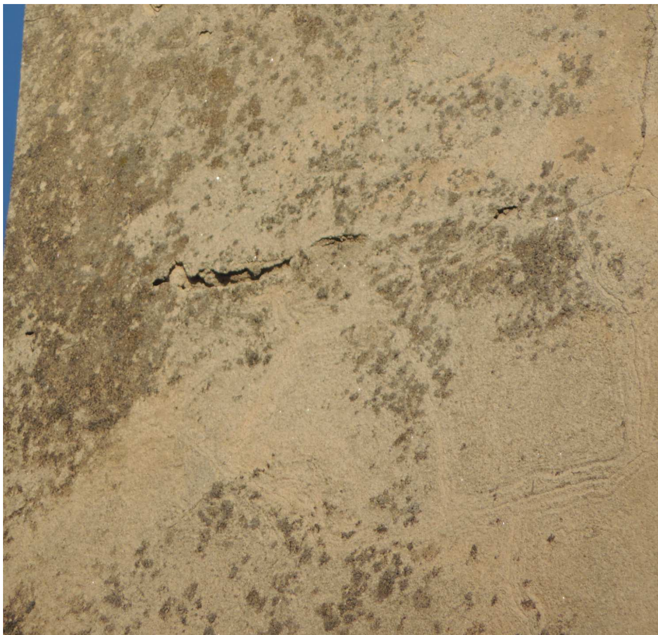
11. Pęknięcia i przepłukania powierzchni tynku, widoczna flora porastająca tynk.
