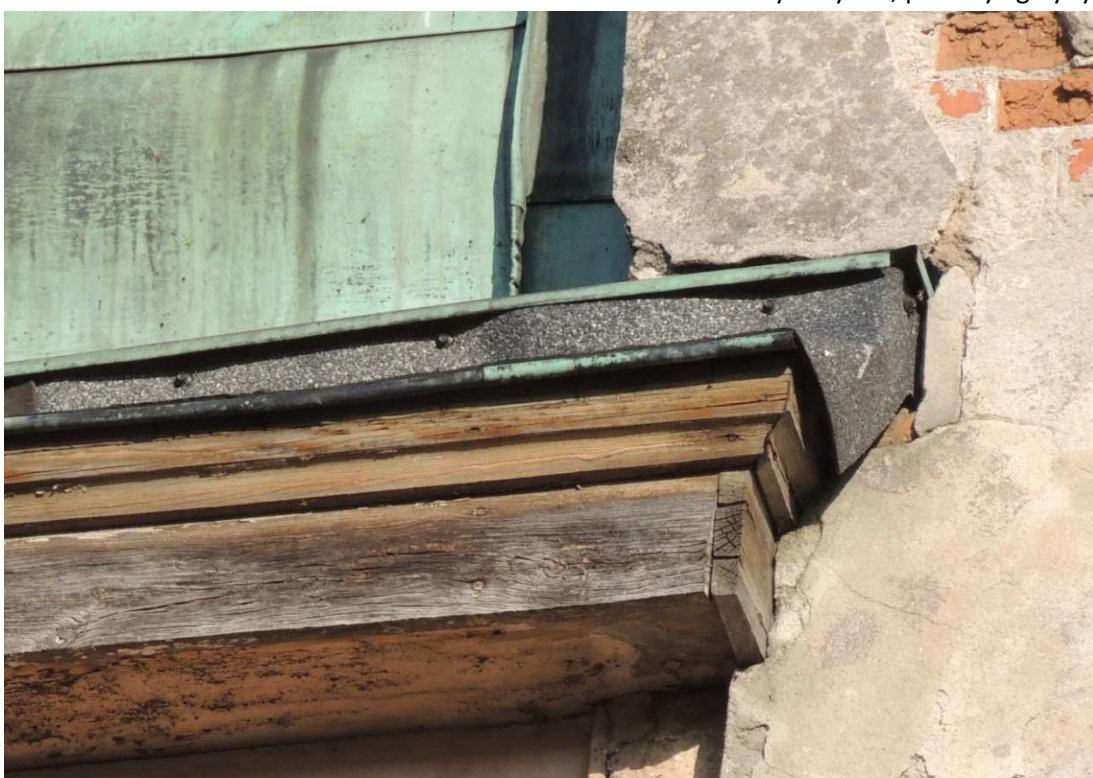
6. Zniszczenia tynków, papa pokrywająca drewno.
