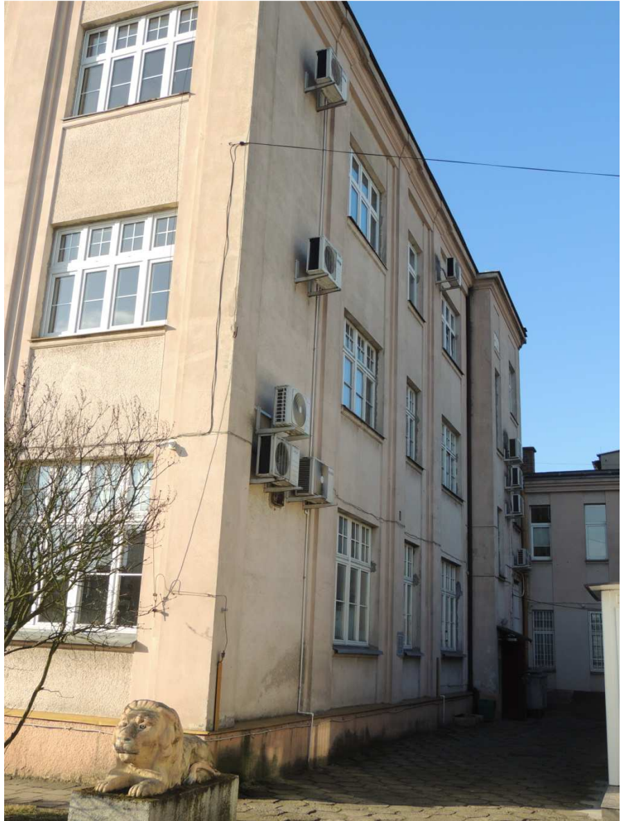
39. Narożnik budynku, w pasie przyziemia mocne zawilgocenie.
