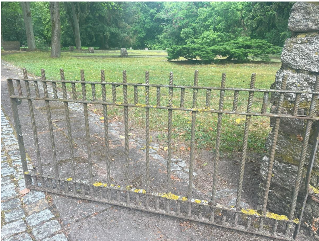
Stan ogrodzenia -skrzydło bramy do wymiany
