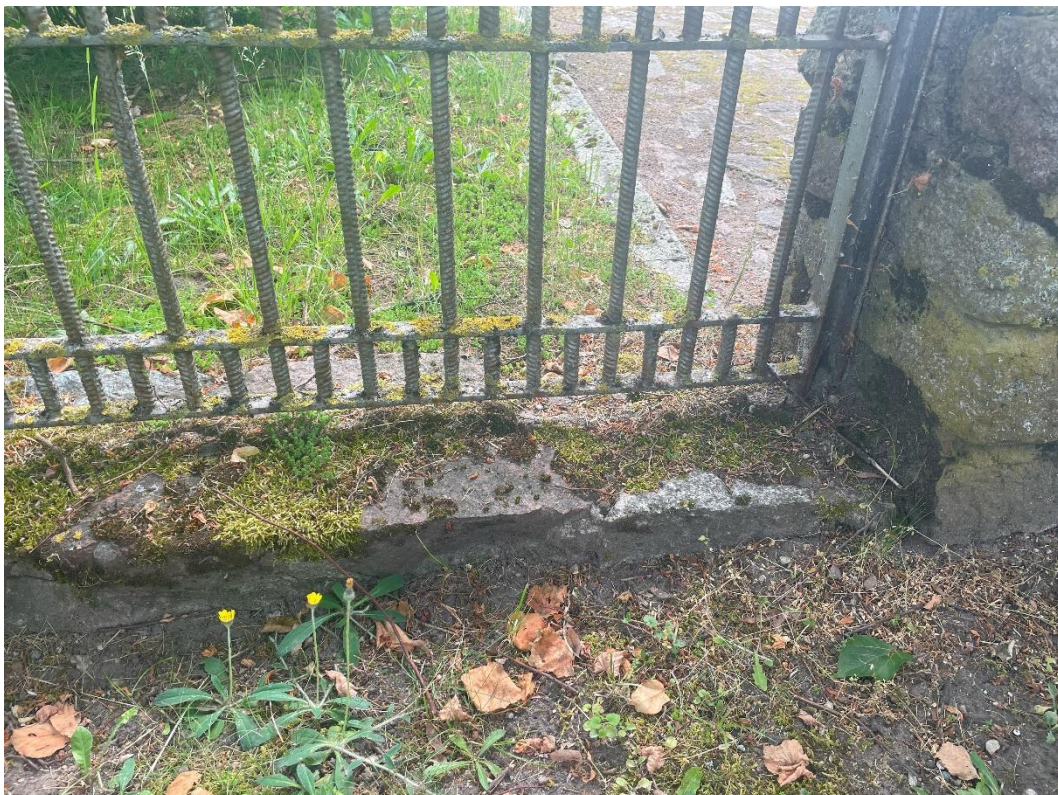
Stan ogrodzenia – podmurówka z kamienia do renowacji
