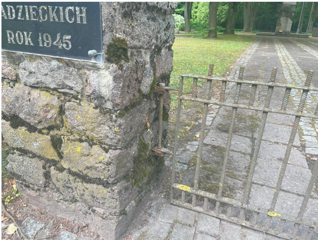
Stan ogrodzenia -słupek z kamienia przy bramie do renowacji
