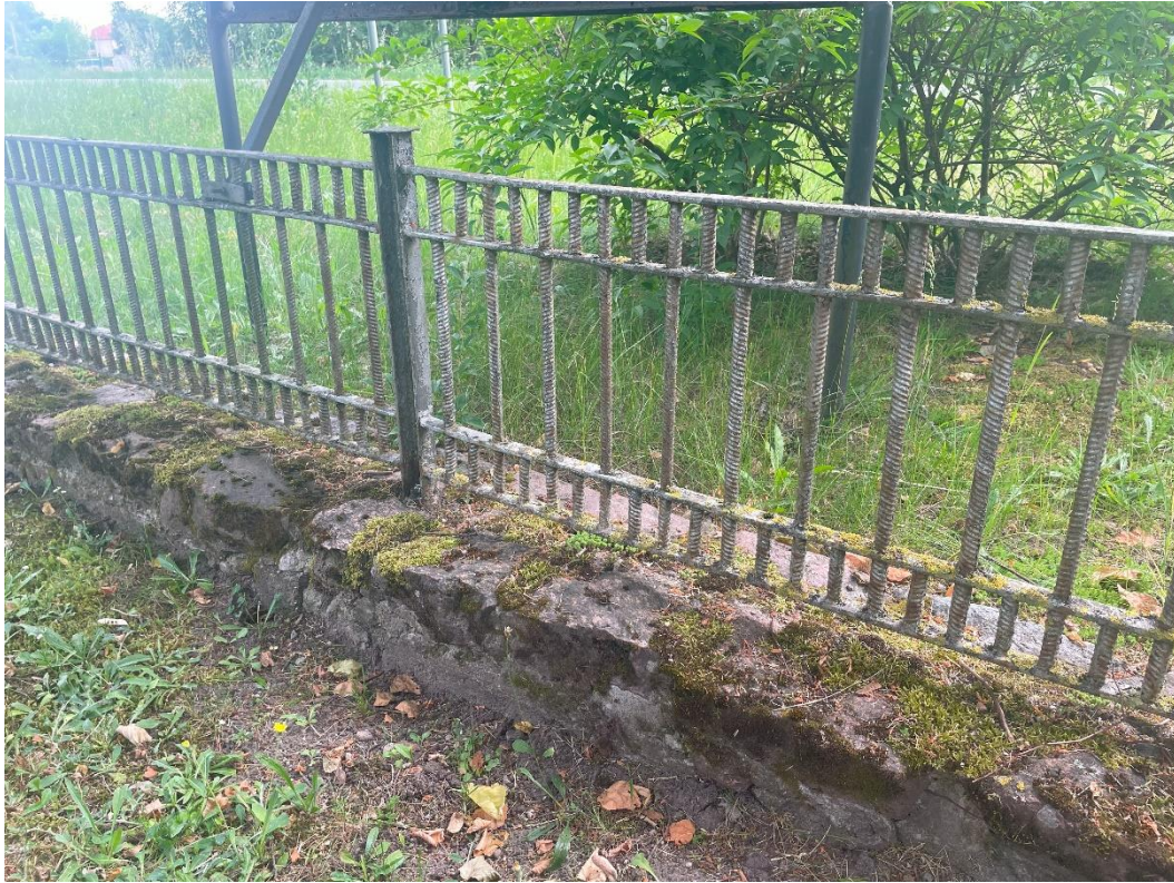
Stan ogrodzenia - podmurówka z kamienia do renowacji
