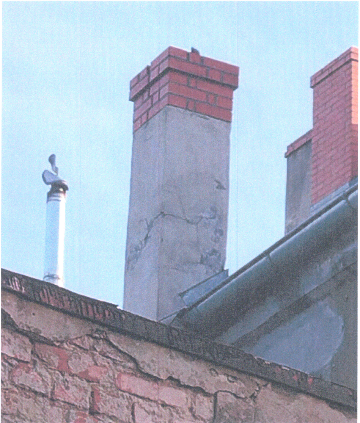
Fot. 2 - widok uszkodzeń tj. pęknięta głowicy i spękania na całej wysokości
