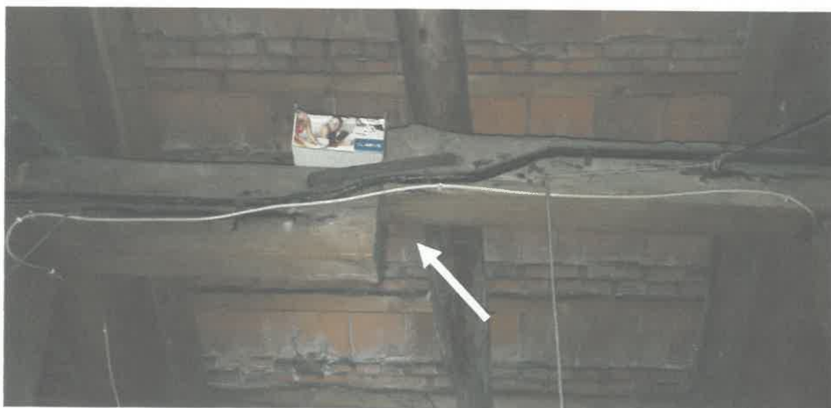
Widoczny uskoki w połączeniu dwóch płatwi oraz różnica poziomów oparcia kroki na płatwiach
