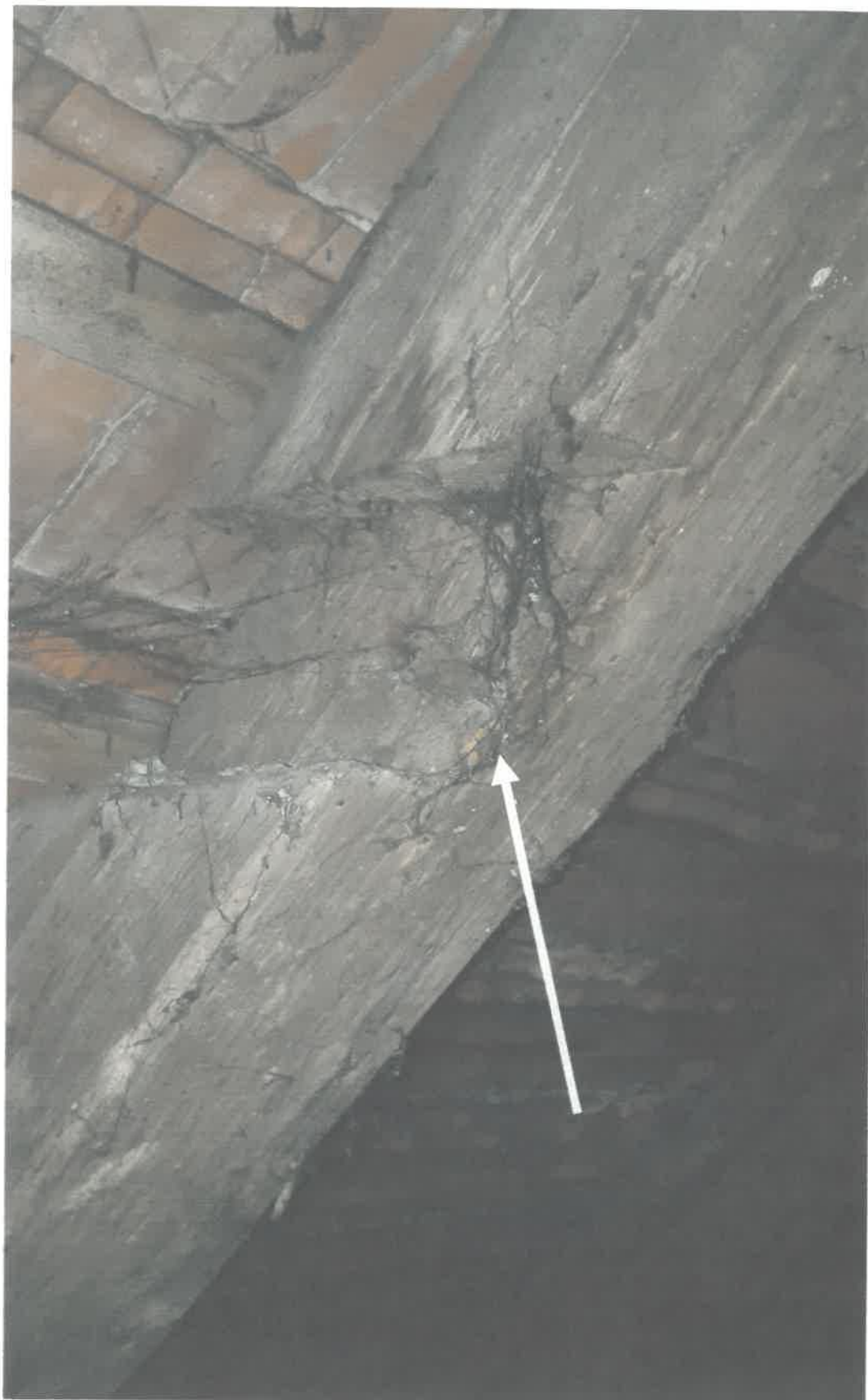
Wycięcie osłabiające krokiew (element z rozbiórki)
