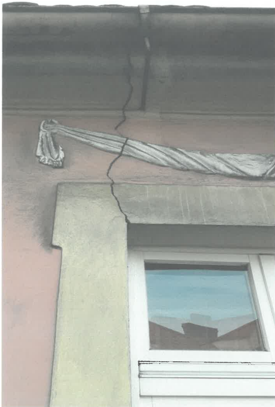
Pęknięcie pionowe w ścianie elewacji frontowej
