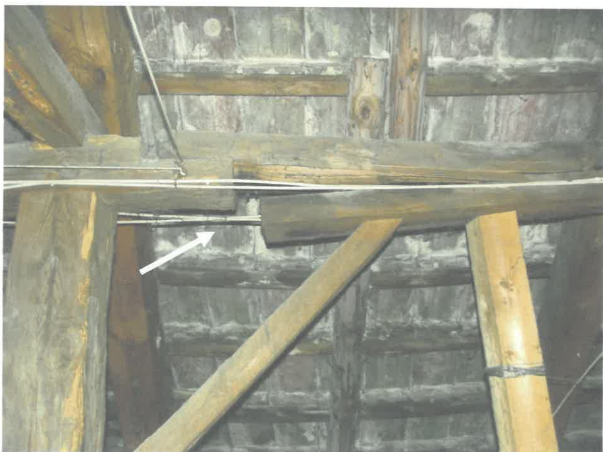
Zniszczone połączenie zakładkowe dwóch płatwi
