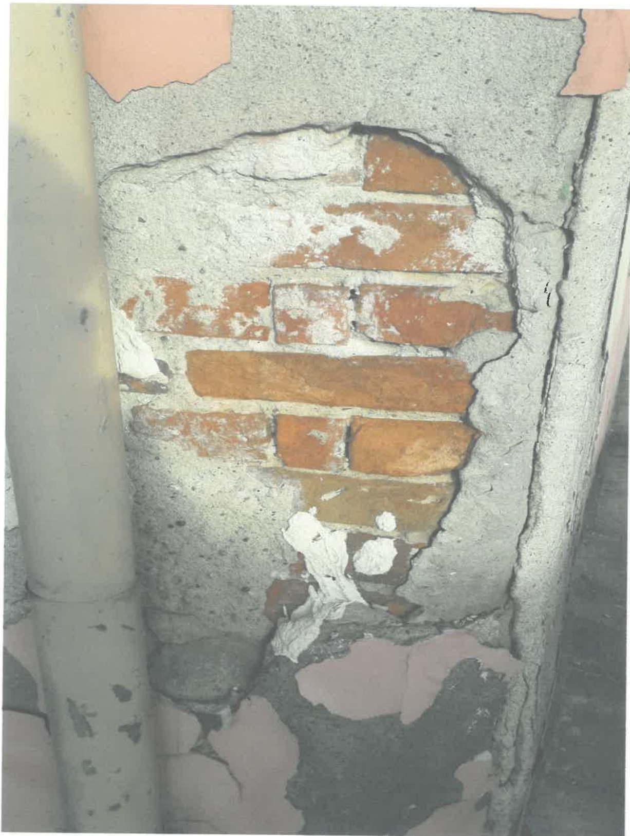
Miejscowe odparzenie tynku w ścianie od podwórza
