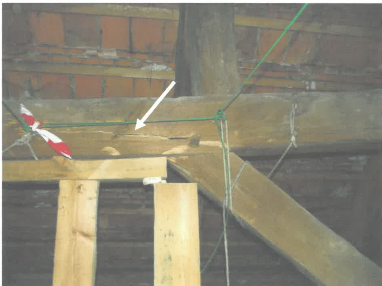
Pęknięcie płatwi w miejscu oparcia krokwi i miecza
