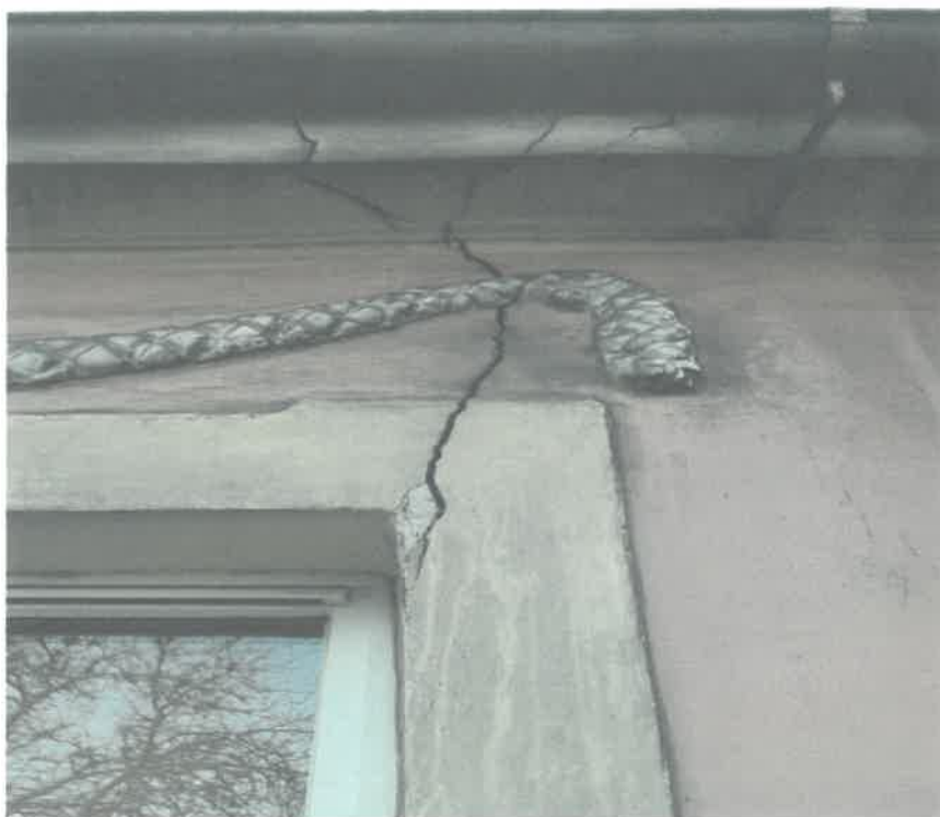
Pęknięcie pionowe w ścianie elewacji frontowej
