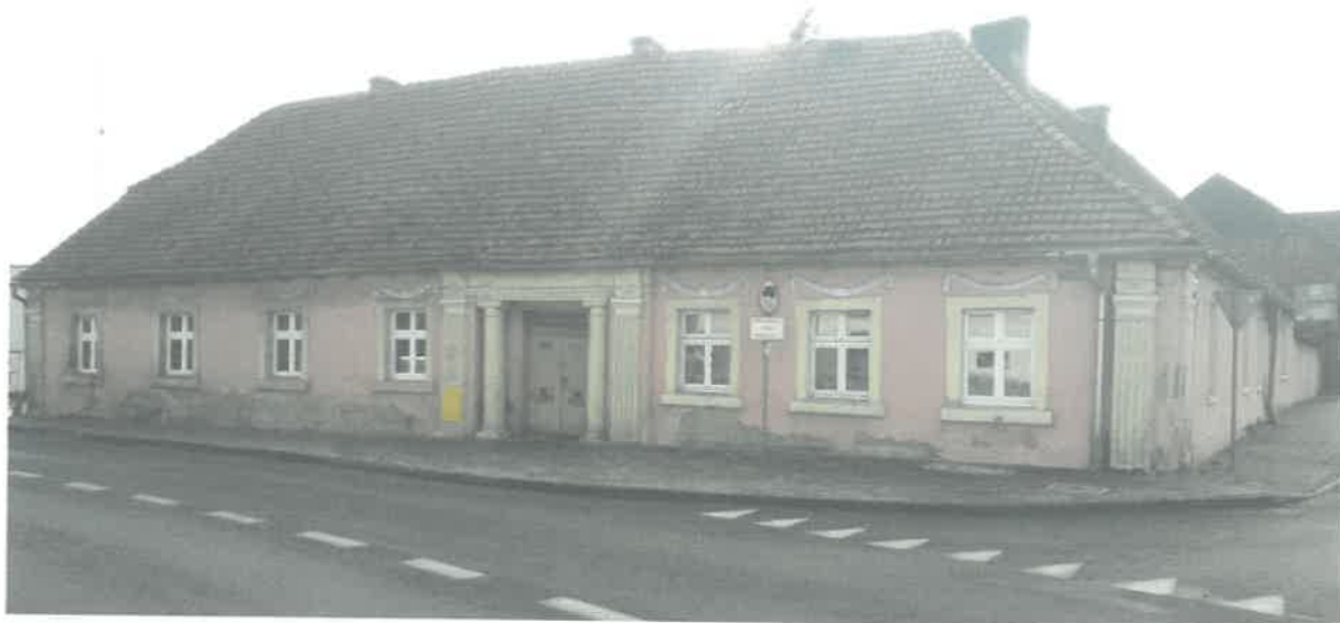
Elewacja z zawilgoconymi tynkami
