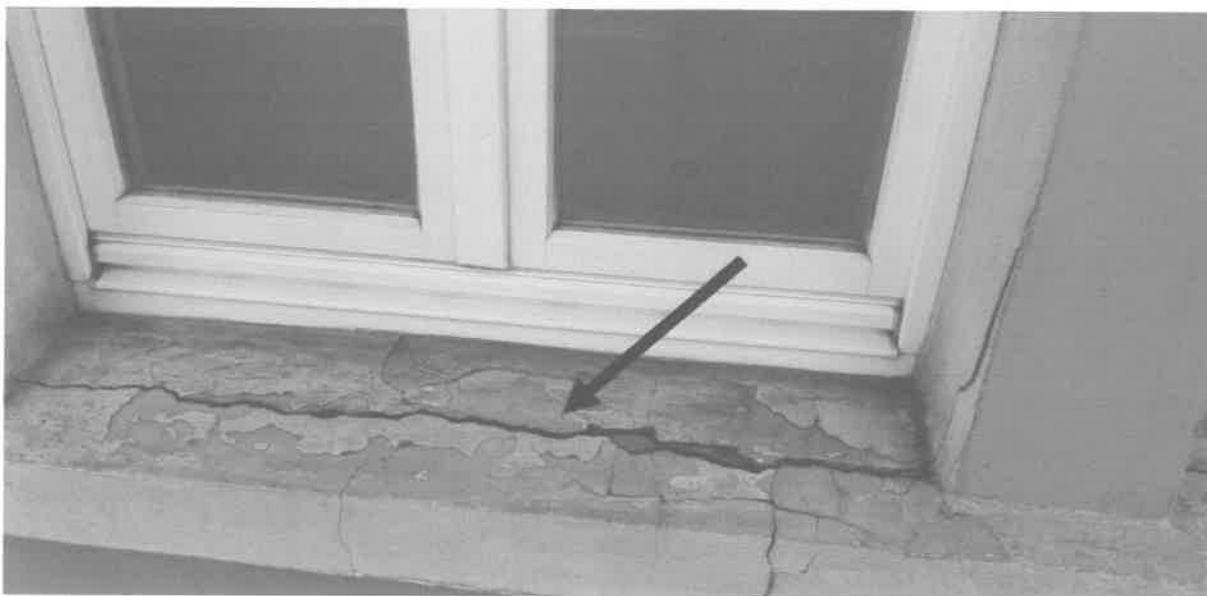
Odparzony tynk przy oknie od ulicy Browarnej
