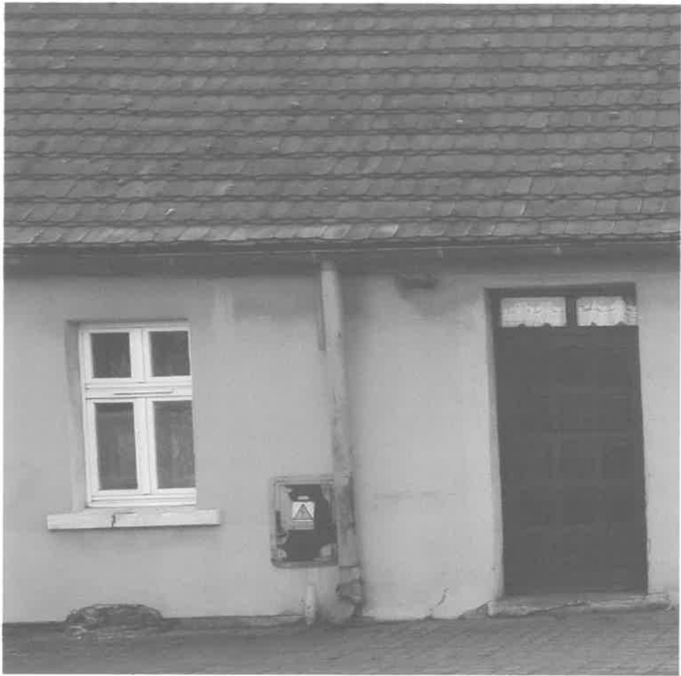
Widok rury spustowej od strony ul. Browarnej
