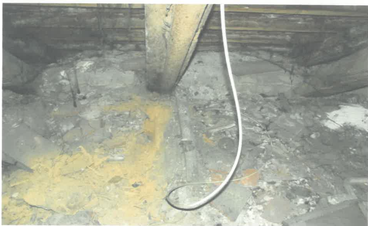
Widoczny zniszczenie w miejscu połączenia z krokwią
