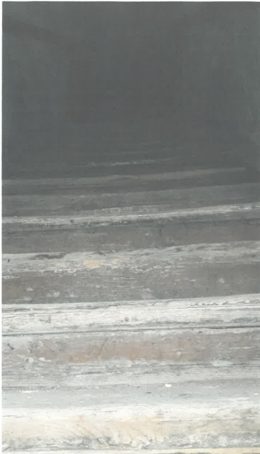
Widoczne zniszczone stopnie i podstopnie
