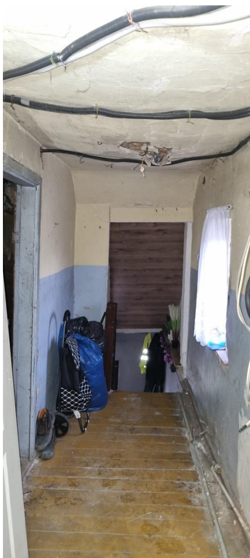
Foto 17. Widok stanu technicznego sufitu w korytarzy wejściowym na poddasze nieużytkowe;
