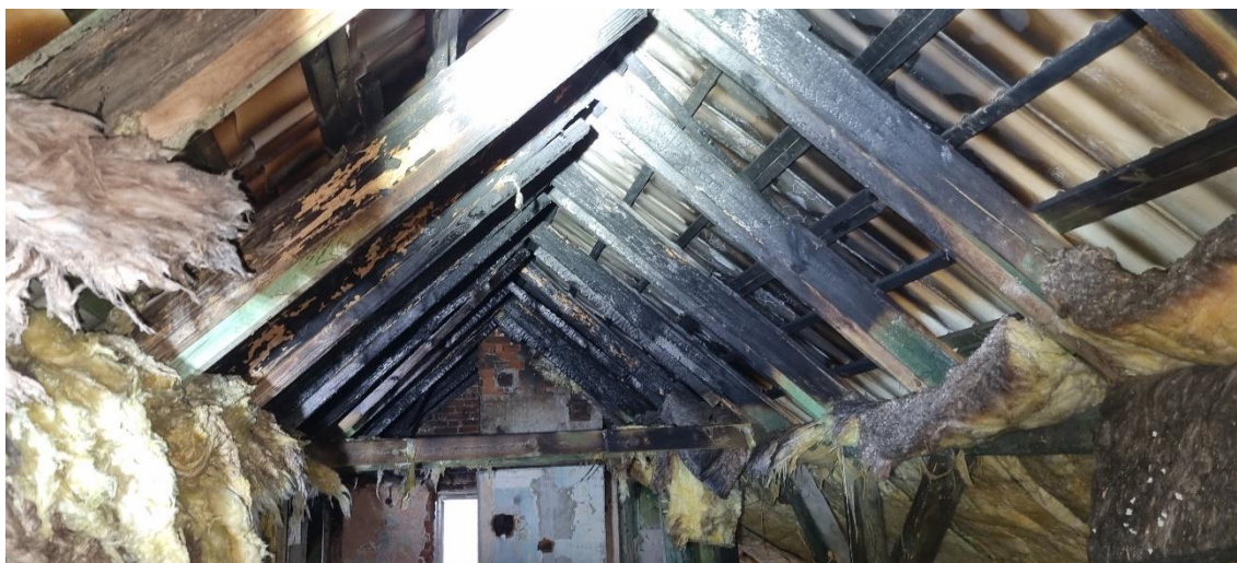
Foto 18. Widok stanu technicznego więźby dachowej po pożarze;
