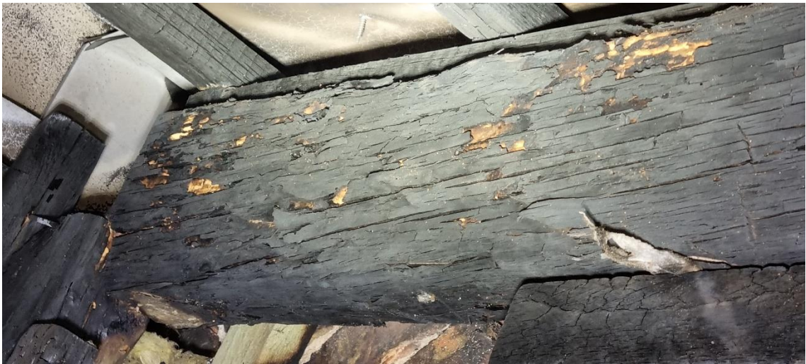
Foto 48. Widok stanu technicznego krokwi dachowej po pożarze;
