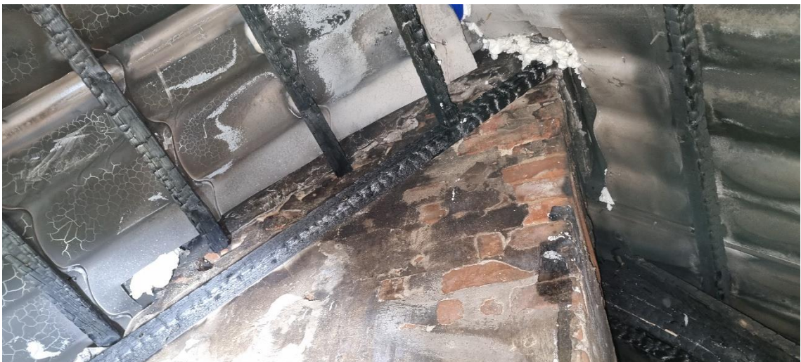
Foto 35. Widok stanu technicznego trzonu kominowego po pożarze;
