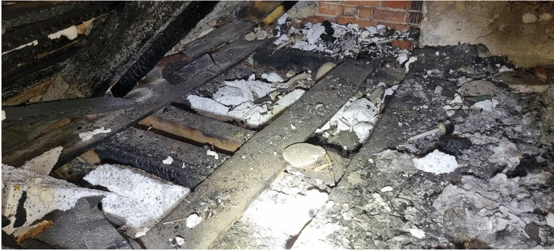
Foto 41. Widok stanu technicznego elementów stropu poddasza uszkodzonych przez pożar;
