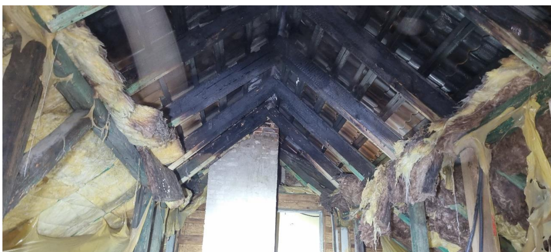
Foto 22. Widok stanu technicznego więźby dachowej po pożarze;
