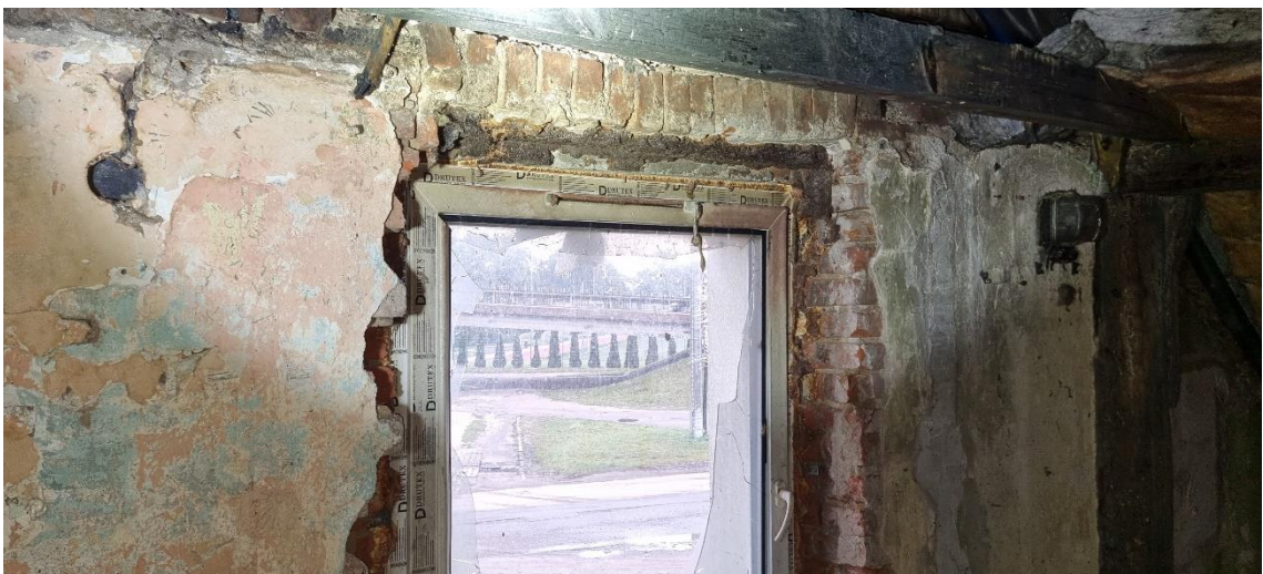
Foto 34. Widok stanu technicznego ściany osłonowej po pożarze;
