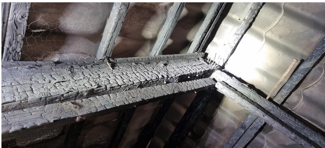
Foto 24. Widok stanu technicznego więźby dachowej po pożarze;
