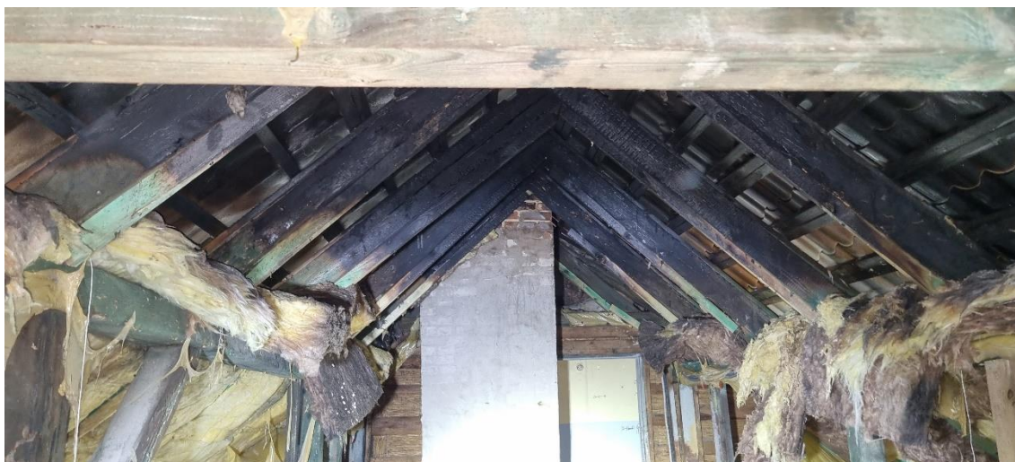
Foto 23. Widok stanu technicznego więźby dachowej po pożarze;
