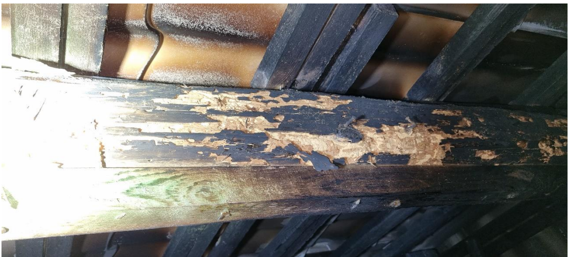
Foto 49. Widok stanu technicznego krokwi dachowej po pożarze;
