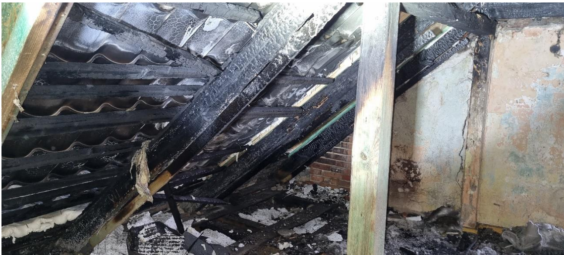
Foto 31. Widok stanu technicznego więźby dachowej po pożarze;
