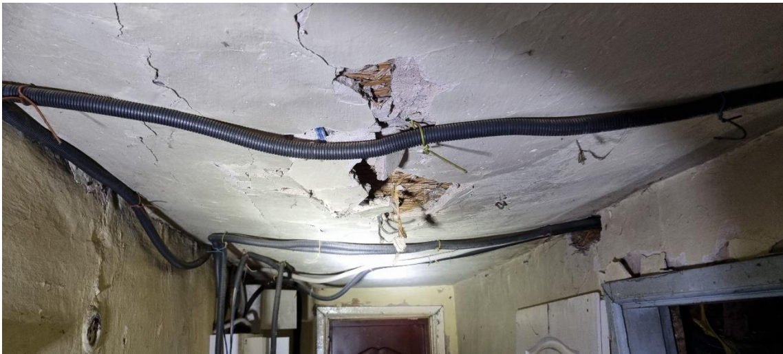
Foto 13. Widok stanu technicznego sufitu w korytarzy wejściowym na poddasze nieużytkowe;
