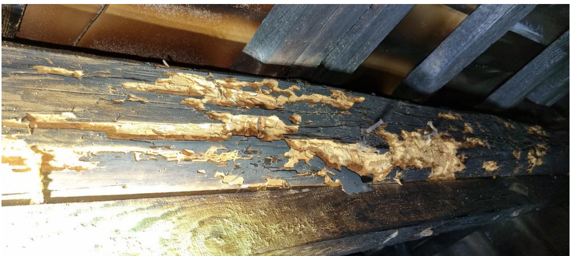
Foto 50. Widok stanu technicznego krokwi dachowej po pożarze;
