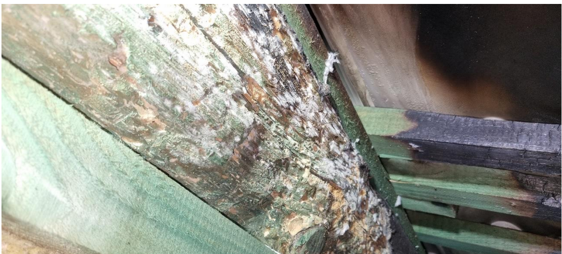
Foto 47. Widok stanu technicznego elementów więźby dachowej nie uszkodzonych przez pożar;
