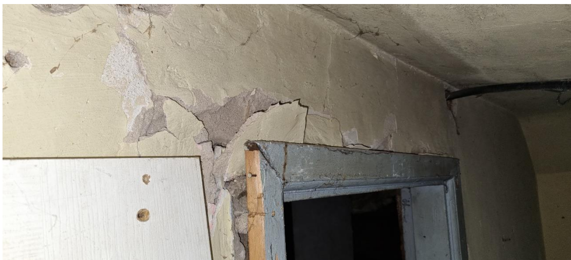
Foto 16. Widok stanu technicznego nadproża drzwiami prowadzącymi na poddasze nieużytkowe;
