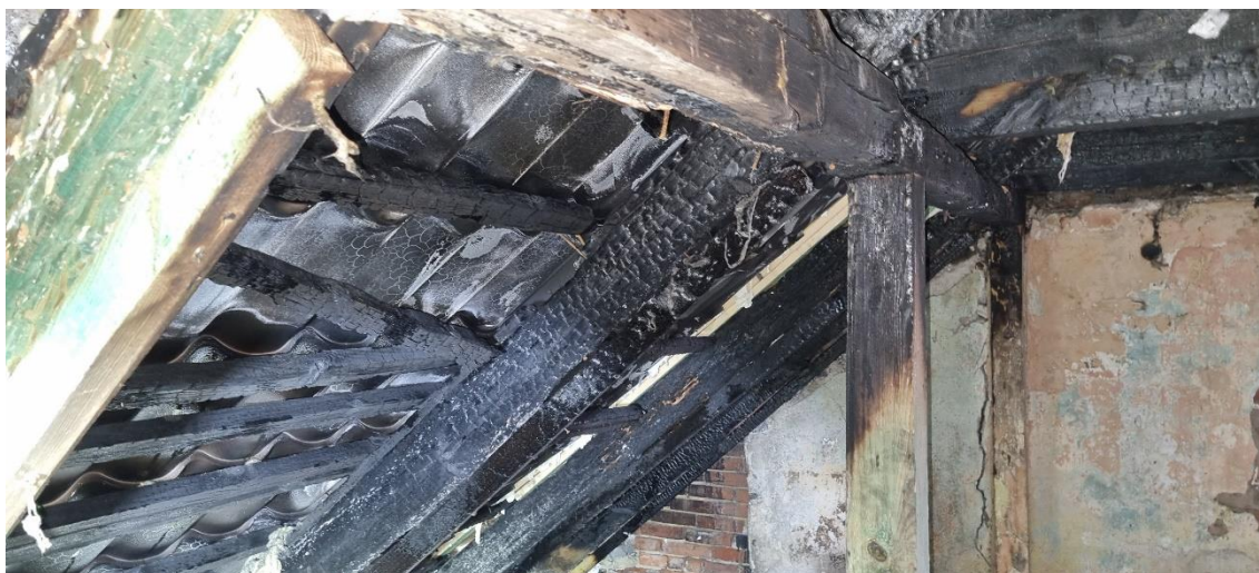
Foto 21. Widok stanu technicznego więźby dachowej po pożarze;
