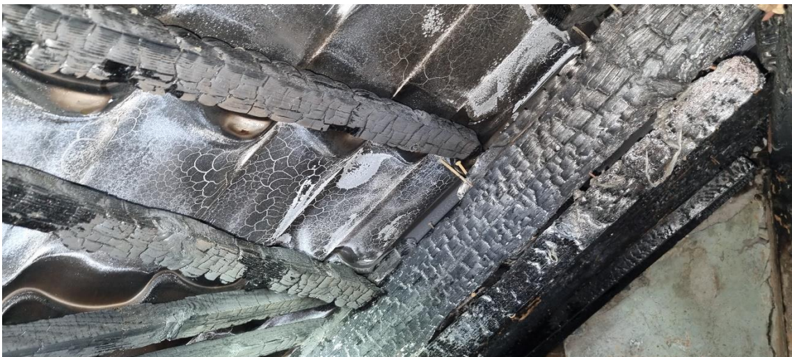
Foto 32. Widok stanu technicznego więźby dachowej po pożarze;
