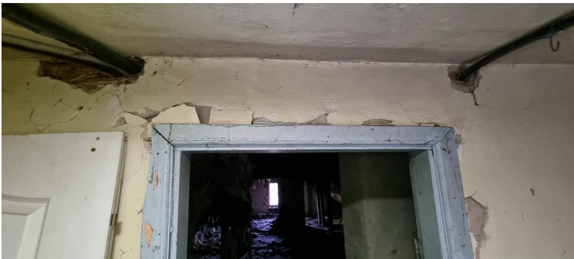
Foto 15. Widok stanu technicznego nadproża drzwiami prowadzącymi na poddasze nieużytkowe;
