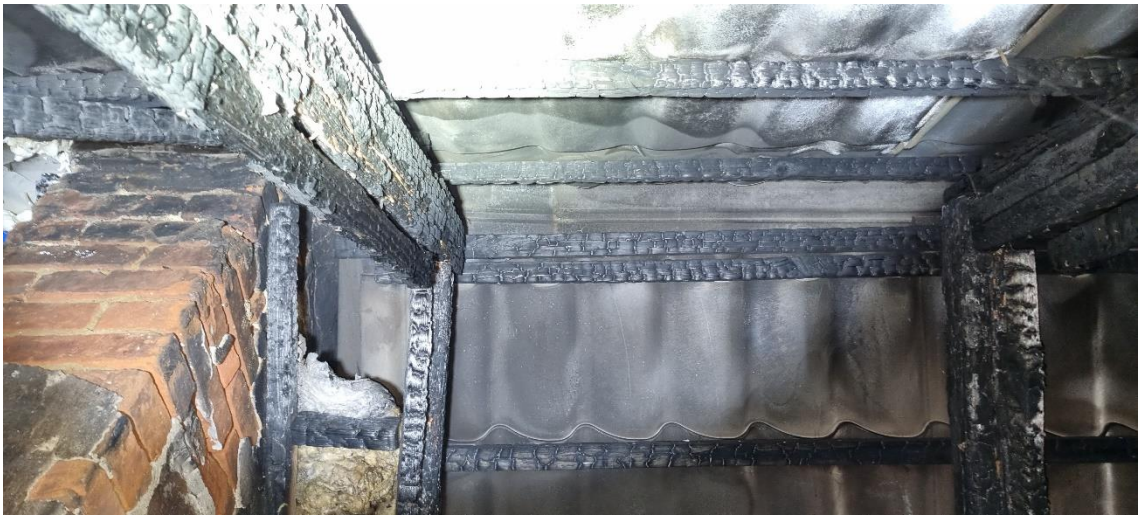
Foto 33. Widok stanu technicznego więźby dachowej po pożarze;
