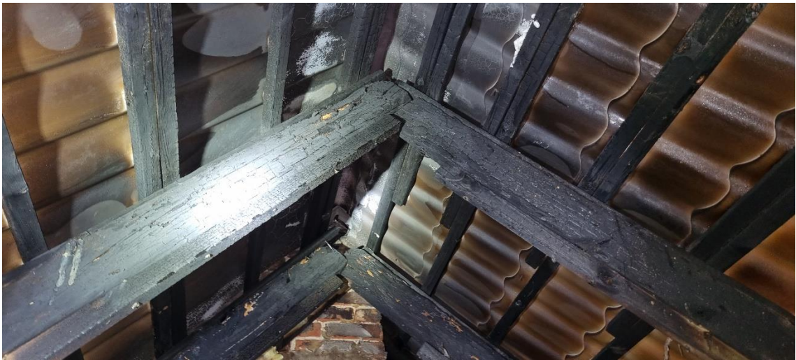
Foto 27. Widok stanu technicznego więźby dachowej po pożarze;
