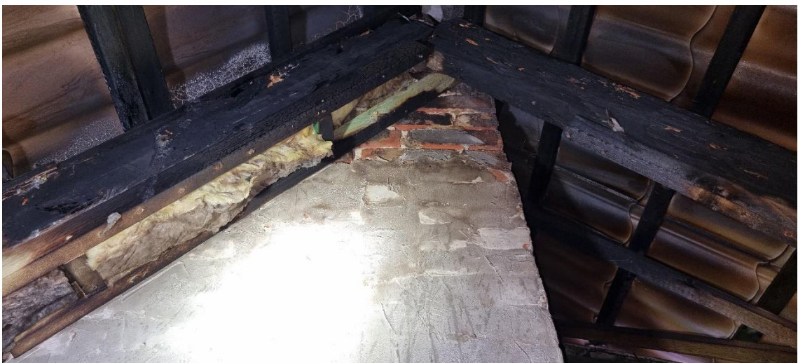
Foto 28. Widok stanu technicznego trzonu kominowego po pożarze;
