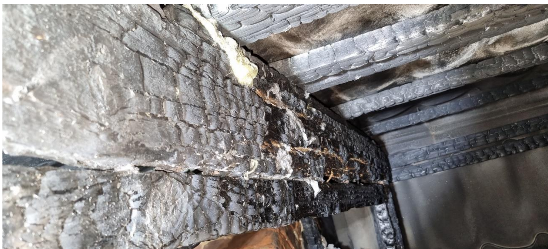
Foto 36. Widok stanu technicznego więźby dachowej po pożarze;
