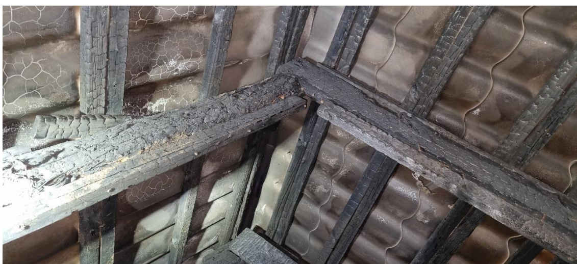
Foto 25. Widok stanu technicznego więźby dachowej po pożarze;
