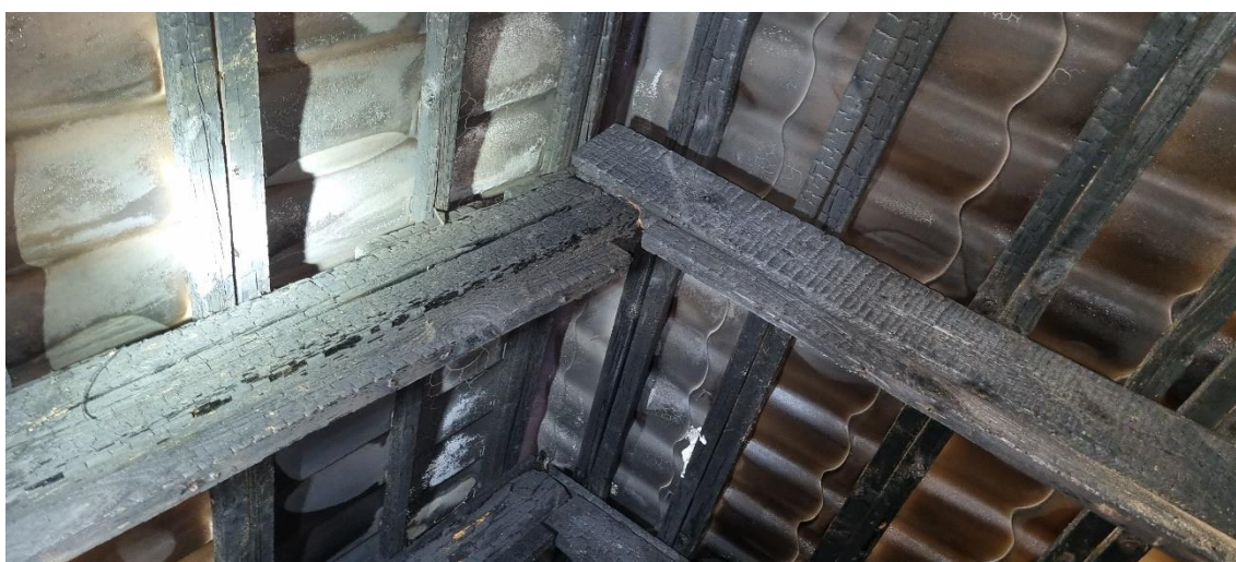
Foto 26. Widok stanu technicznego więźby dachowej po pożarze;
