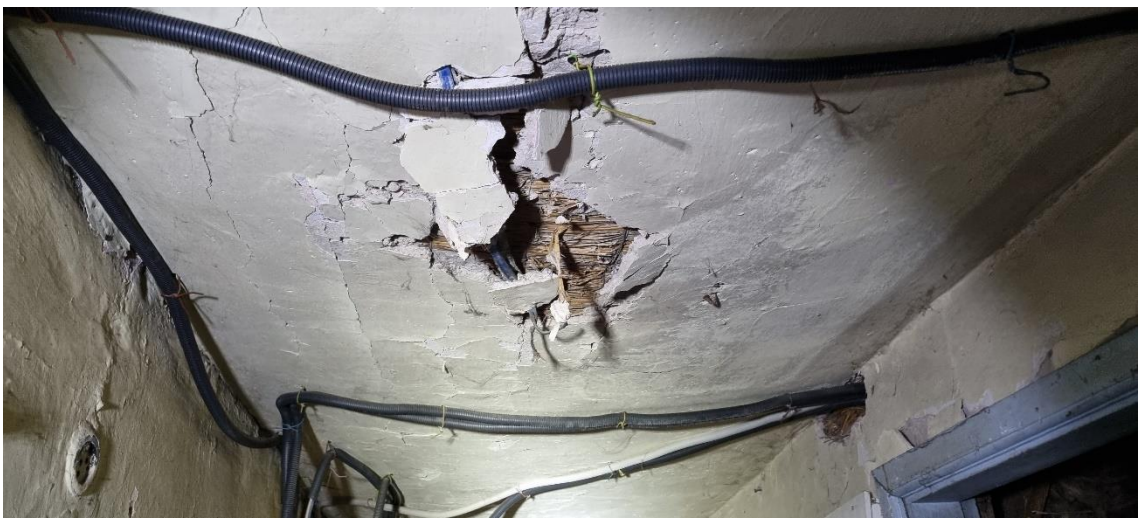
Foto 14. Widok stanu technicznego sufitu w korytarzy wejściowym na poddasze nieużytkowe;
