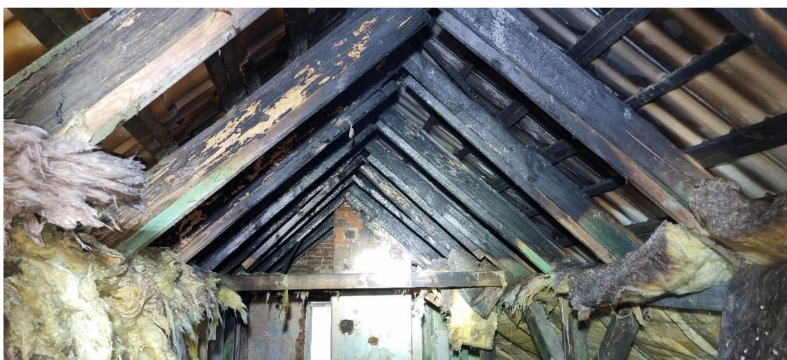
Foto 19. Widok stanu technicznego więźby dachowej po pożarze;
