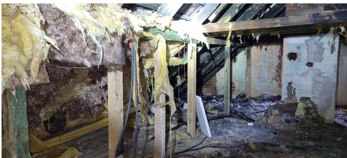
Foto 20. Widok stanu technicznego więźby dachowej po pożarze;
