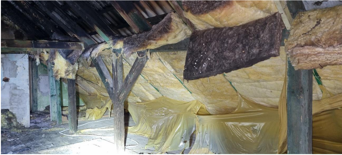
Foto 30. Widok stanu technicznego izolacji termicznej po pożarze;
