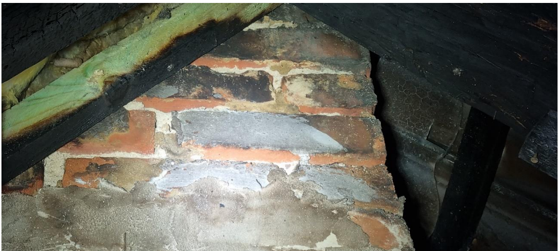
Foto 29. Widok stanu technicznego trzonu kominowego po pożarze;
