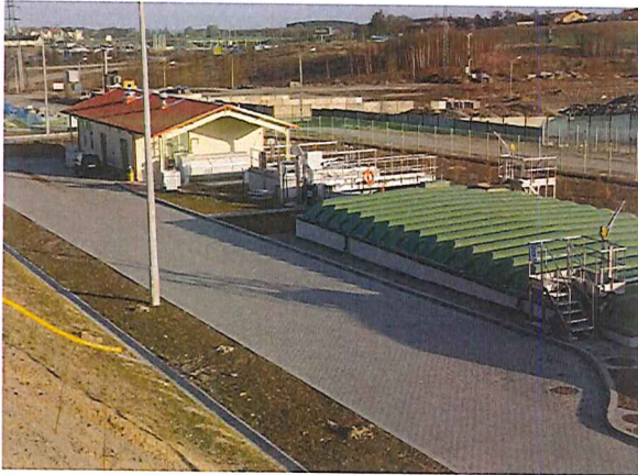
Podczyszczalnia ścieków i odcieków
