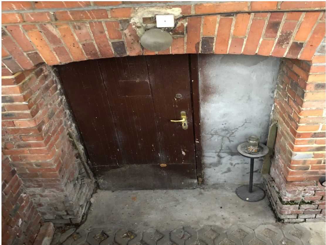
Widok na zewnętrzne drzwi do piwnicy - demontaż wraz z rozbiórką przyległej ścianki.
