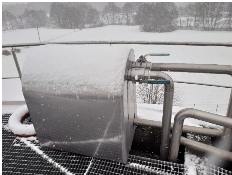
Fot. 7 Element wyposażenia systemu napowietrzania reaktora 06.
