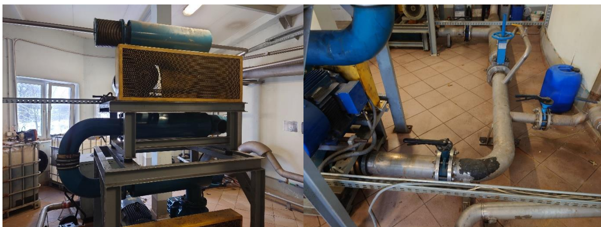
Fot. 14 Stacja dmuchaw.
