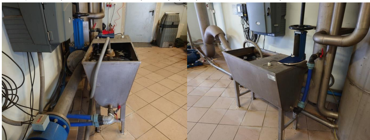
Fot. 9 Układ kontroli ścieków oczyszczonych.
