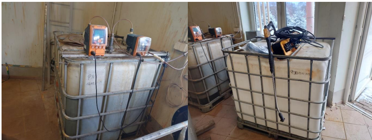
Fot. 13 Instalacja dozowania koagulantów.
