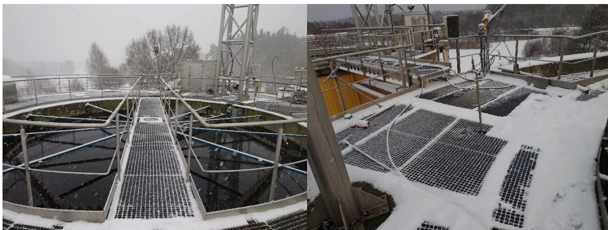
Fot. 6 Reaktory biologiczne.
