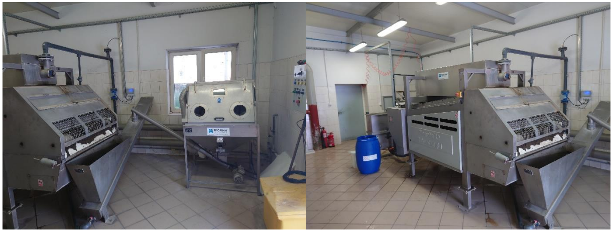
Fot. 15 Stacja odwadniania osadu.
