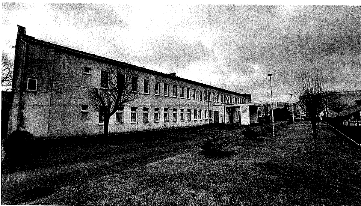
Fot. 2. Nisze – niezabezpieczone otwory wentylacyjne na elewacji północnej.
