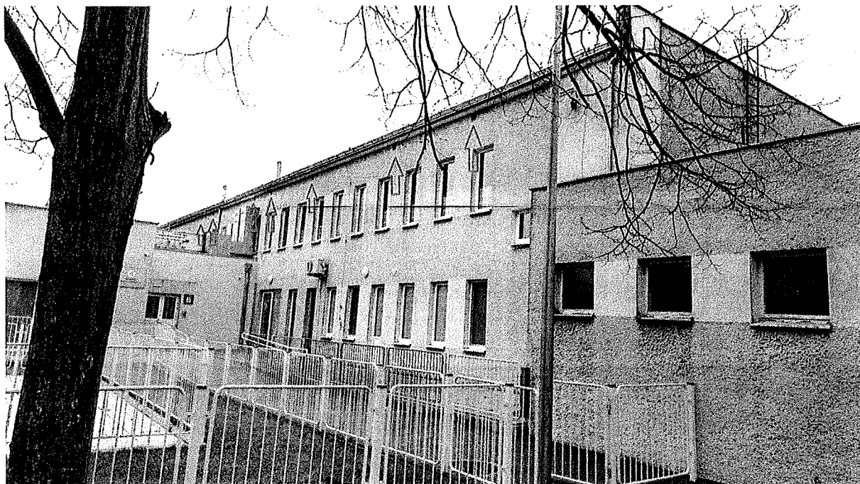
Fot. 5. Nisze – niezabezpieczone otwory wentylacyjne na elewacji południowej.
