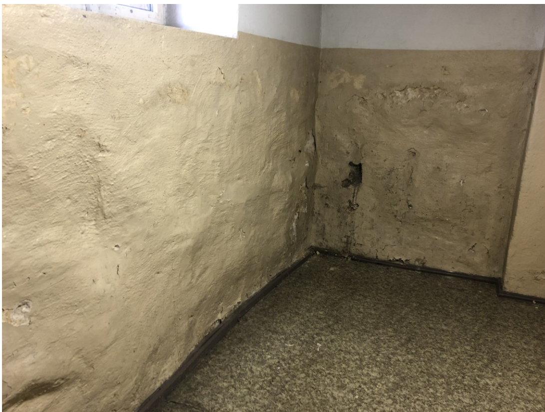
Widok - zmurszały tynk w jednym z pomieszczeń piwnicy
