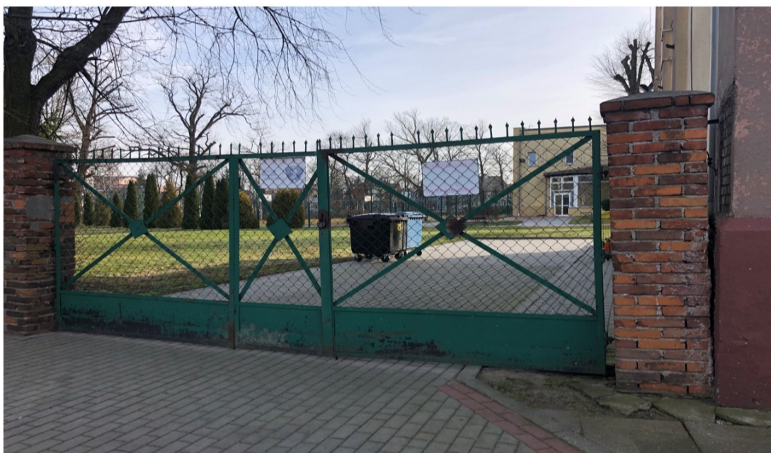
Widok na bramę. W celu wykonania izolacji fundamentów pozostawić słupek bez zmian.
