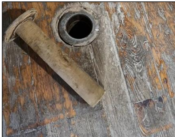
Fot. 7 Stare tuleje do słupków do siatkówki – do wymiany
