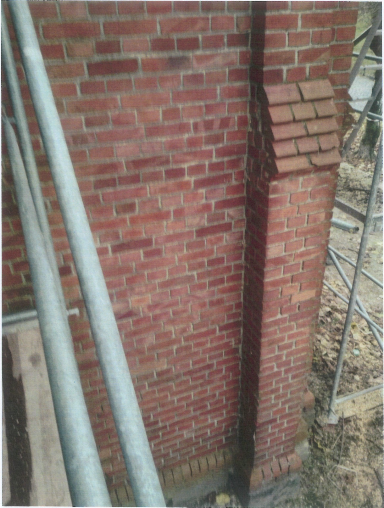
Fot. 26 (wyk. W. Tomaszewski): Widok stanu zachowania wybranego fragmentu wschodniej ściany szczytowej (od str. północnej). Wątki ceglane ścian pionowych w dobrym stanie zachowania. Całość zwarta i kompletna. Sporadycznie zdarzają się bardzo małe ubytki spoiny (szczeliny i odpryski).
