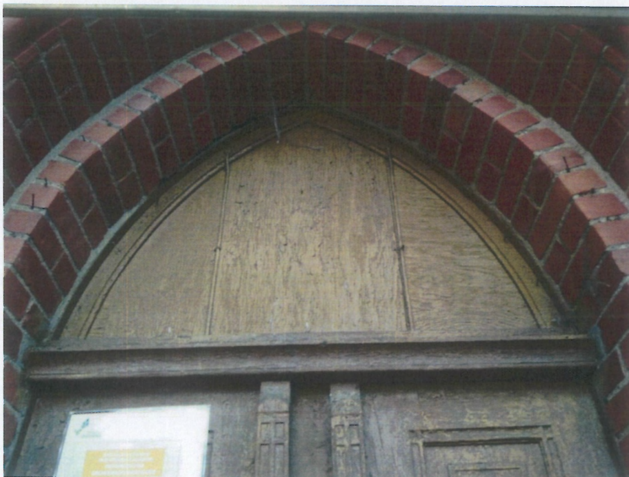
Fot. 63(wyk. W. Tomaszewski): Widok naświetla z prowizorycznym zaślepieniem sklejką drewnianą.
