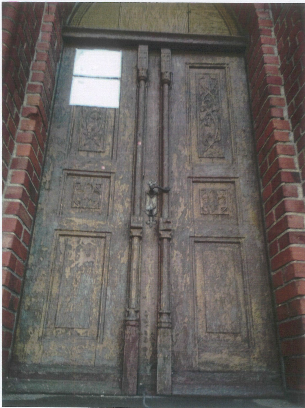
Fot.61 (wyk. W. Tomaszewski): Widok głównych drzwi wejściowych do cerkwi od strony zewnętrznej. Kompozycja oryginalnych dekoracji stolarsko – snycerskich jest kompletna. Całość powierzchni pokrywają resztki dwóch warstw farby olejnej, które łuszczą się i stale odspajają od podłoża drewnianego. Otwór naświetla jest pozbawiony przeszklenia. Obecnie prowizorycznie zaślepiony sklejką drewnianą.
