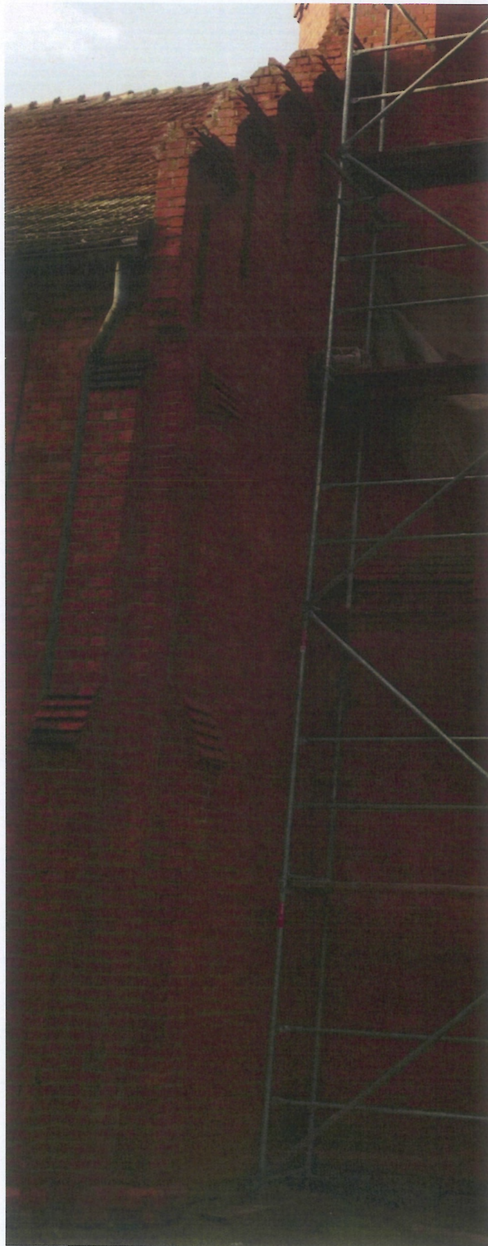
Fot. 14 (wyk. W. Tomaszewski): Ogólny widok stanu zachowania ściany szczytowej – od strony południowej.
