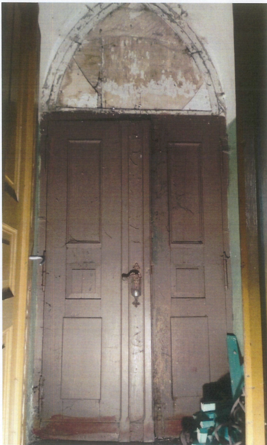
Fot. 62 (wyk. W. Tomaszewski): Widok głównych drzwi wejściowych do cerkwi od strony wnętrza (kruchty). Oryginalna kompozycja stolarska jest kompletna. Całość powierzchni pokrywają dwie warstwy farby olejnej, które mocno przylegają do podłoża drewnianego. Otwór naświetla jest pozbawiony przeszklenia. Obecnie prowizorycznie zaślepiony drewnianą sklejką.
