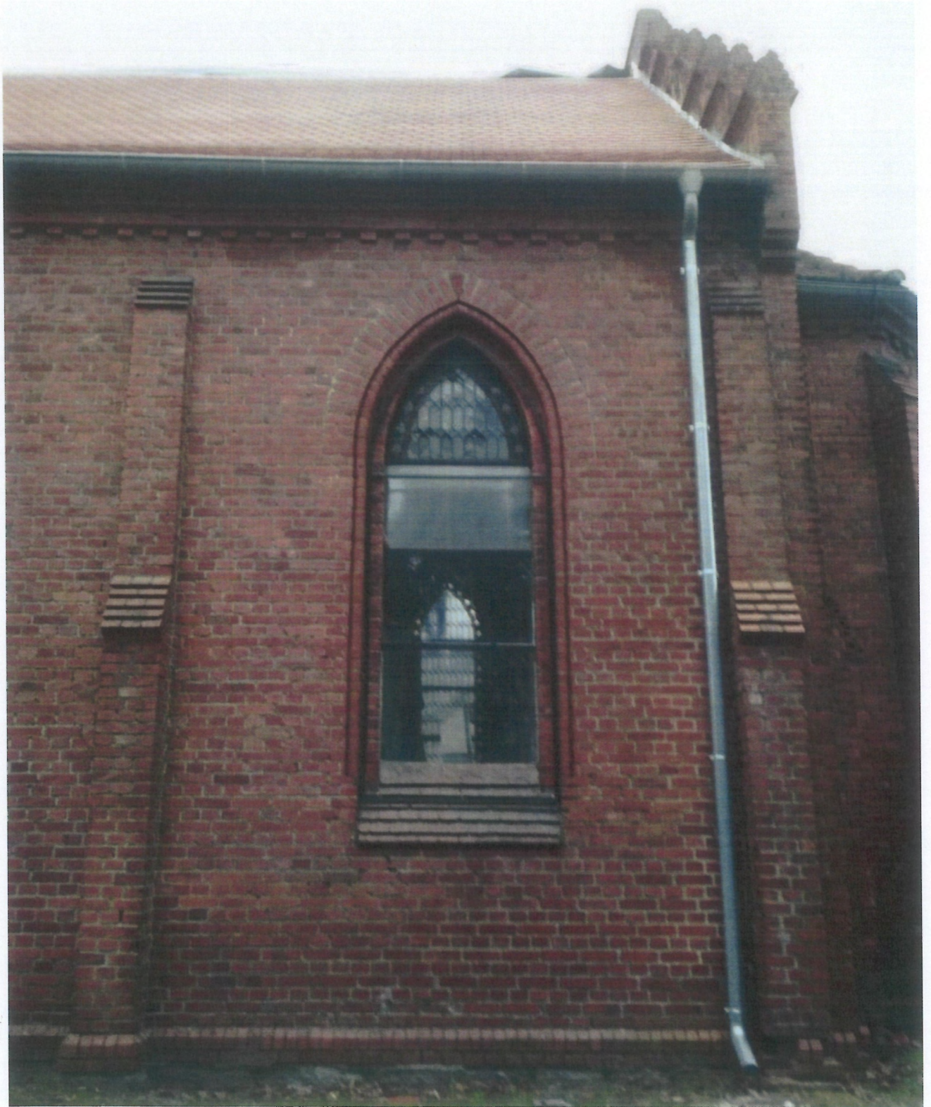
Fot. 49 (wyk. W. Tomaszewski): Ogólny widok stanu zachowania prawego przęsła elewacji północnej.
