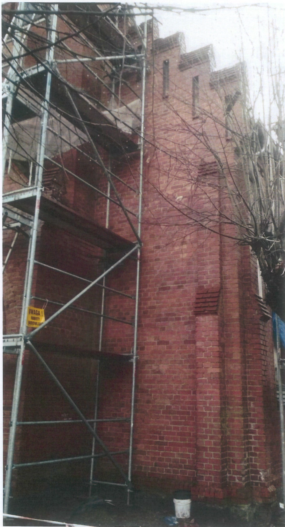
Fot. 21 (wyk. W. Tomaszewski): Ogólny widok stanu zachowania wschodniej ściany szczytowej (od strony północnej).
