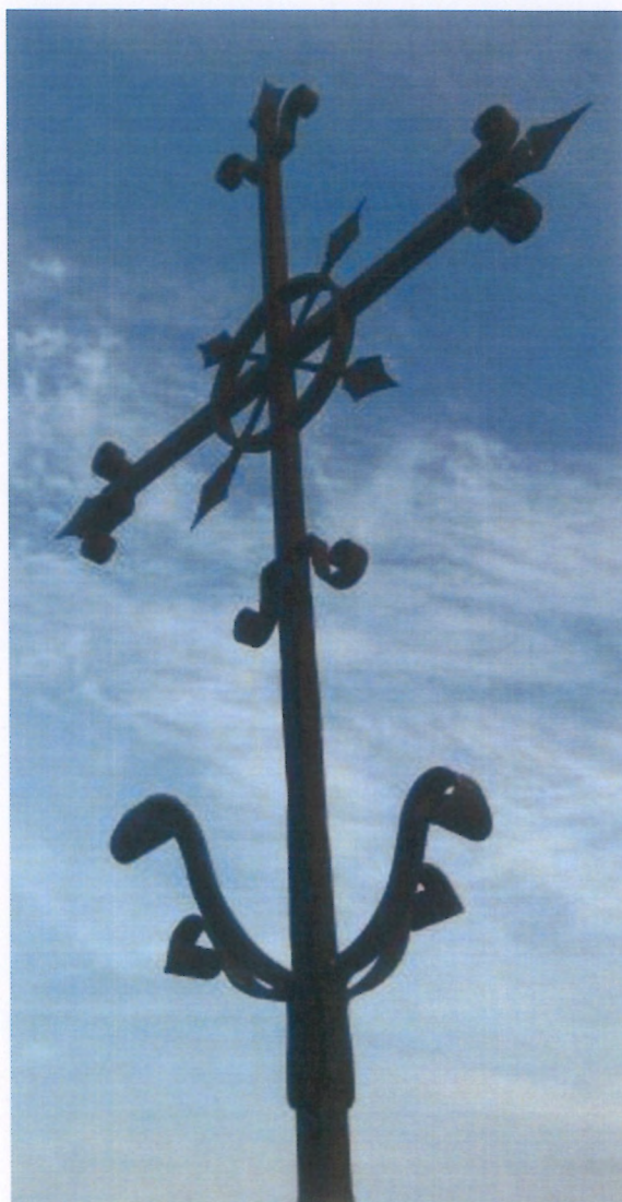
Fot. 1 (wyk. W. Tomaszewski): Hełm wieży kościoła wieńczy stalowy krzyż osadzony na stalowej półkuli. Powierzchnia krzyża jest pokryta cienką warstwą tlenków żelaza (pasywacja).
