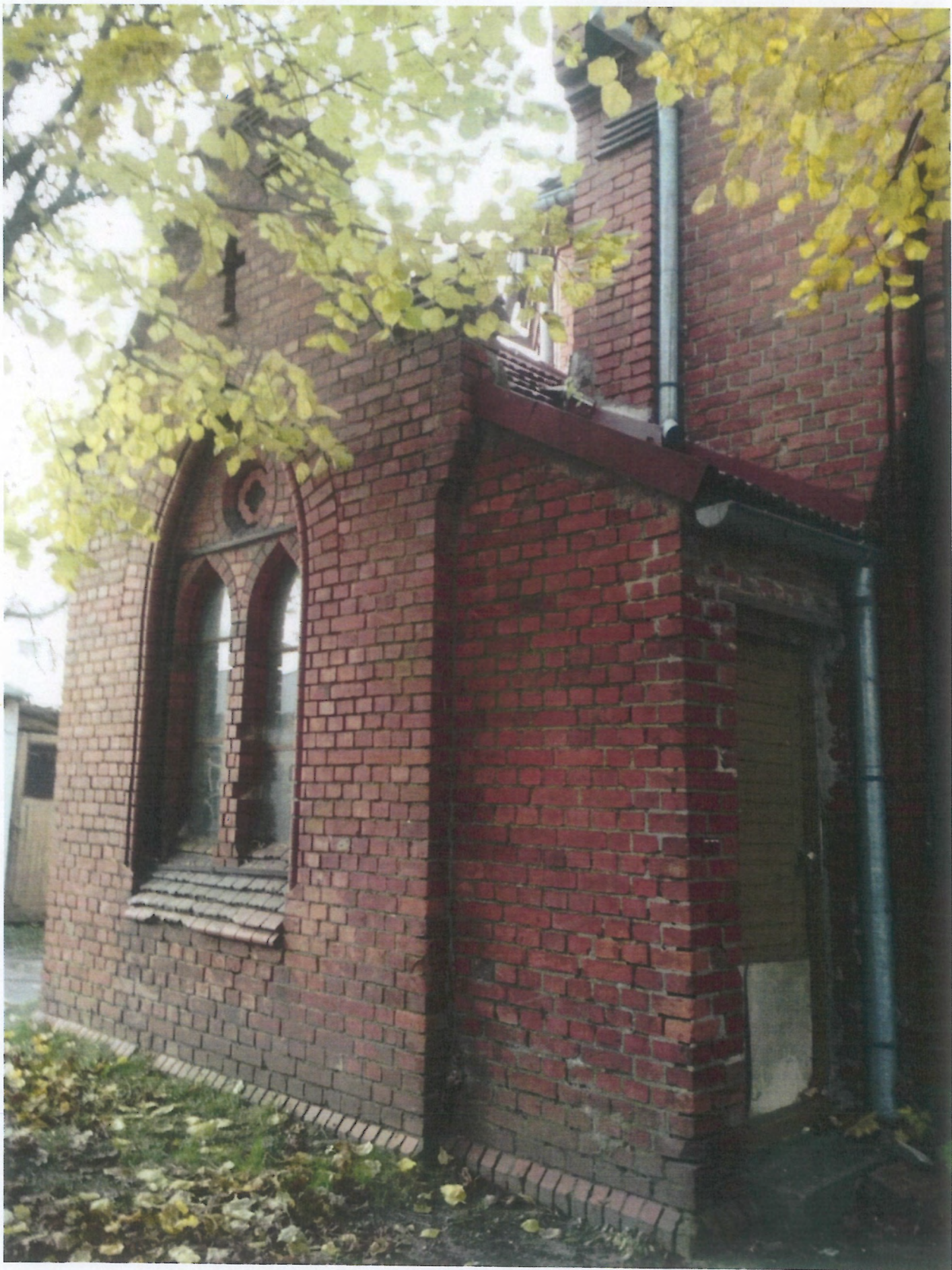
Fot. 37 (wyk. W. Tomaszewski): Widok stanu zachowania zakrystii. Zauważa się utracenia narożników cegieł, ubytki odcinków zwietrzałych i wypłukanych spoin. Spotyka się braki pojedynczych cegieł oraz kształtek ceramicznych. Szkliwione kształtki ułożone na parapetach mają poutrącone krawędzie oraz powierzchniowe odpryski i zmatowienia szkliva.
