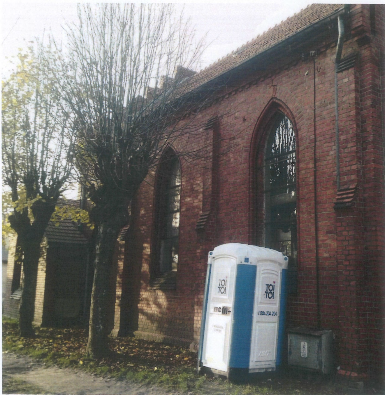
Fot. 34 (wyk. W. Tomaszewski): Ogólny widok stanu zachowania elewacji południowej.
