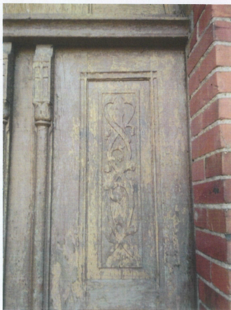
Fot. 64 (wyk. W. Tomaszewski): Widok stanu zachowania fragmentu kompozycji stolarsko – snycerskiej.
