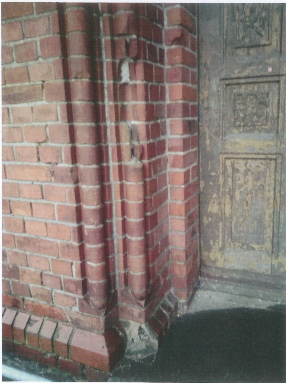
Fot. 33 (wyk. W. Tomaszewski): Widok istotnych ubytków wałka na odcinku kilku kształtek ceramicznych oraz ubytku kształt ceramicznej u podstawy. Są to ubytki natury mechanicznej.
