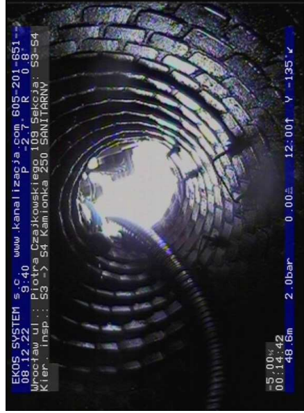
S3-S4-foto_nr-013.jpg, 00:14:42, 48.61 m Wążół końcowy. Studzienka wiazowa, S4, stopnie do wymiany
